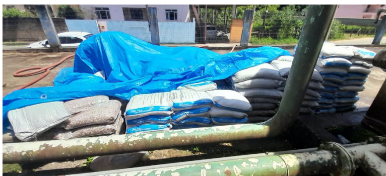
NÃO CONFORMIDADE FOTO 3 Disposição de material e tubos diretamente no chão e restos de bombonas e caixas ao longo do terreno da ETA, riscos de animais peçonhentos
