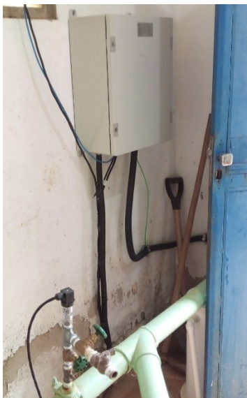
Painel do CCO/ medidor de vazão
