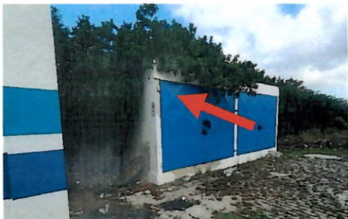
NÃO CONFORMIDADE FOTO 3 Entulho nos arredores dos prédios.
