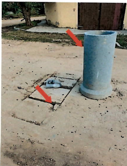
FOTO 6 NÃO CONFORMIDADE Tampa do barrilete quebrada.
