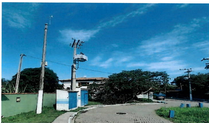
FOTO 1 NÃO CONFORMIDADE Não há placa de identificação geral.
