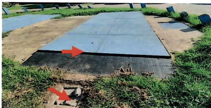
FOTO 2 NÃO CONFORMIDADE Tampas do poço de sucção com fechamento inadequado.
