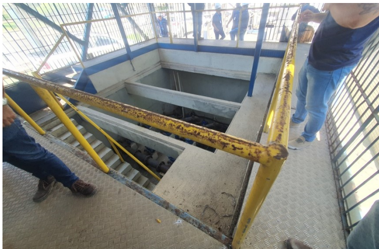
FOTO 6 NÃO CONFORMIDADE Diversos pontos de corrosão
