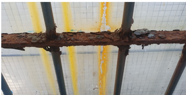
FOTO 7 NÃO CONFORMIDADE Estágio avançado de corrosão
