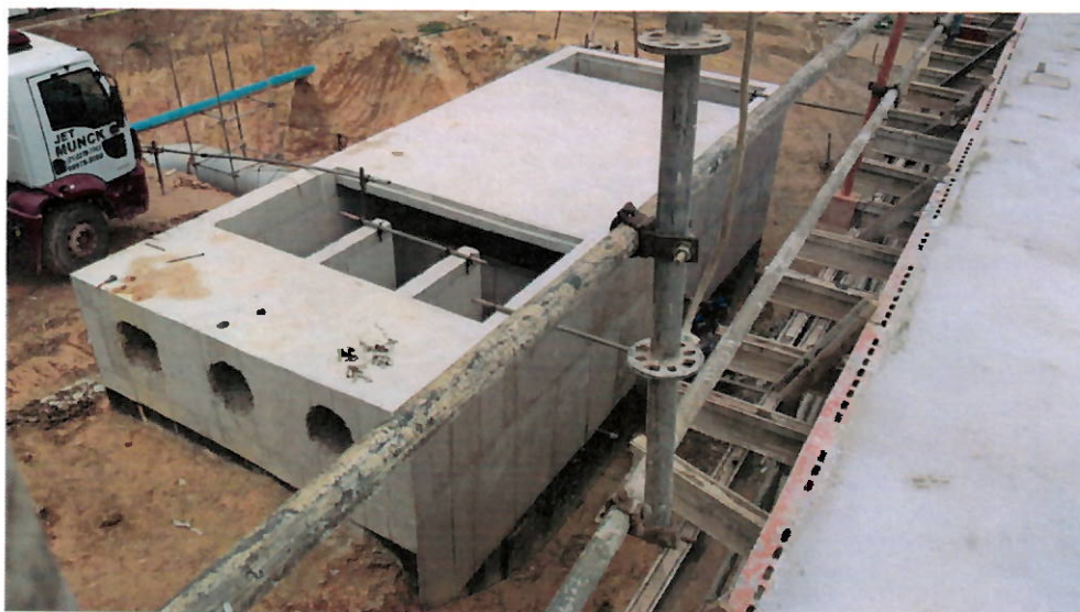
FOTO 4 – Reservatório 5 de água de lavagem para os filtros novos
