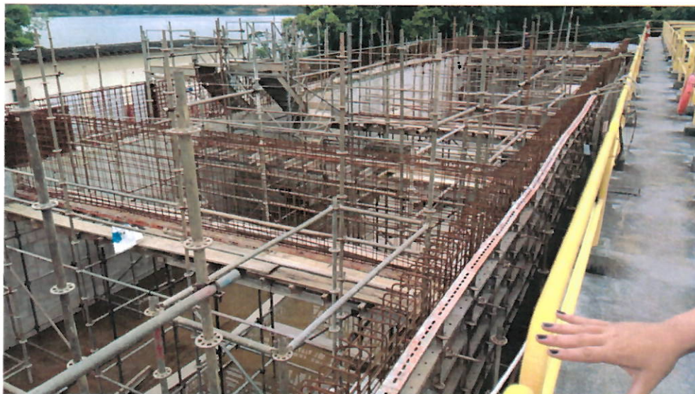
FOTO 4 - Flocculadores e decantadores
