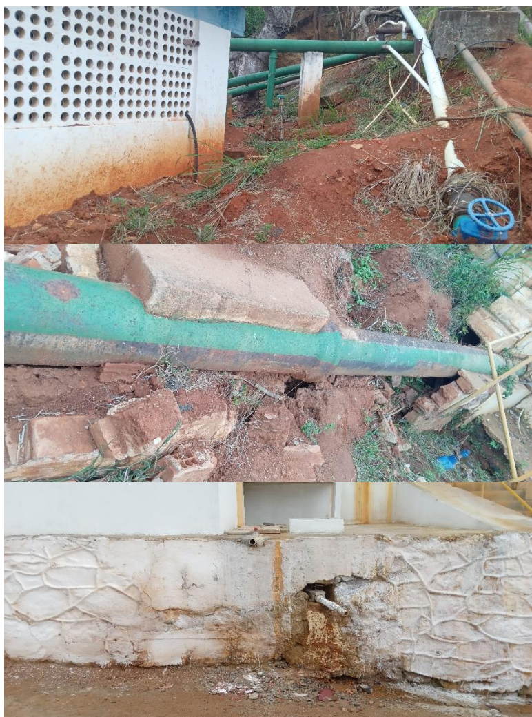
FOTO 27 NÃO CONFORMIDADE Muitos materiais no pátio e estruturas deterioradas
