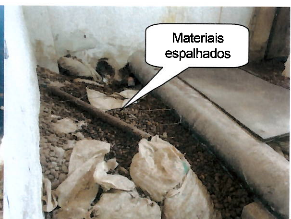
Sala de manobra de filtros
