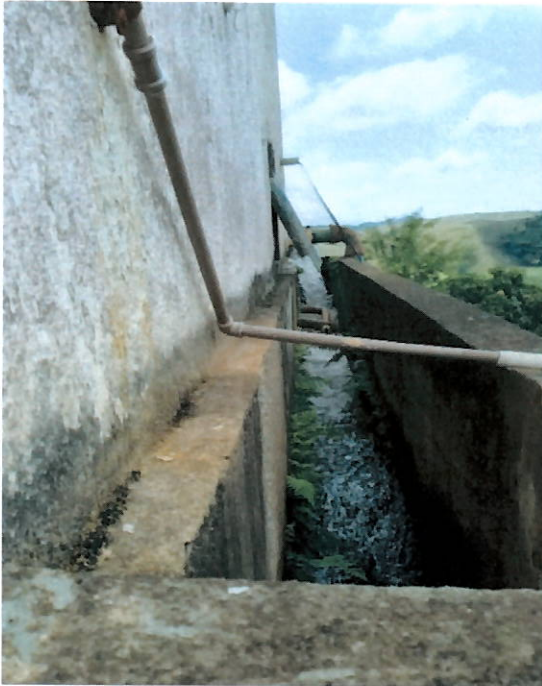
Entrada da água bruta
