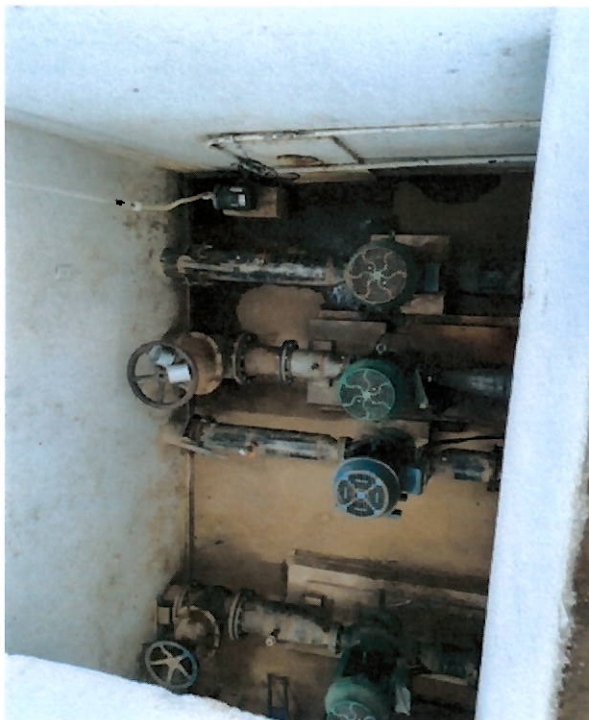
Casa de bombas
