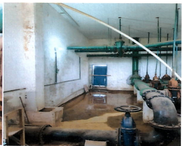
Sala de manobra de filtros
