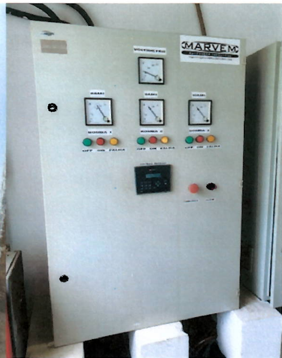
Painel de comando dos motores
