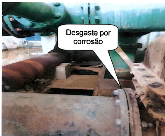
Tubulação e registros dos filtros
