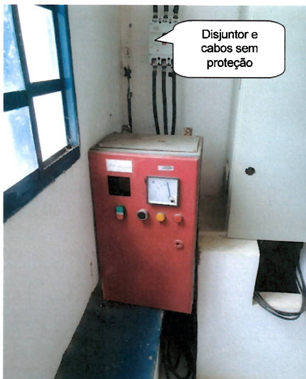
Painel de comando
