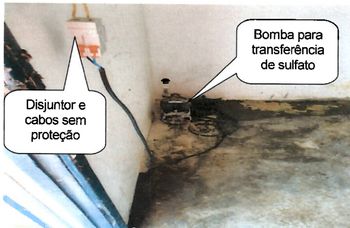
Sistema para recalque de produto químico
