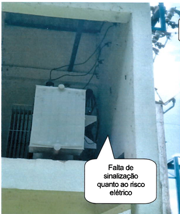
Transformador 13,8KV /220 V
