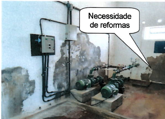
Bombas do sistema de lavagem de filtro
