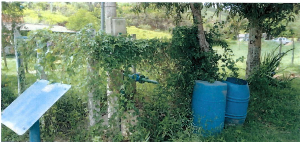
Sistema encontra-se sem identificação, cerca danificada, fácil acesso ao poço
