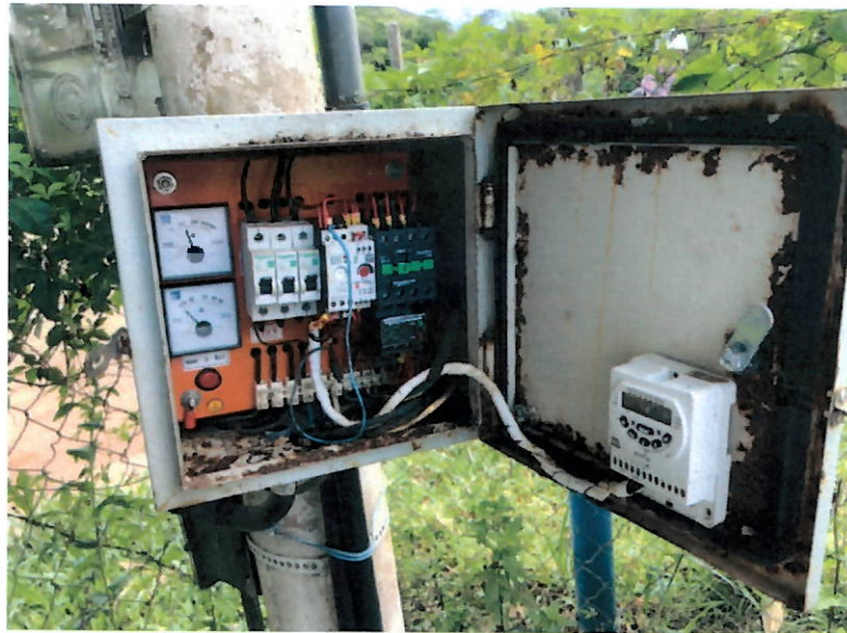
Painel apresentando pontos de corrosão
