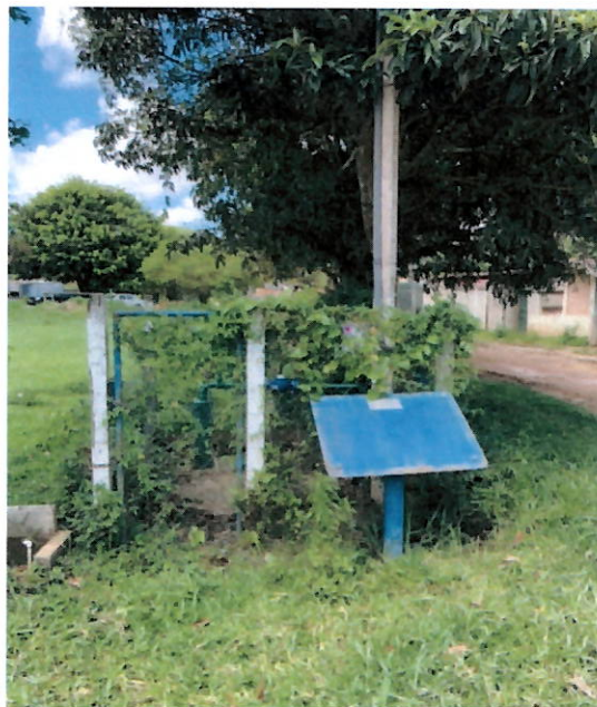
Sistema de Poço Profundo de Sanatório da Serra
