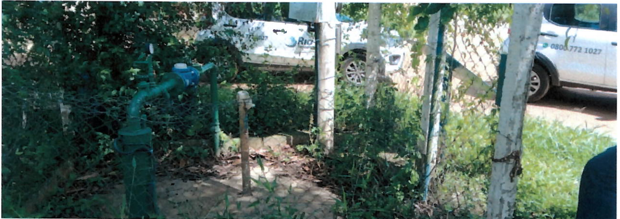
Sistema encontra-se sem identificação, cerca danificada, fácil acesso ao poço
