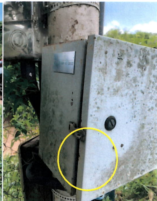
Painel de controle da bomba sem cadeado
