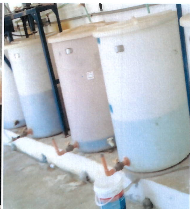
Tanques de produtos químicos sem bacia de contenção
