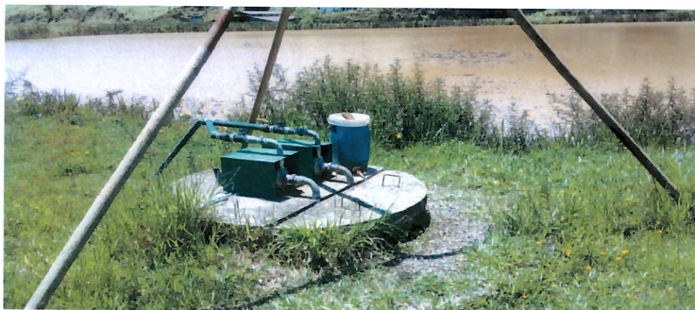
Tampa do poço de captação e bombas de água bruta
