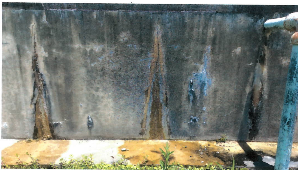
Pontos de vazamento no tanque de contato
