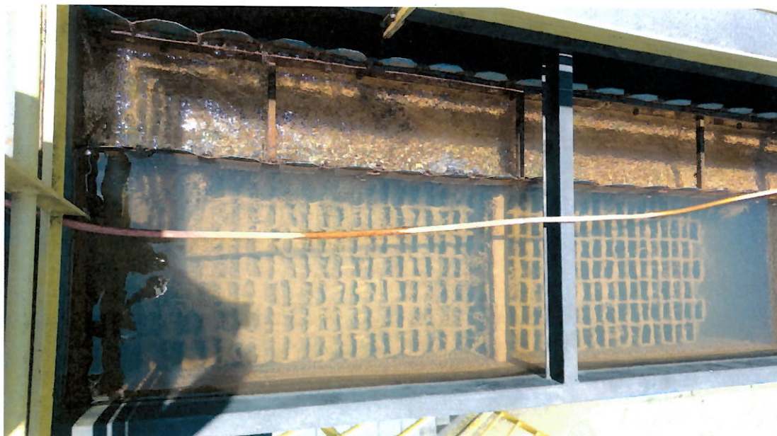
Decantador, lamelas e calha coletora
