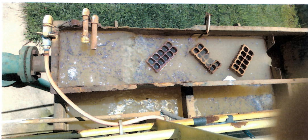
Calha de chegada da água e dosador de coagulante e vertedouro em V e medidor de vazão
