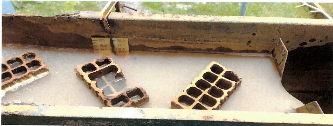
Calha de entrada com muita corrosão
