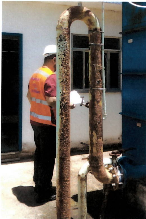
Tubo de saída da ETA excesso de corrosão
