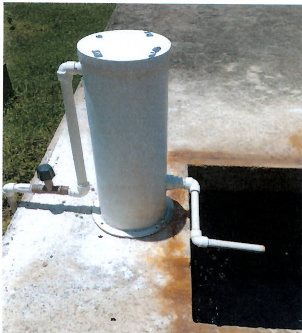
Reservatório e dosador de Cloro
