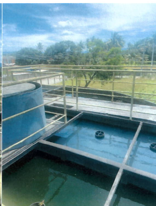
Biofiltro Submerso funcionando perfeitamente
