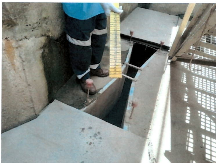
Calha Parschall de entrada onde a medição da vazão é feita com régua graduada.
