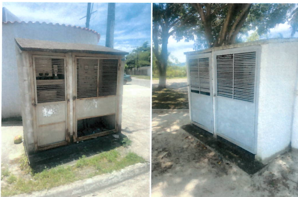
Painéis Elétricos das duas Elevatórias da Rede Coletora encontram-se desativados e precisando de reforma
