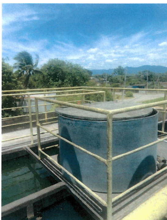
Caixa de Distribuição e guarda-corpos de segurança em cima do Reator, apresentam pontos de corrosão
