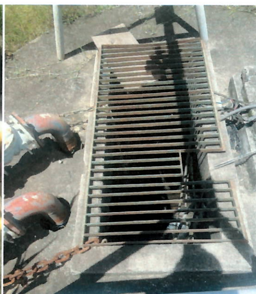
Elevatória da ETE (composta por duas bombas submersas com funcionamento automático)
