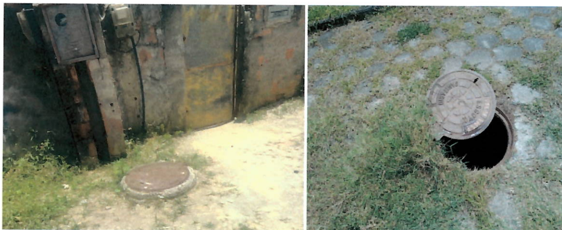
Poço de Visita na entrada da ETE precisando de restauração.
