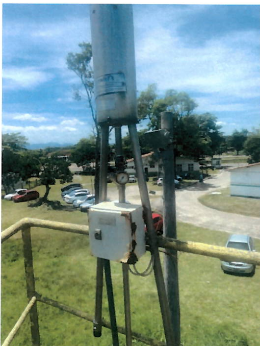
Sistema automático de queima de gases em cima do Reator (encontra-se com defeito)
