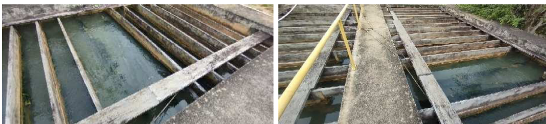
Chicanas com placas danificadas
