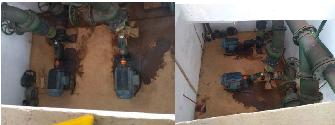
Conjuntos Motor-Bomba apresentando vazamento
