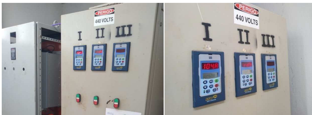
Quadro de Comando dos Conjuntos Motor-Bomba Dois em Operação e um Reserva
