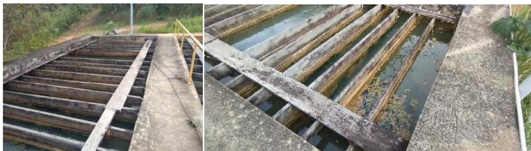
Chicanas com placas danificadas
