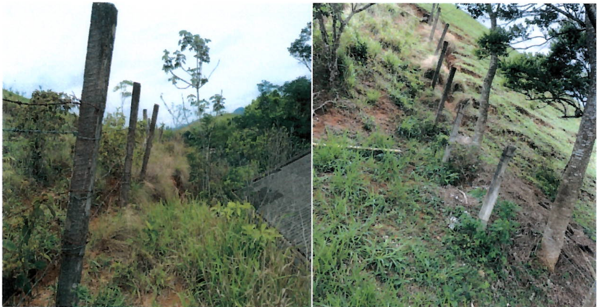
Cercas do reservatório precisando de manutenção
