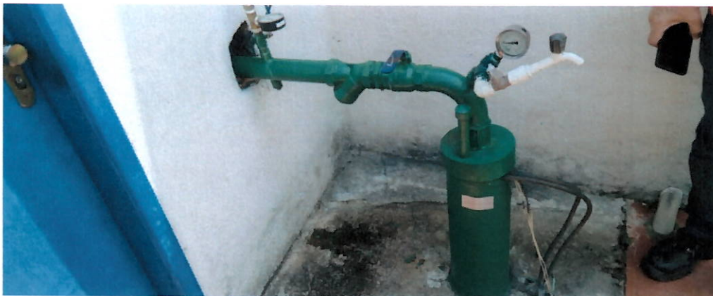
Calha Parshall e dosador de PAC
