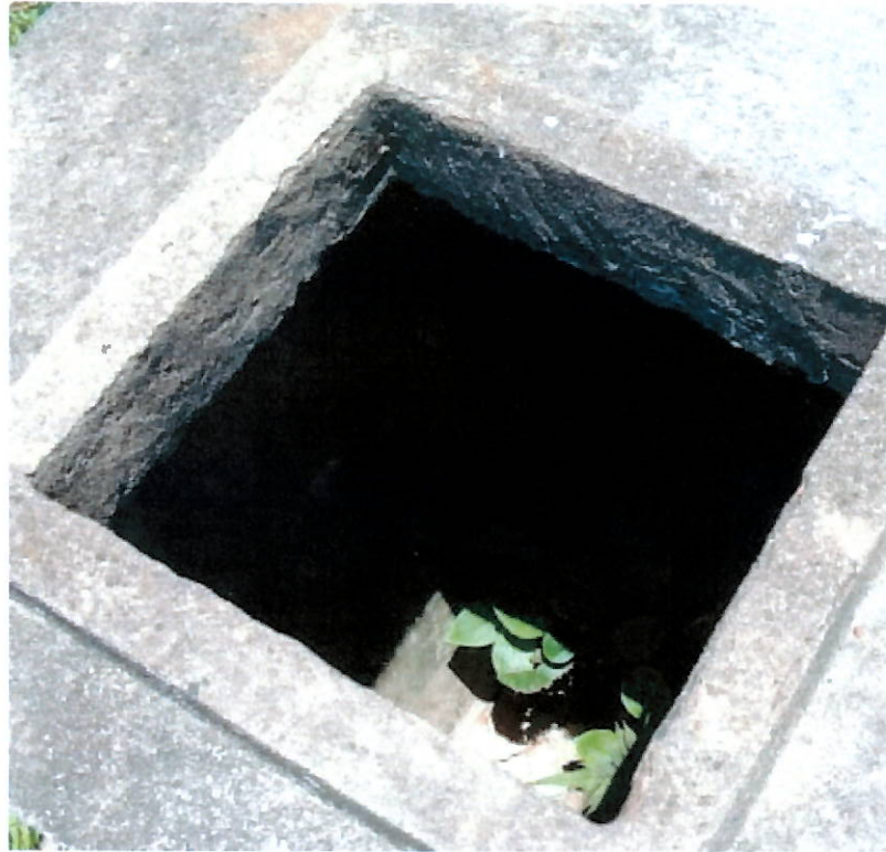
Válvula sem tampa de proteção
