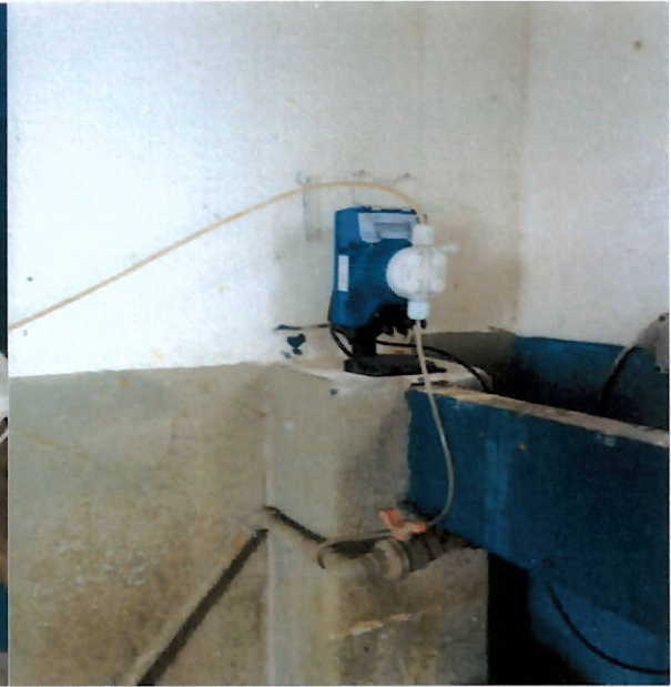
Dosadora de Sulfato de Alumínio
