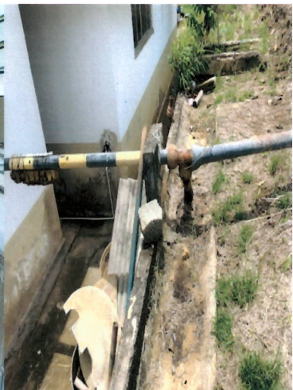
Tubulação de recalque de água tratada
