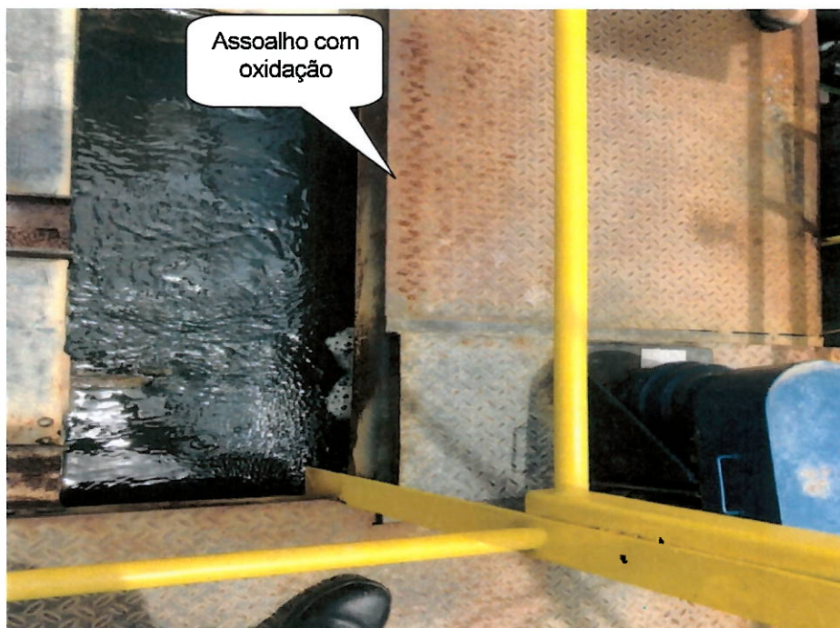
Tanque de Floculação
