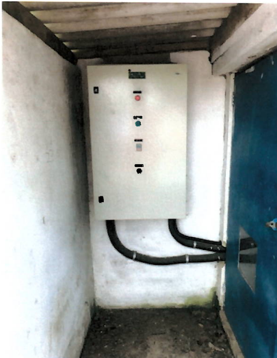
Painel de comando da EEAB
