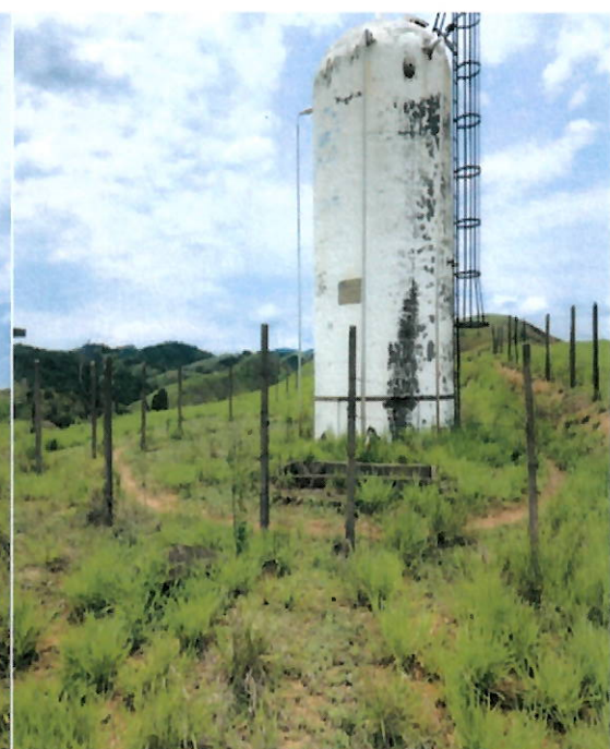
Reservatório de fibra – 75m 3
