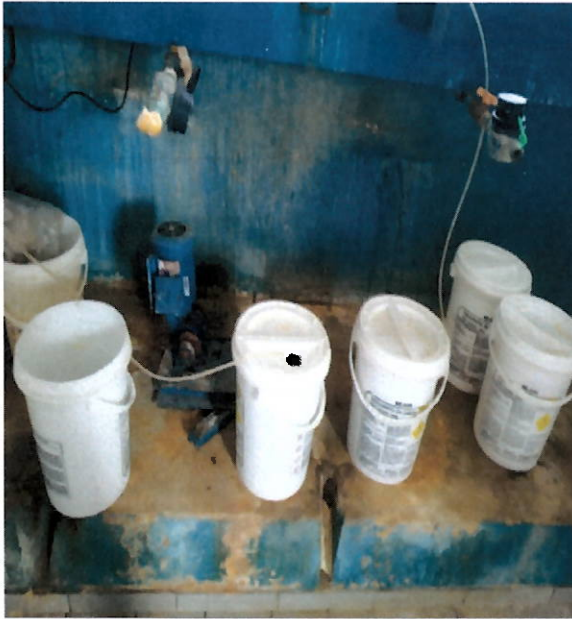
Armazenamento improvisado de sulfato de alumínio
