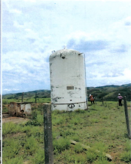
Trecho de cerca sem arame
