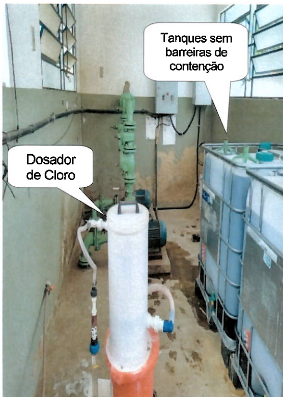
Produtos químicos armazenados próximos à motobomba e painel elétrico
