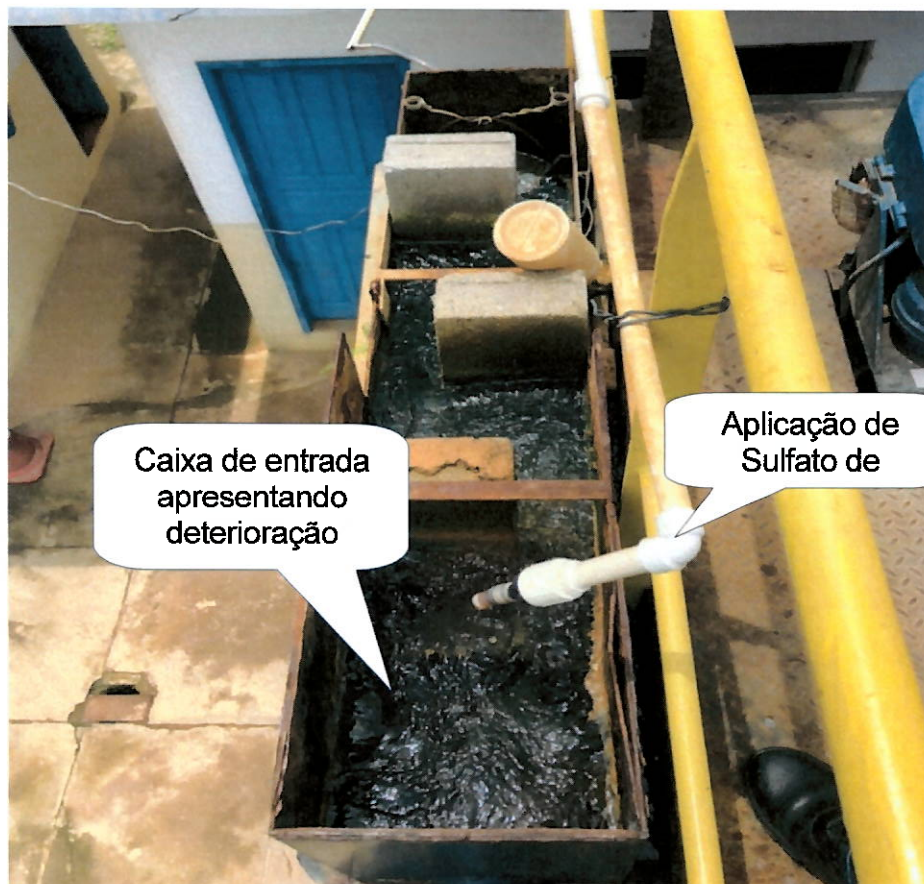
Entrada de água bruta - Calha Parshall
