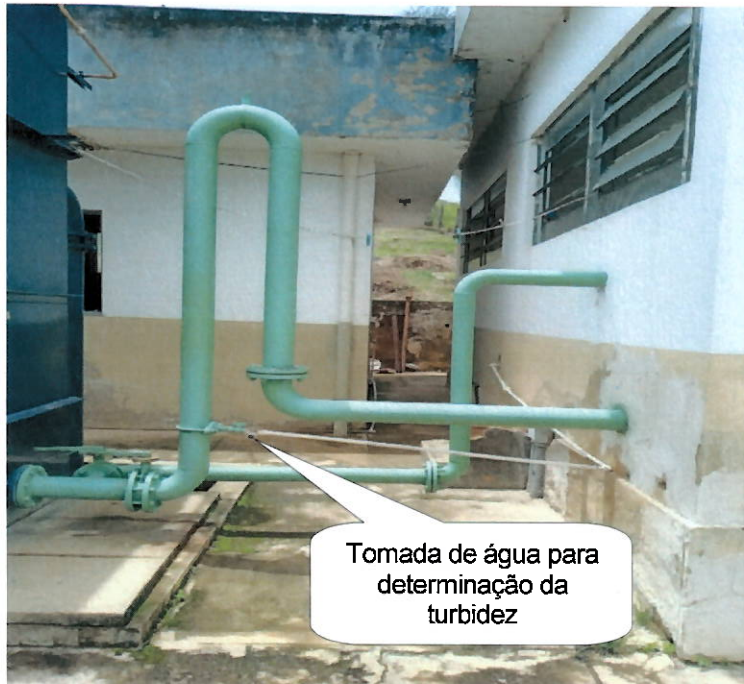
Tubulação de saída do filtro e retrolavagem
