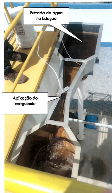
Calha Parshall para leitura da vazão e aplicação do coagulante
