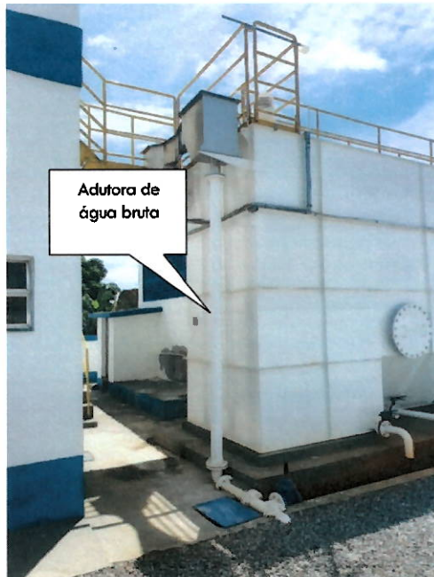
Chegada da água na Estação
