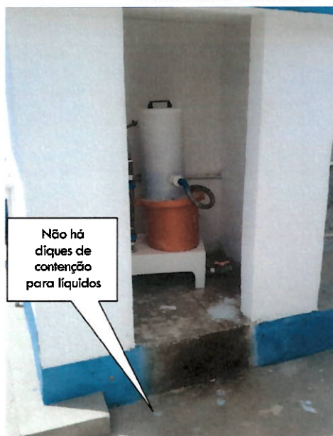
Casa de desinfecção (Hipoclorito de Cálcio)
