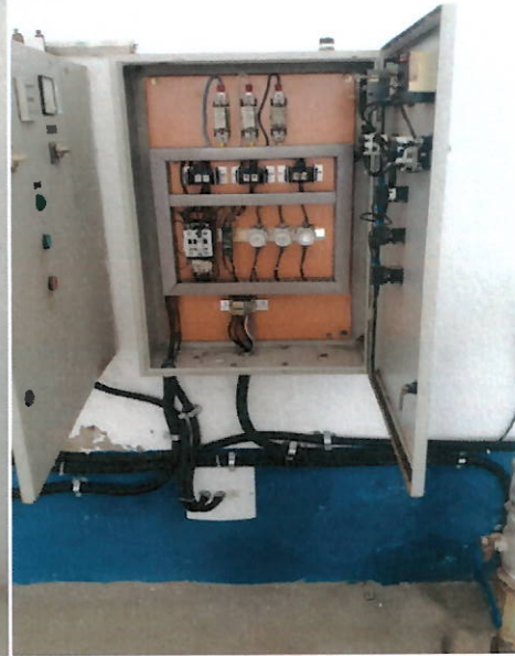
Quadro de comandos da ETA
