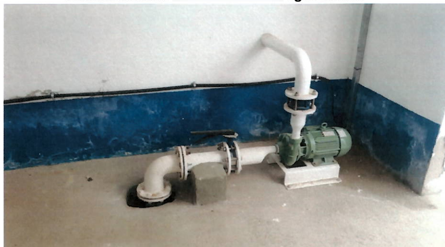
Bomba de retrolavagem dos Filtros
