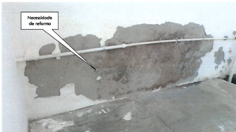
Parede descascada da Fachada interior
