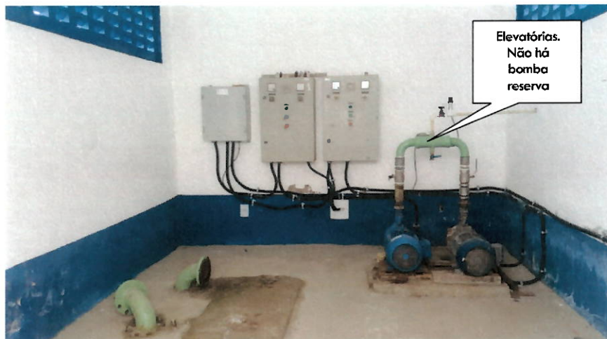
Casa de bombas das Elevatórias de água tratada
