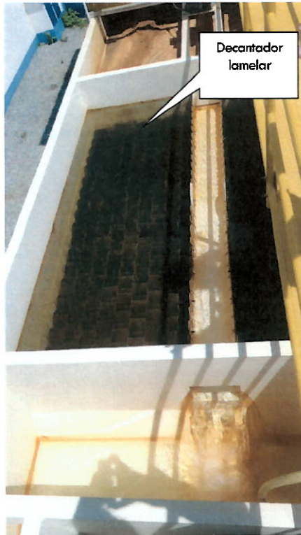
Tanque de Decantador
