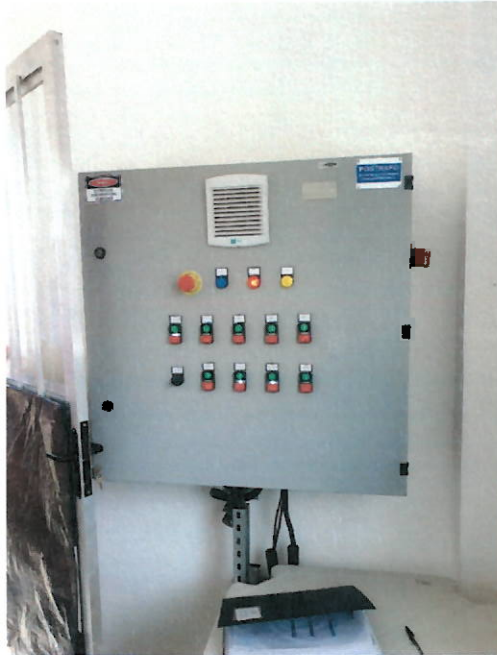
Quadro de comandos das Elevatórias
