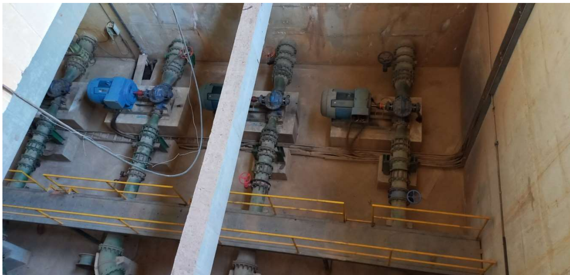
Fotografia 4 – Equipamentos motor-bomba do sistema de recalque de água bruta
