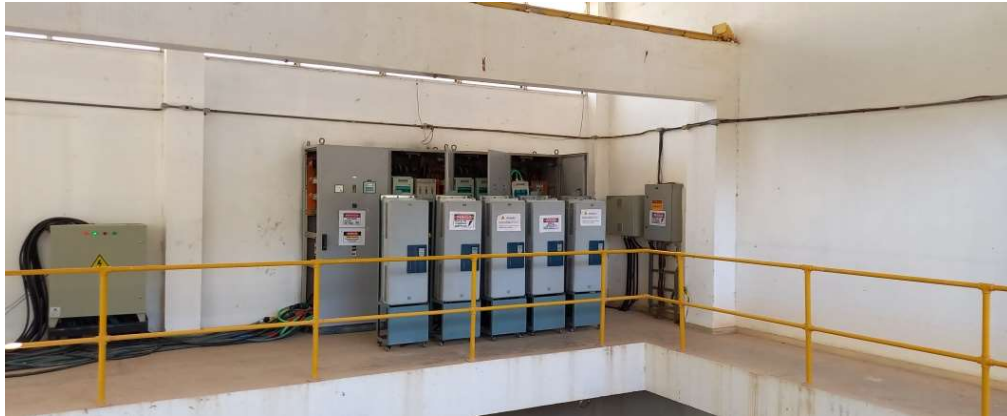
Fotografia 27 – Painelelétrico de Comando das Bombas
