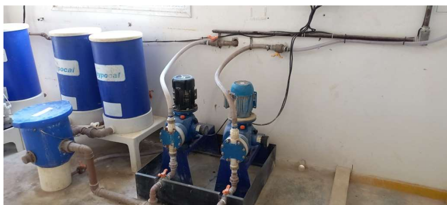
Fotografias 38 – Dosadores de cal
