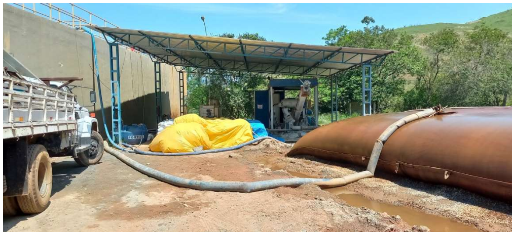
Fotografia 26 – Bags de armazenamento de lodo
