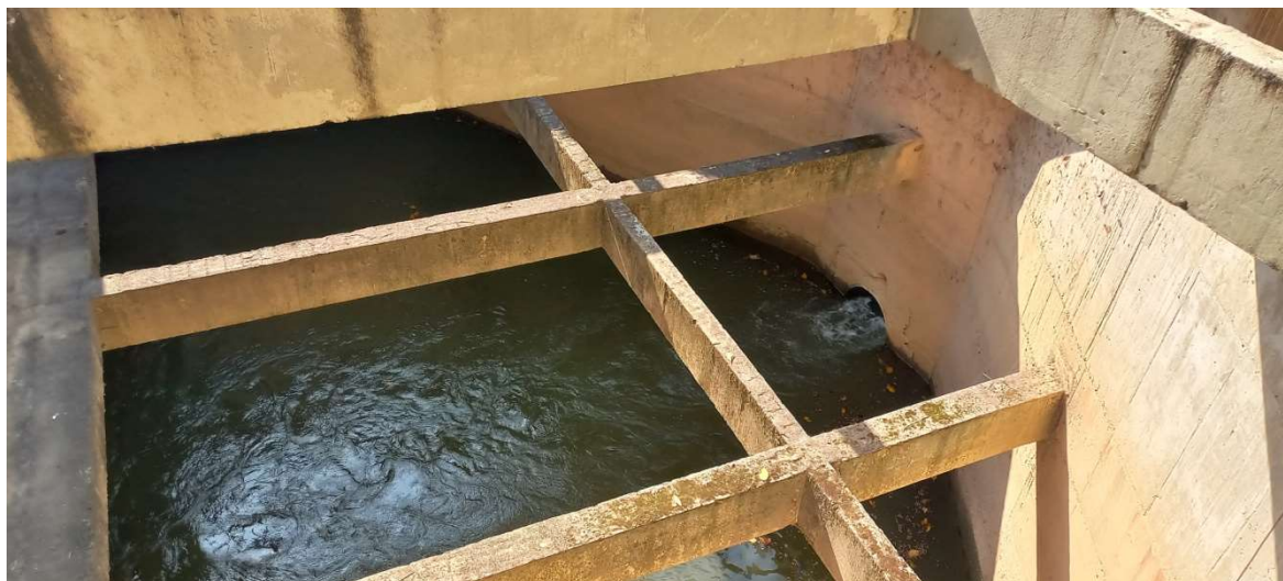
Fotografia 3 – Reservatório de água bruta
