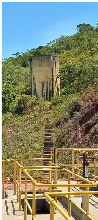
Fotografia 22 – Reservatório de água de lavagem de filtros
