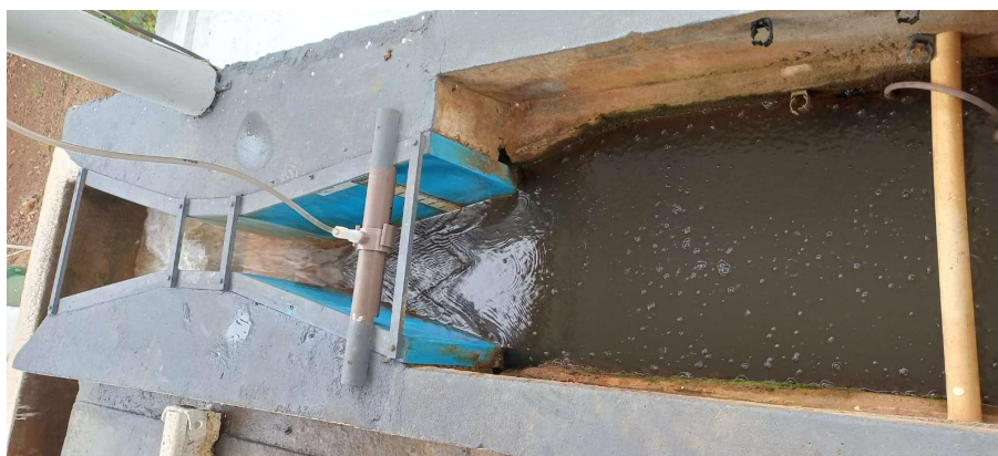
Calha Parshall e dosador de PAC
