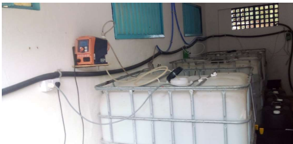
Reservatório e dosador de Cloro e Fluor.
