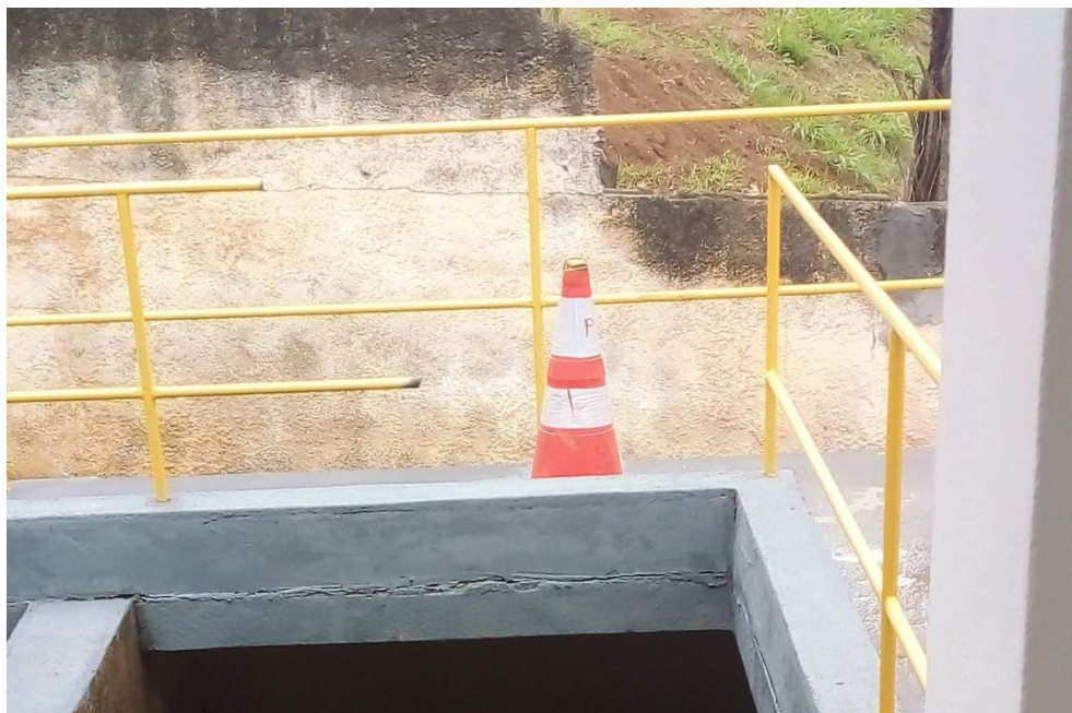
Falta de trecho do guarda corpo
