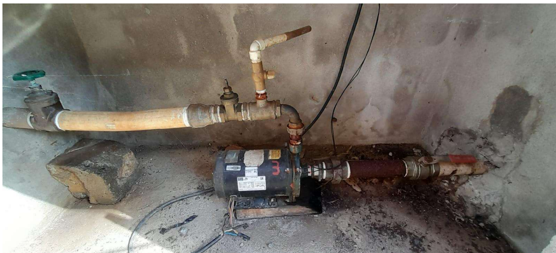
Casa da bomba do booster Ernesto Glória.
