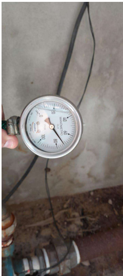
Pressão aferida com a bomba ligada do booster Ernesto Glória.
