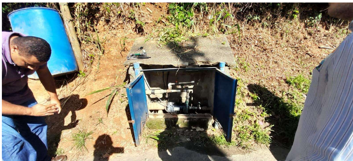
Casa da bomba do booster Grijó Filho.
