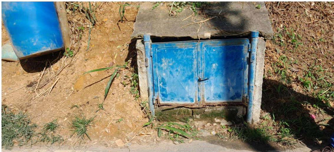
Necessidade de reforma da casa da bomba do booster Grijó Filho.
