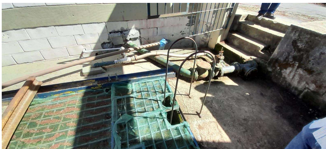
Tela de proteção do poço de sucção da captação da ETA Rio Claro.
