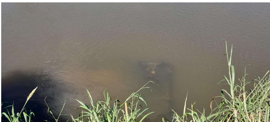
Tubulação de sucção da motobomba.
