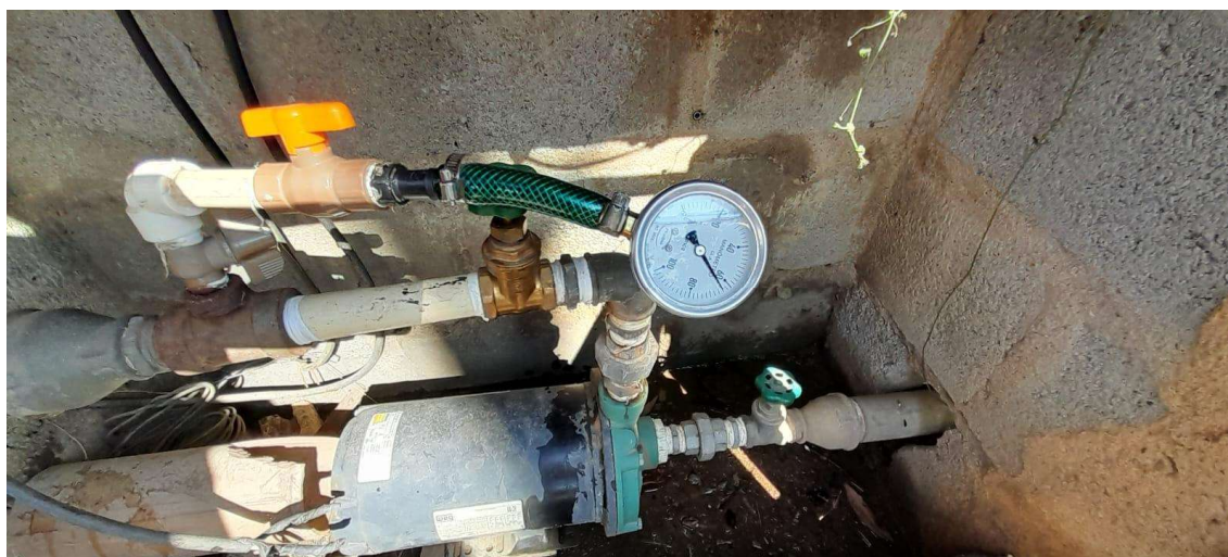
Pressão aferida com a bomba desligada do booster Grijó Filho.
