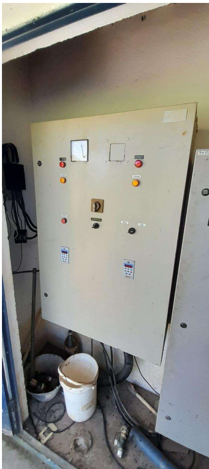
Painel elétrico das bombas com entulhos.
