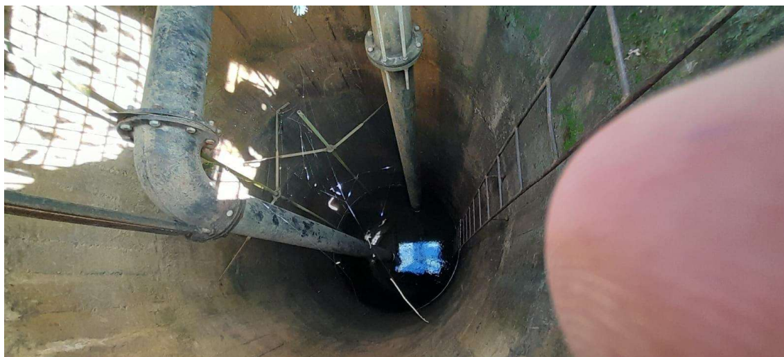
Tubulações de sucção da captação da ETA Rio Claro.
