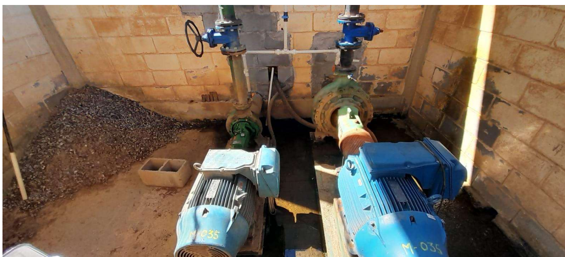
Bombas de recalque da captação da ETA Rio Claro (1+1).
