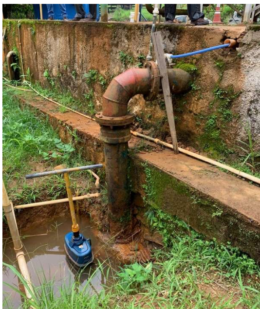
Entrada de água bruta
