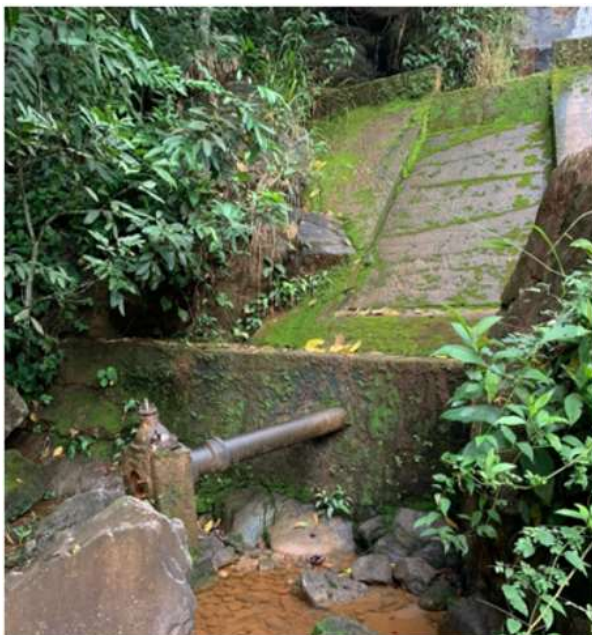
Tubulação de Descarga
