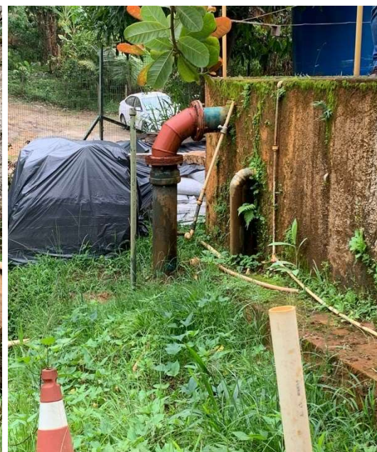
Saída de água tratada
