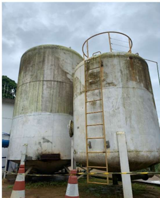
ETA Compacta Pressurizada
