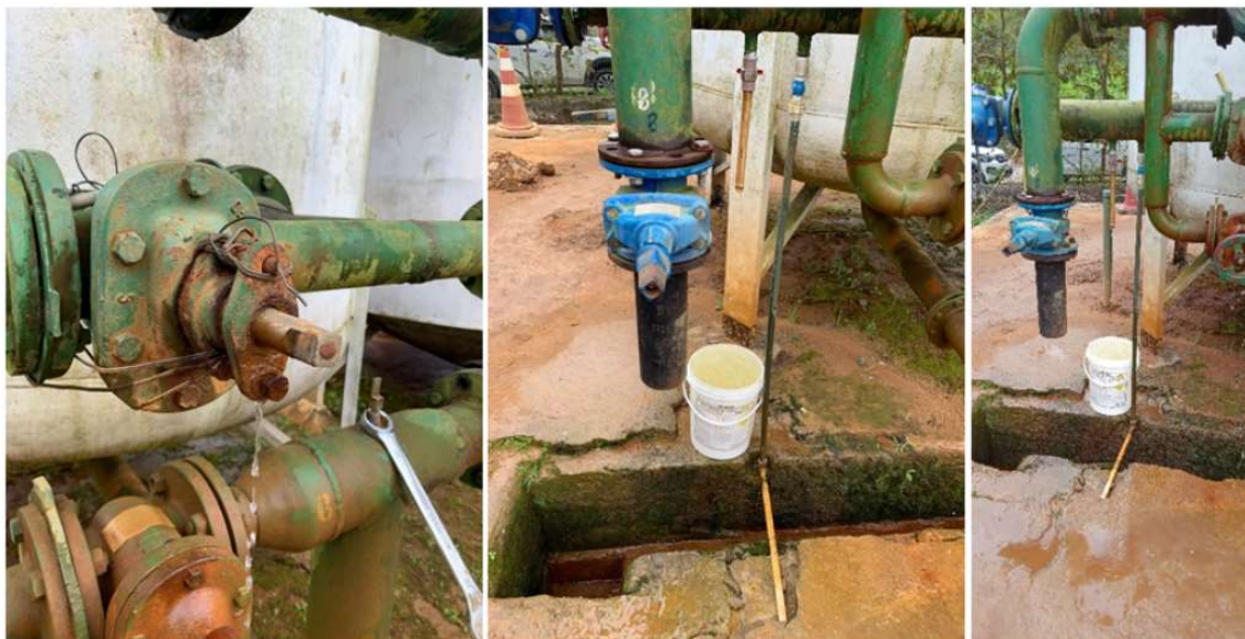
Vazamentos nas tubulações
