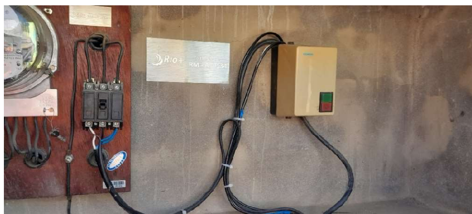
Chave de Partida Direta / Medidor Elétrico
