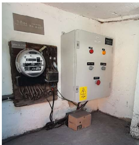
Medidor de Energia /Painel C.C.O/ chave de partida direta
