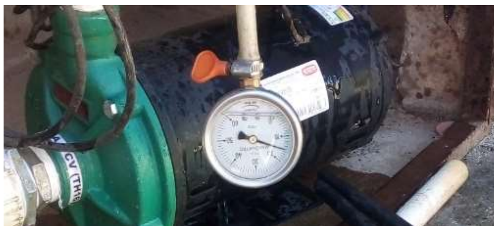
Pressão de Recalque
