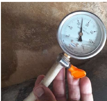
Pressão de Recalque
