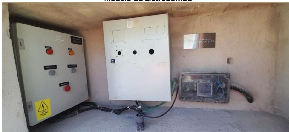
painel do C.C.O/ Chave de Partida Elétrica
