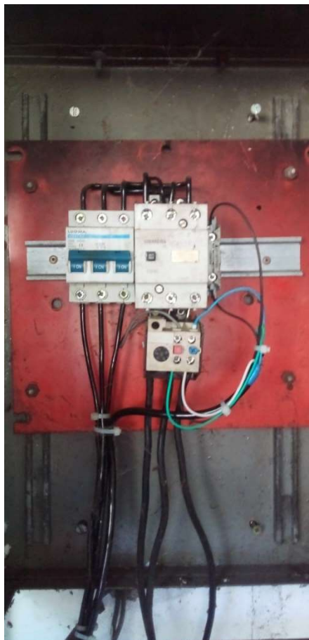
Painel Elétrico Partida Direta
