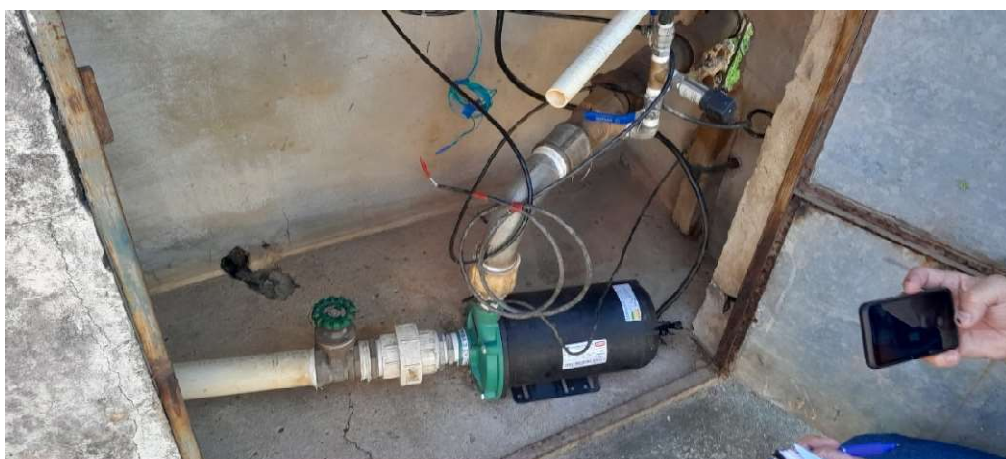
Eletrobomba Santa Luzia
