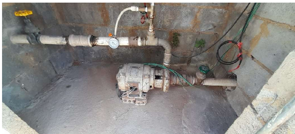
Elettrobomba Mario Índio
