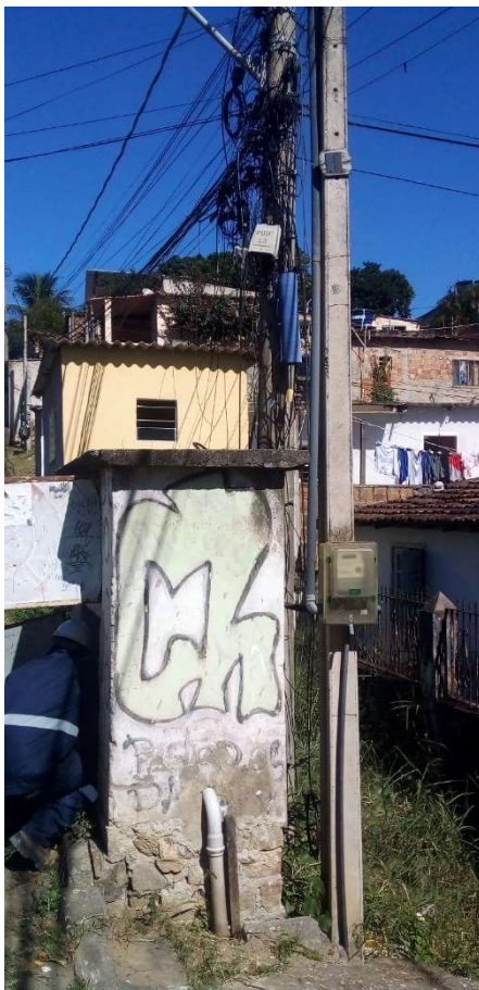
Medidor de Energia
