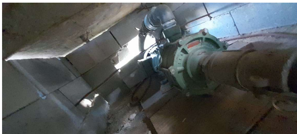
Eletrobomba Ponte Coberta
