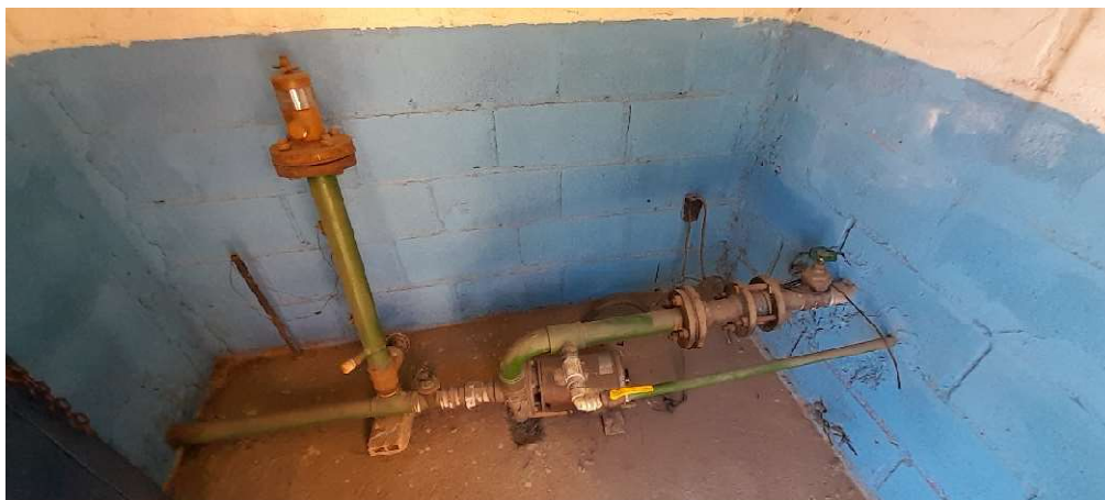
Eletrobomba Booster do Colégio
