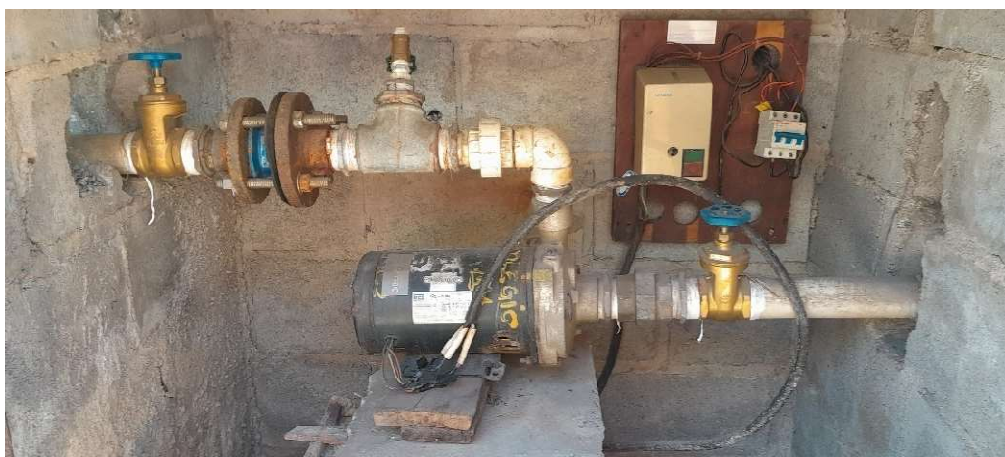
Eletrobomba Tancredo Neves
