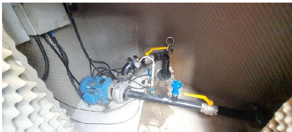
Eletrobomba do Booster Assembleia
