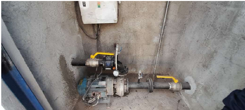
Eletrobomba Bom Jardim
