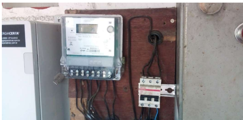
Medidor de Energia
