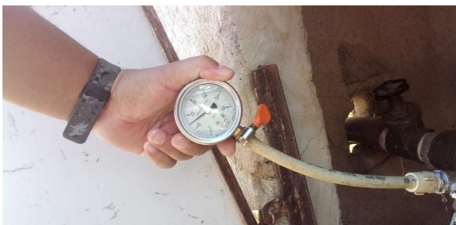
Pressão de Recalque
