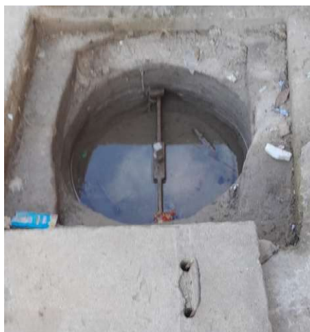
Tampa de acesso com vedação
