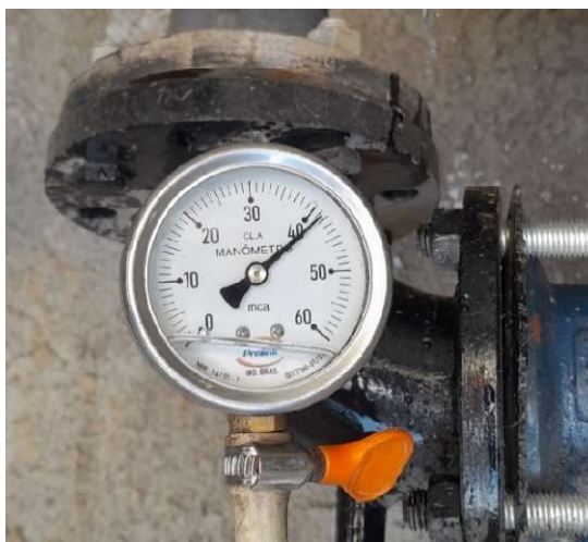
Pressão de Recalque
