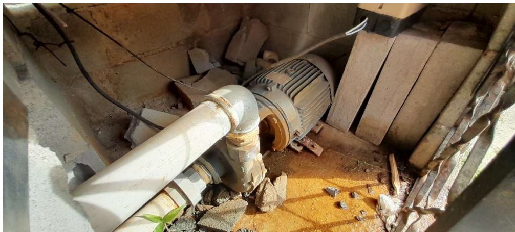
Eletrobomba Ladeira do Grego
