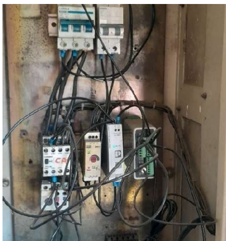
Painel Elétrico Partida Direta
