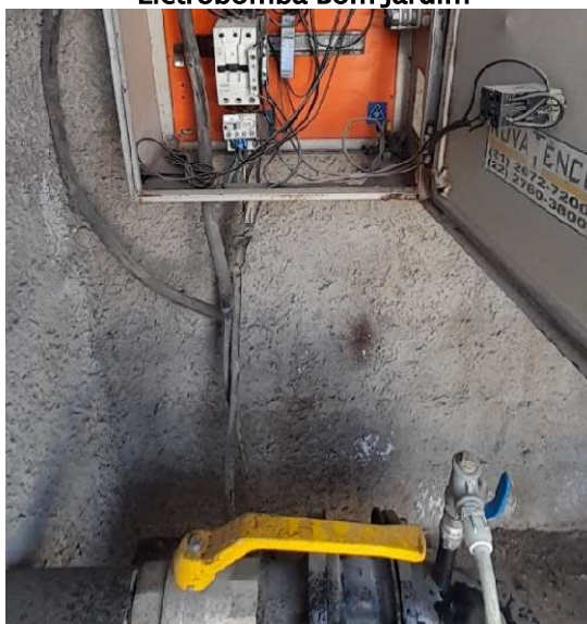
Painel Elétrico Partida Direta
