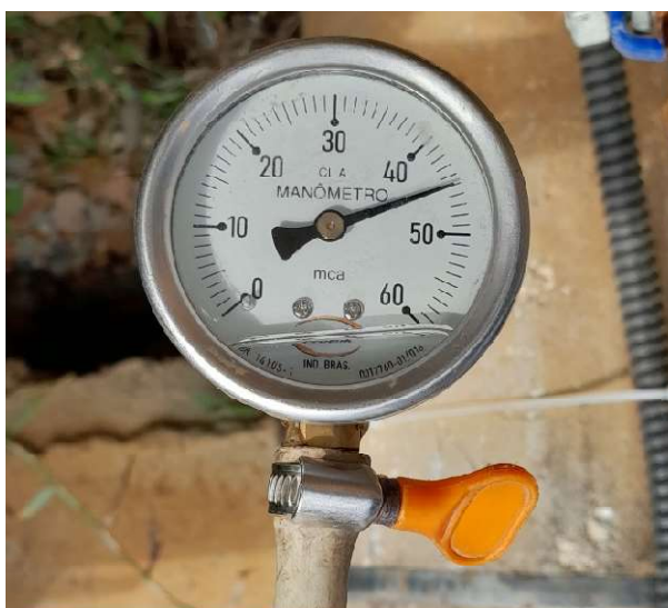
Pressão de Recalque
