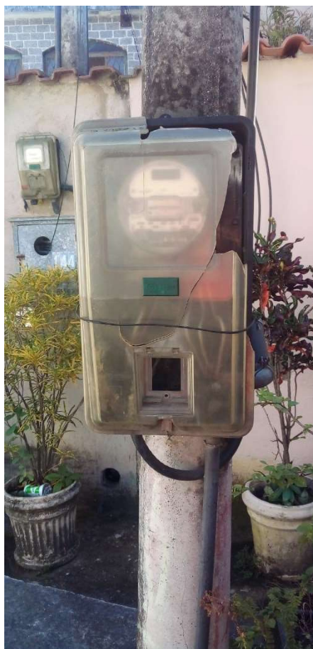
Medidor de Energia
