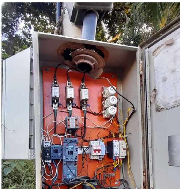
Painel Elétrico Partida Direta
