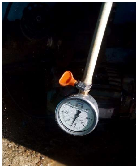
Pressão de Recalque
