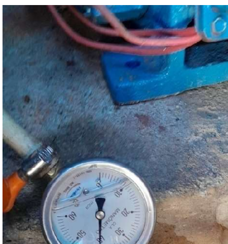
Pressão de Recalque
