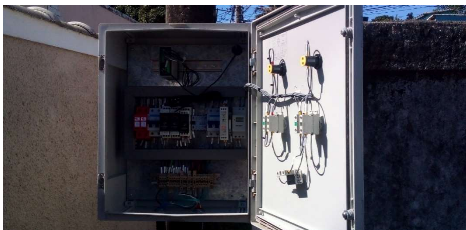
Painel de comunicação C.C.O. vista interna
