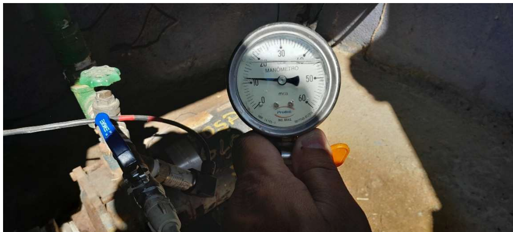
Pressão de Recalque
