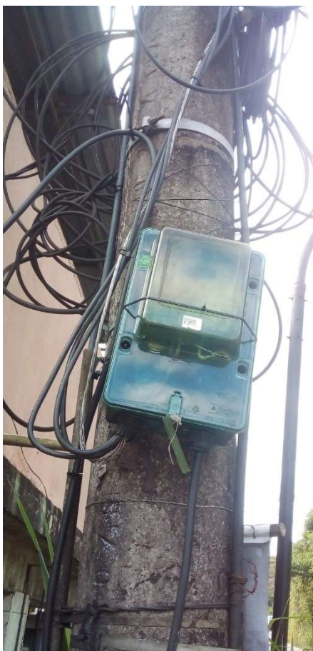
Medidor de Energia
