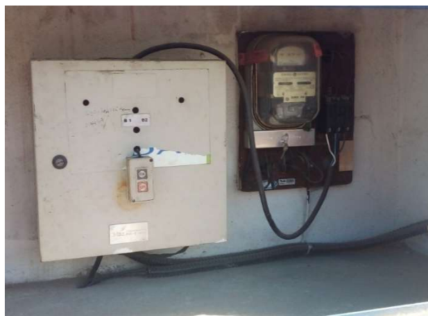
Medidor e Painel elétrico
