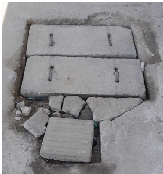
Acesso ao Booster
