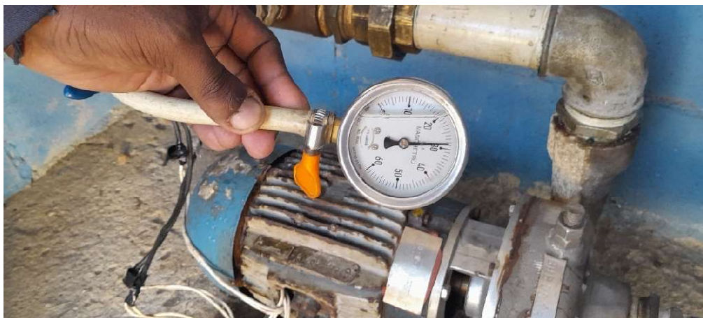
Pressão de Recalque
