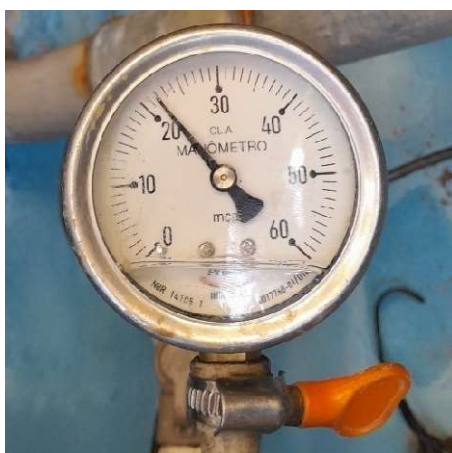
Pressão de Recalque
