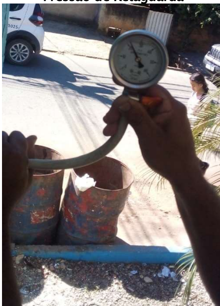
Pressão de Recalque
