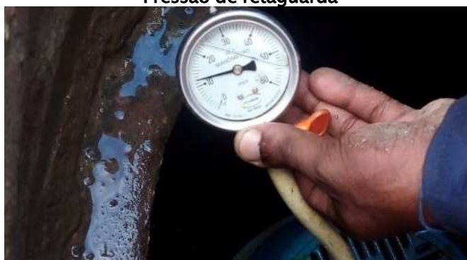
Pressão de Recalque
