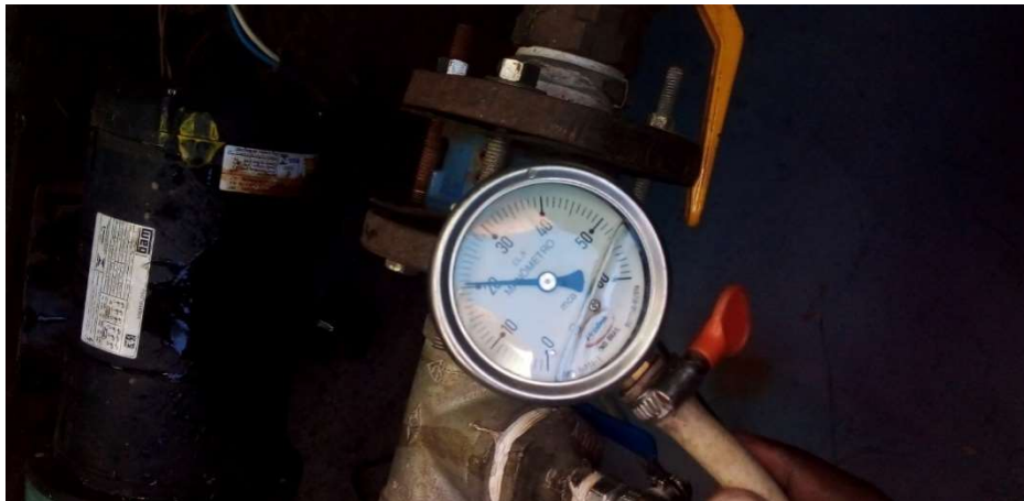
Pressão de Recalque
