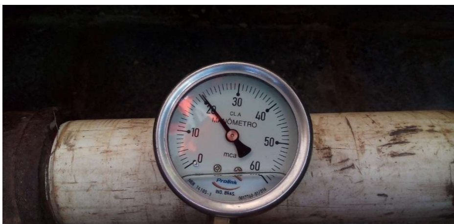
Pressão de Recalque
