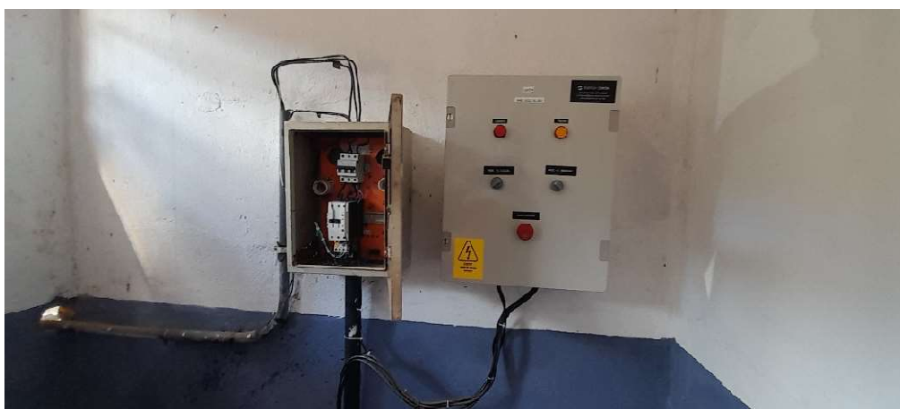
Painel Elétrico Partida Direta / Painel Comunicação C.C.O
