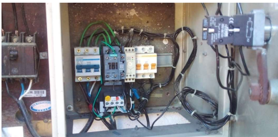
Painel Elétrico Partida Direta
