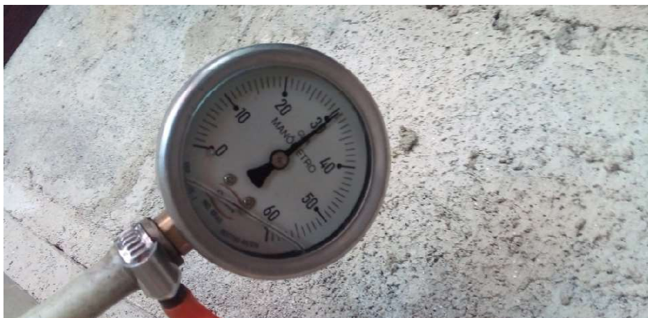
Pressão de Recalque
