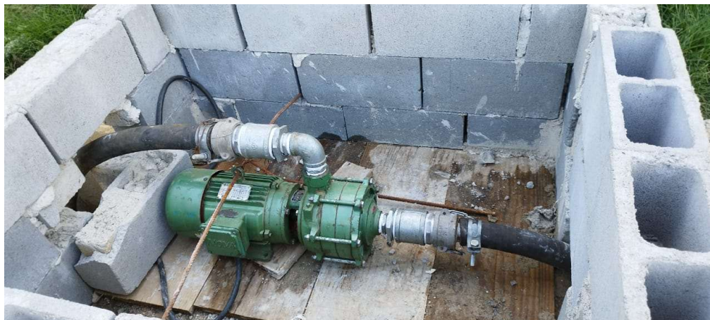
Eletrobomba Ponte Coberta “foto foi enviada pela concessionária”
