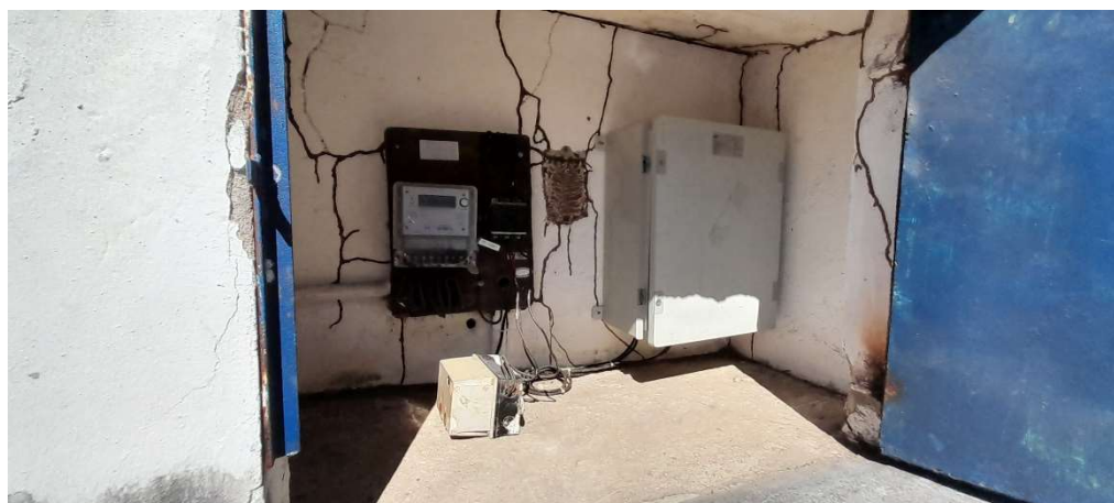
Medidor de Energia /Painel controle C.C.O/ Chave Partida Direta
