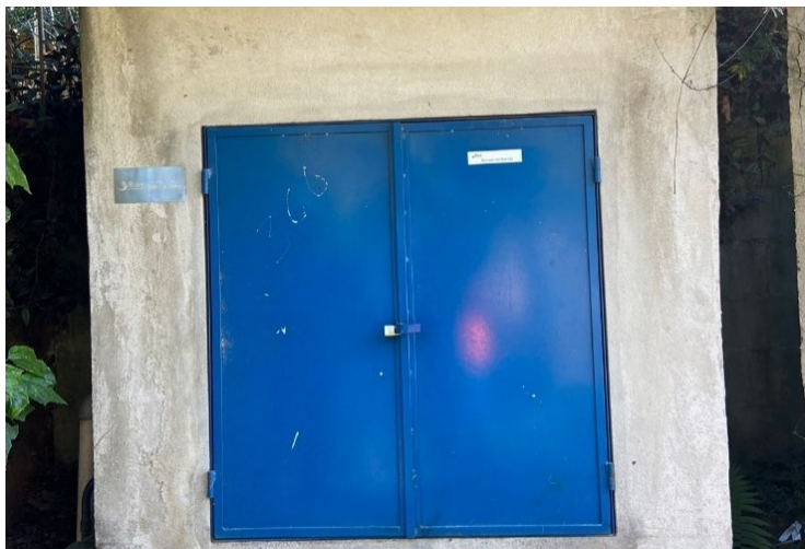
FOTO 15 NÃO CONFORMIDADE Falta placa de identificação
