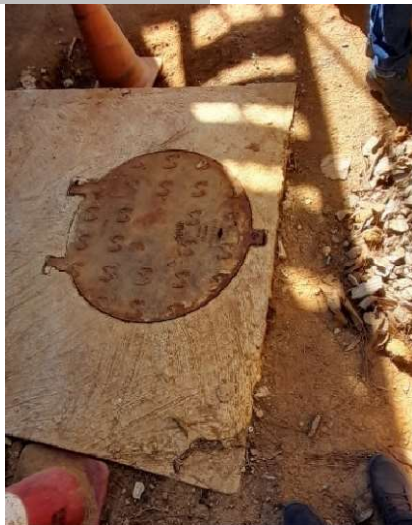
Macromedidor "tampa não foi aberta"
