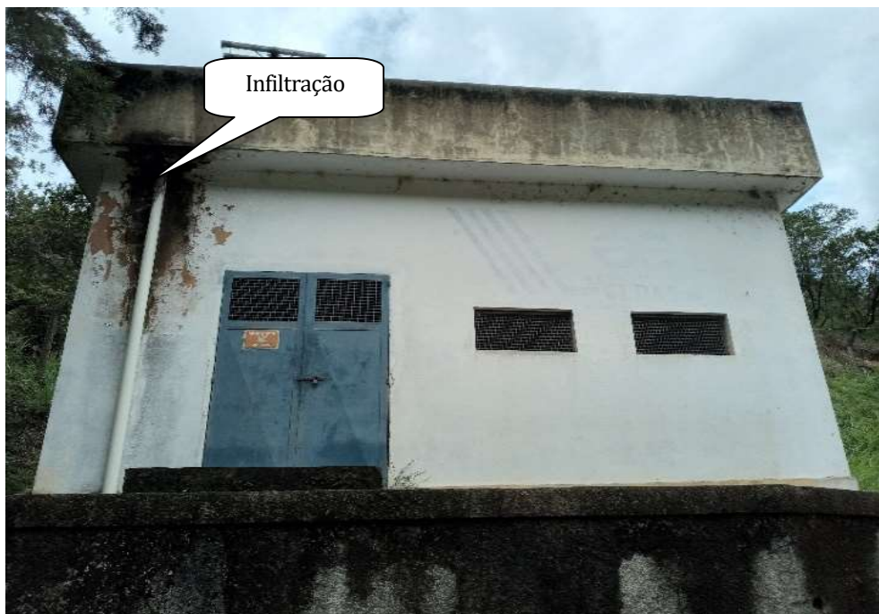
Foto 02 - Subestação de EEAB 13,8kv
