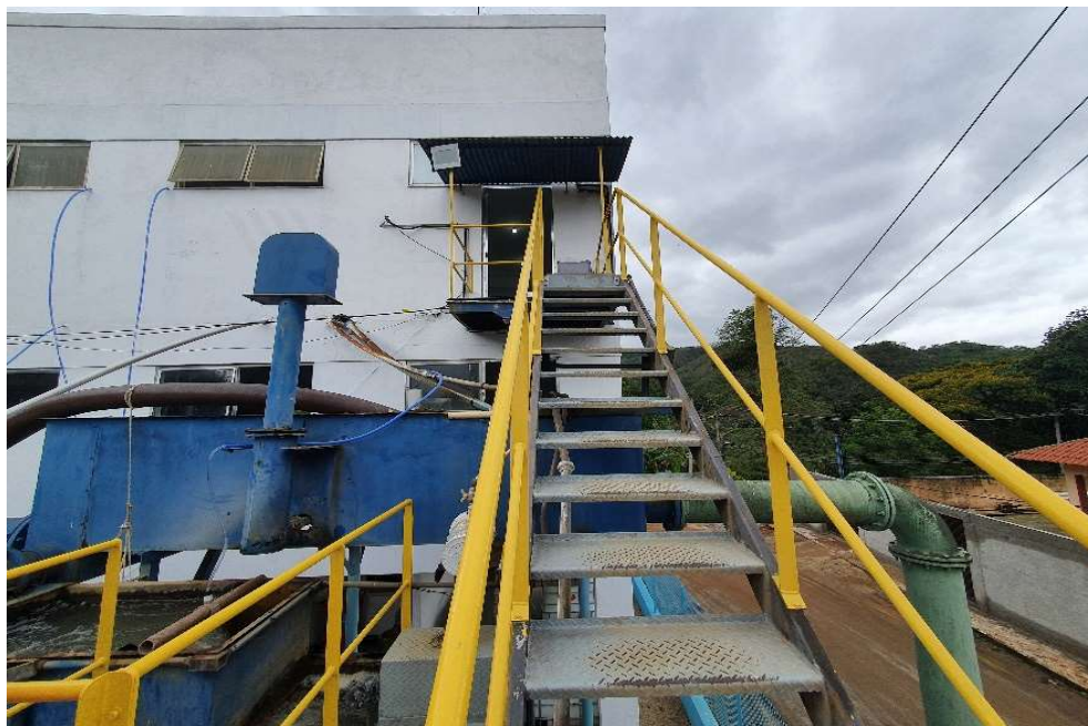
Foto 22 - Acesso à sala de operação
