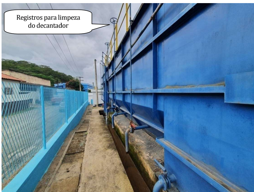
Foto 37- Registro para limpeza do decantador
