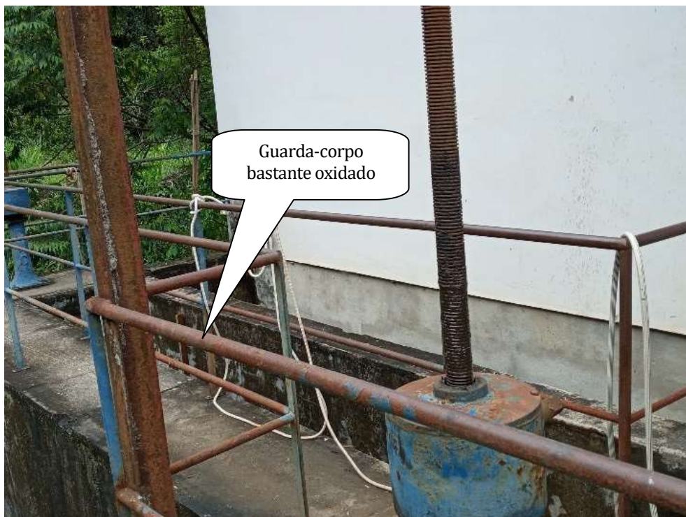
Foto 06 - Poço de captação – retenção de materiais sólidos– EEAB
