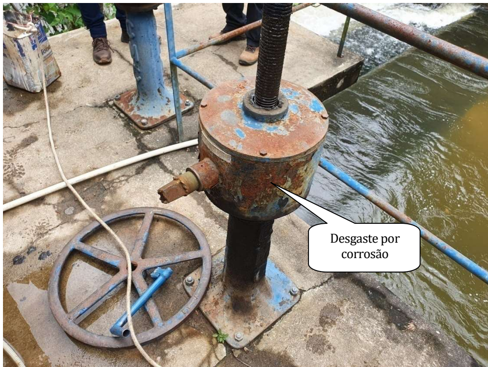
Foto 09 – Válvula para abertura de comportas
