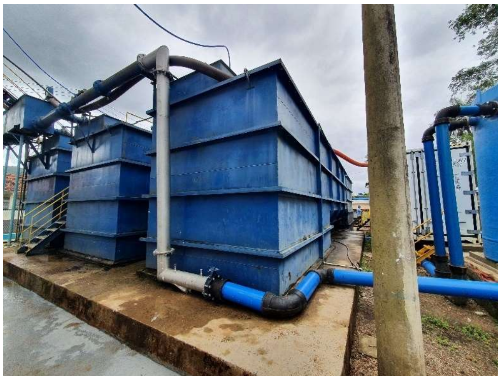
Foto 36 - Módulos de tratamento
