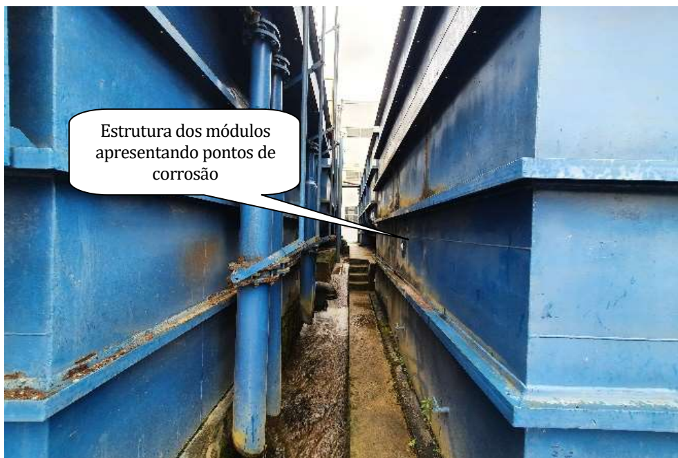
Foto 27 – Módulos da ETA
