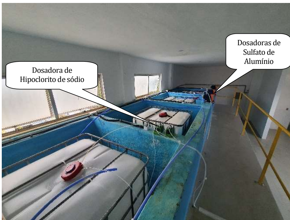
Foto 23 - Tanques de produtos químicos com contenção
