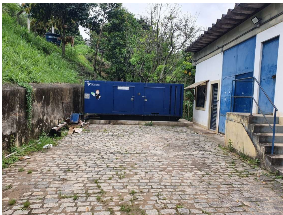
Foto 03 - Gerador de emergência - EEAB
