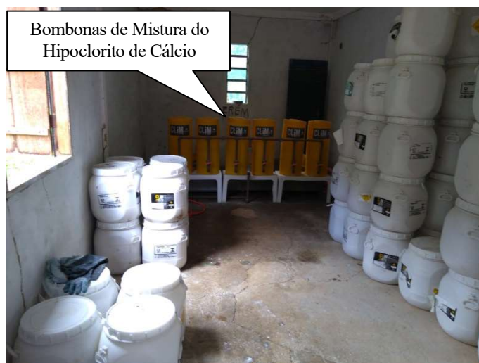
Foto 16 – Local de Armazenamento do Hipoclorito de Cálcio
