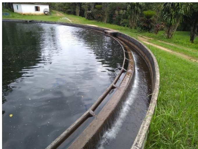
Foto 13 – Saída da Água Clarificada do Decantador
