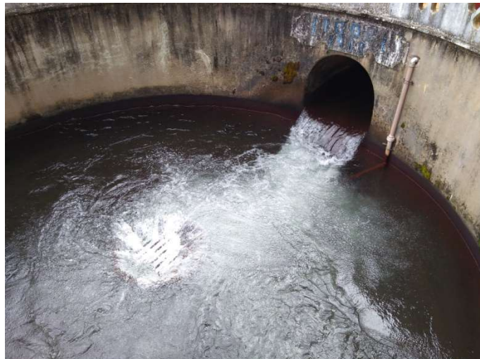
Foto 15 – Água Tratada do Decantador seguindo para o Abastecimento
