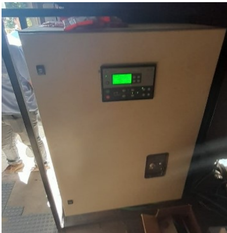
Painel automático de ligação do gerador
