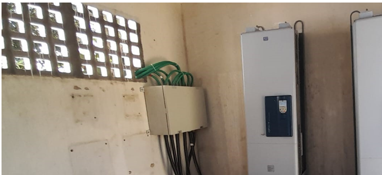
Ligação dos motores com Inversores de frequência
