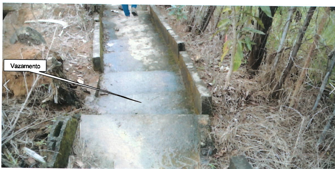
Vazamento na escada gerado pela água da barragem antiga
