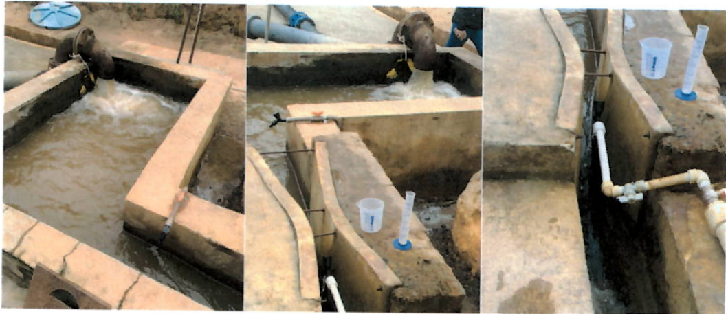
Entrada de água bruta + calha Parshall para medição e aplicação do coagulante
