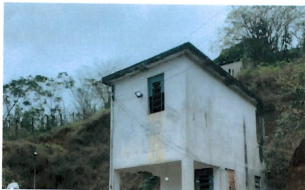
Prédio principal da Unidade com o vidro da janela quebrado
