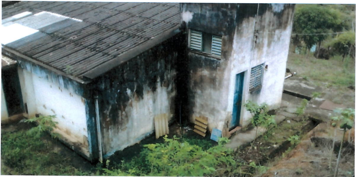
Edificação do reservatório com necessidade de reforma
