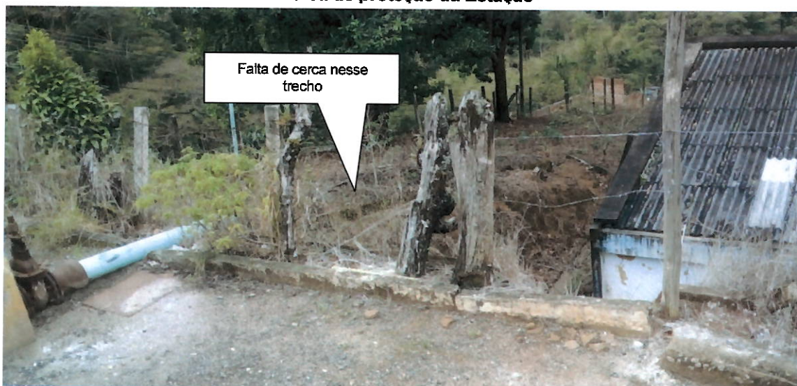
Cerca de proteção da Estação danificada
