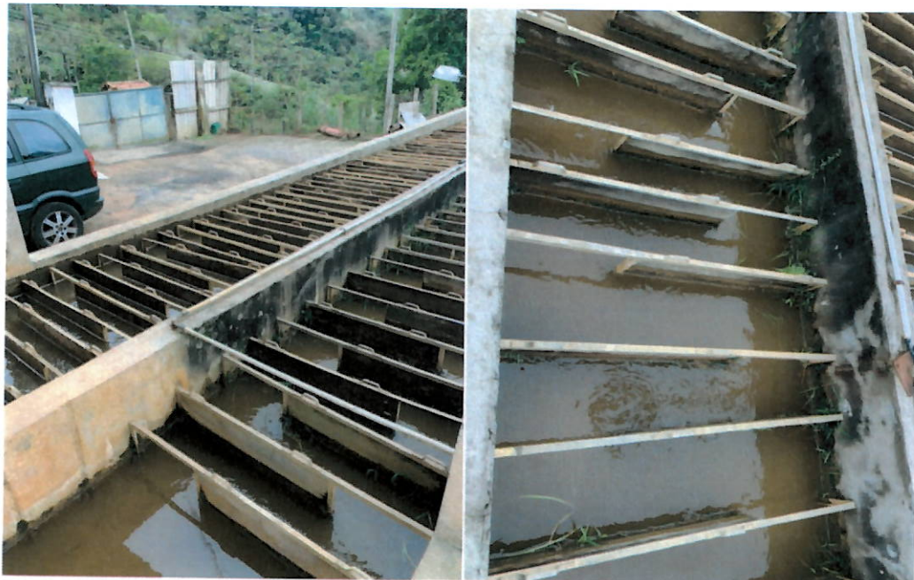
Floculador de fluxo horizontal com chicanas de placas em madeira com vegetação crescendo livremente
