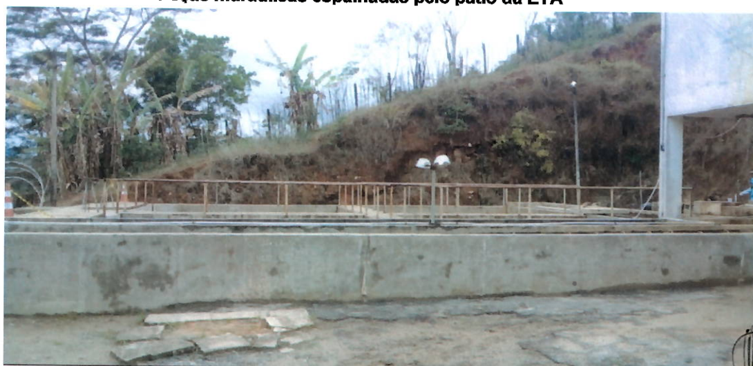
Guarda-corpo da ETA com alto grau de oxidação
