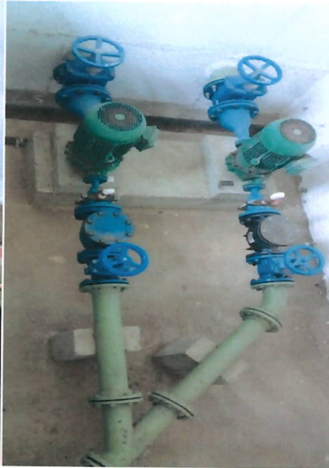
Sistema de recalque da ETAc Fazenda da Grama
