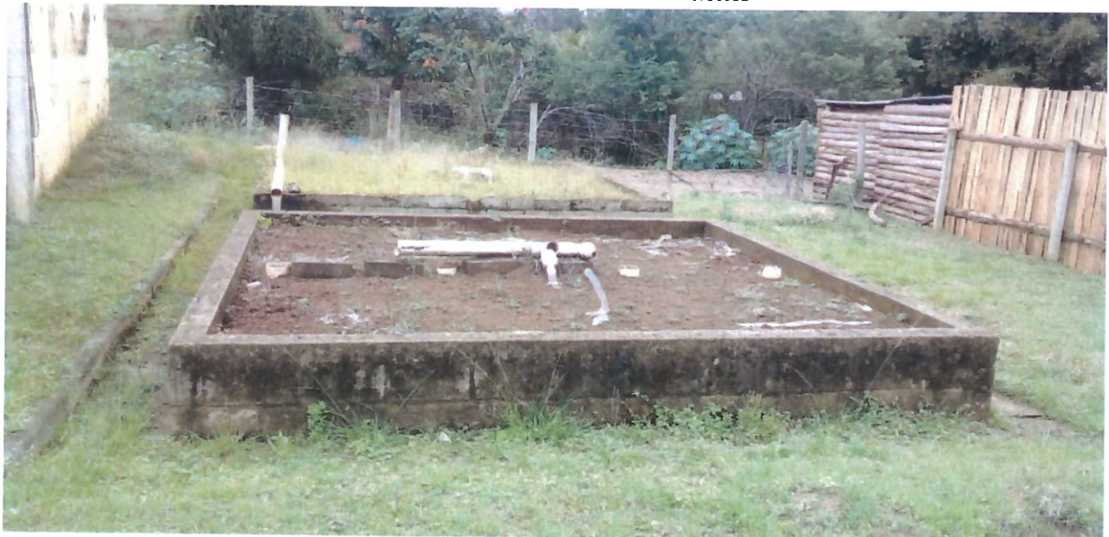
Leito de secagem do lodo (inoperante)
