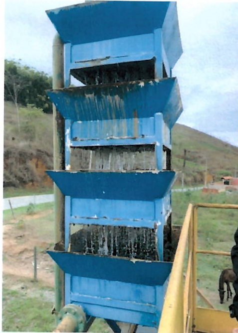
Aerador da ETAc de Fazenda da Grama
