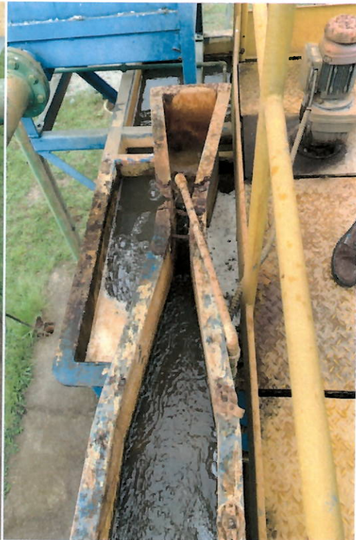
Calha Parshall para medição de vazão
