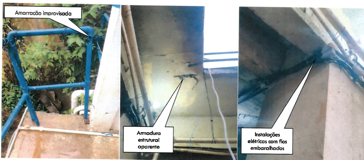
Guarda-corpo posicionado de forma improvisada
