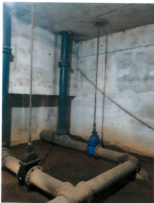
Casa de manobras dos filtros
