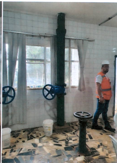
Volantes de manobras das válvulas dos filtros
