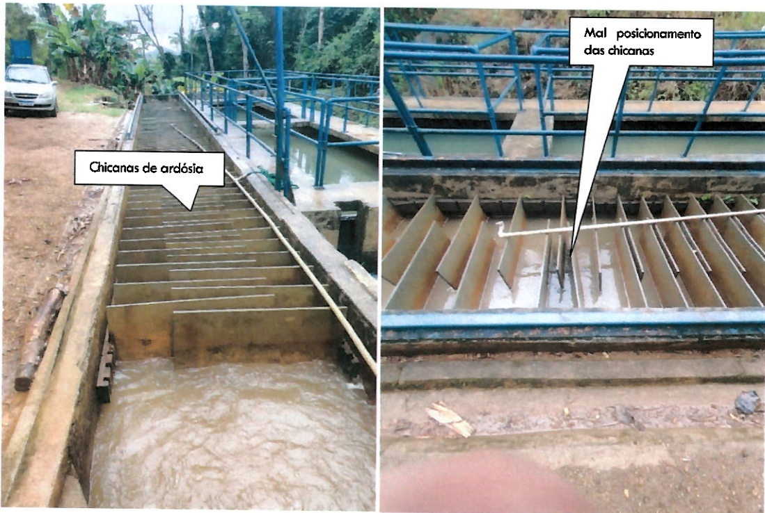
Casa de manobras dos filtros – Chicanas
