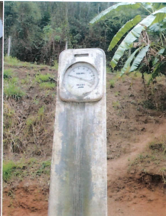
Leitor de vazão inoperante
