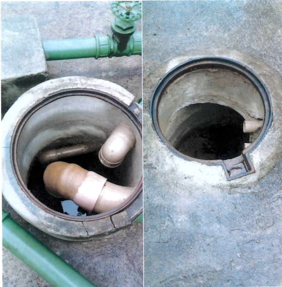
Falta de tampa de ferro fundido articulada nos bueiros ao longo da ETE
