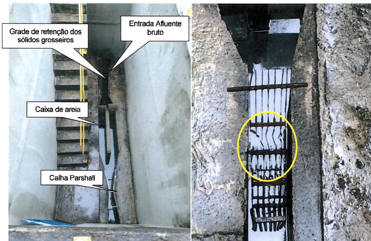
Entrada de esgoto bruto / Gradeamento / Caixa de areia / Calha Parshall
