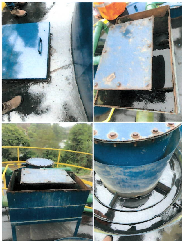
Parte superior do Reator apresentando pontos de corrosão
