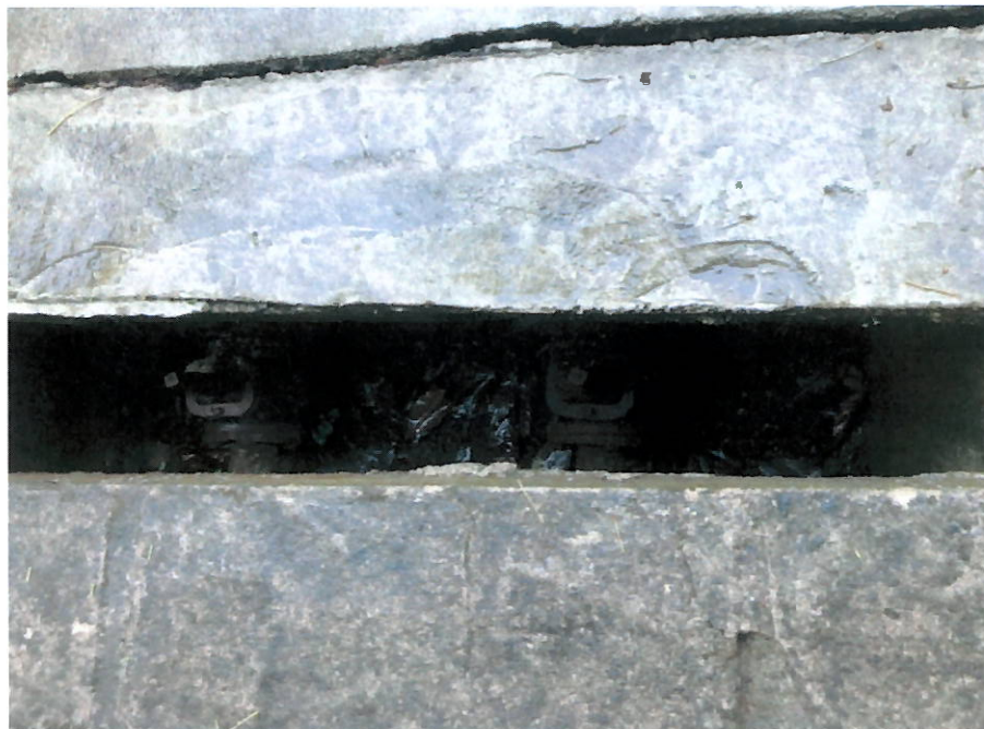
Sistema de manobra e acesso aos registros inseguro para quem transita na ETE
