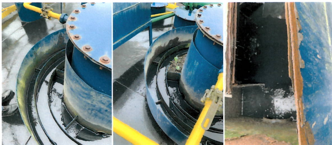
Parte superior de Reator apresentando pontos de corrosão
