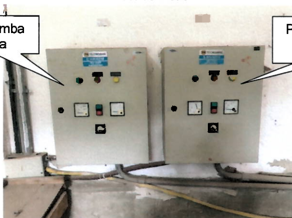
Painéis de controle das bombas de distribuição
