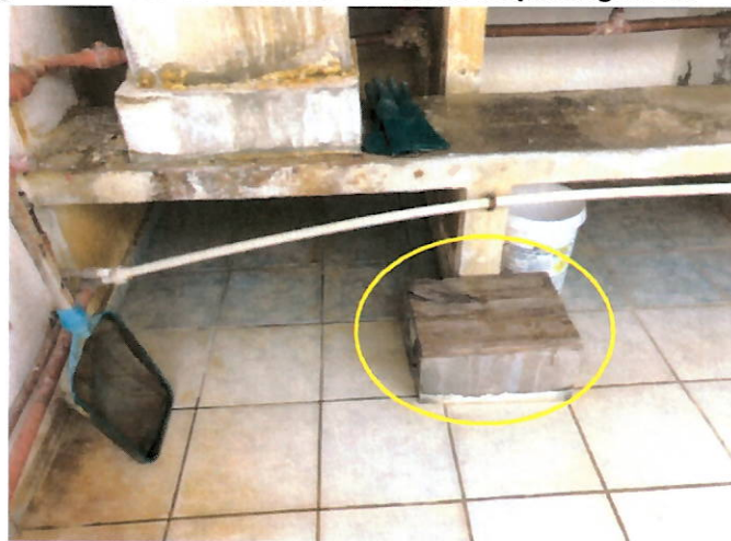
Acesso a caixa de diluição do sulfato
