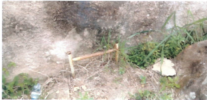
Resto da escada de acesso a parte superior do reservatório
