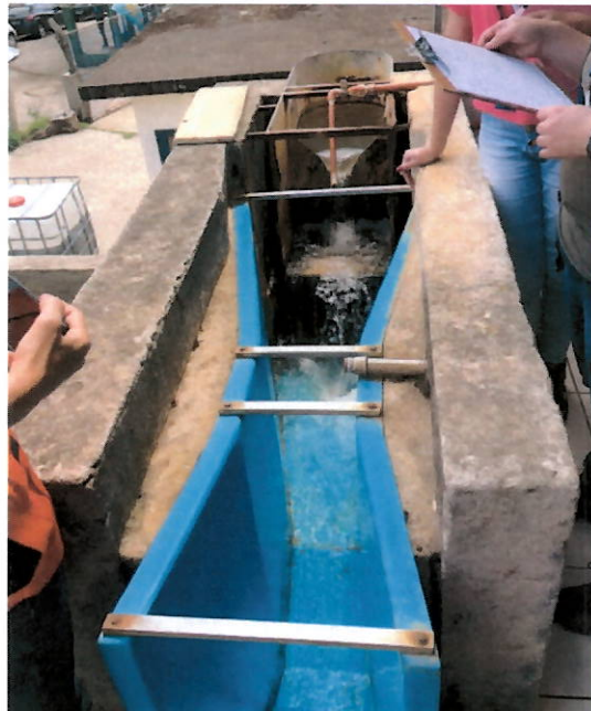
Visão geral da Caixa de entrada + Calha Parshall
