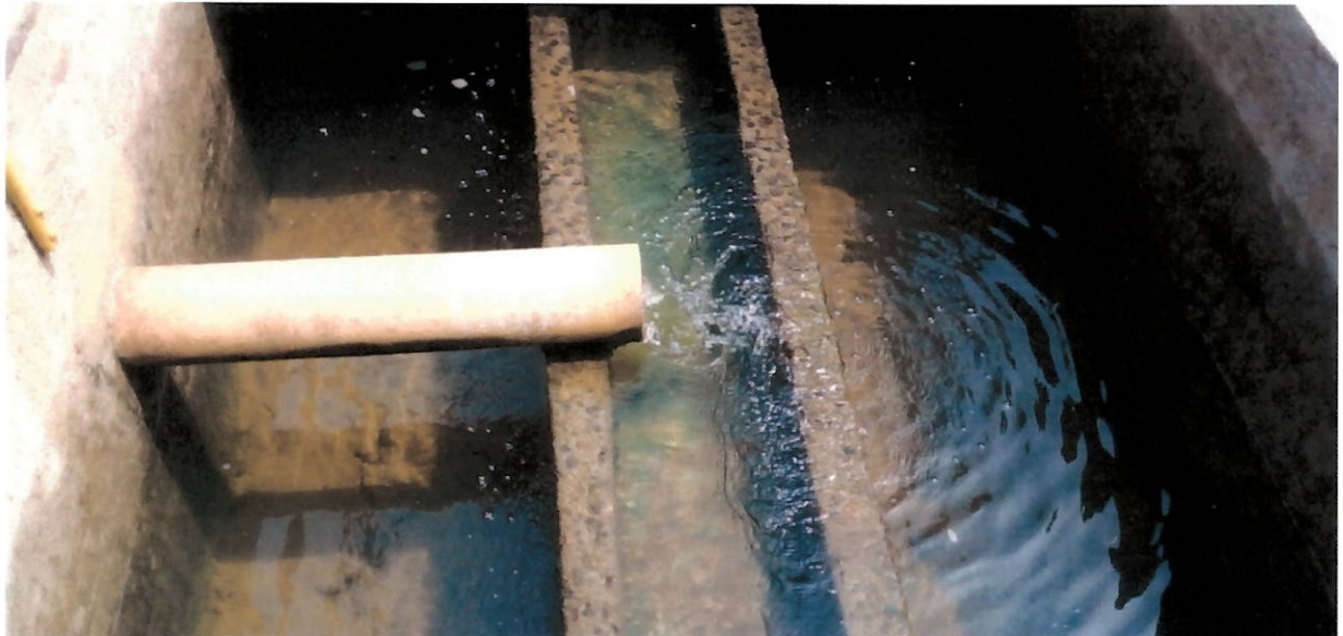
Filtro (verificar a necessidade de troca do leito filtrante)
