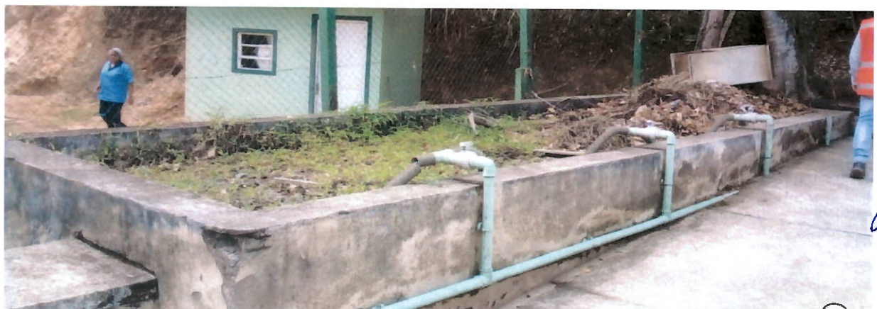
Caixa de alocação dos bag's para tratamento do lodo – inoperante
