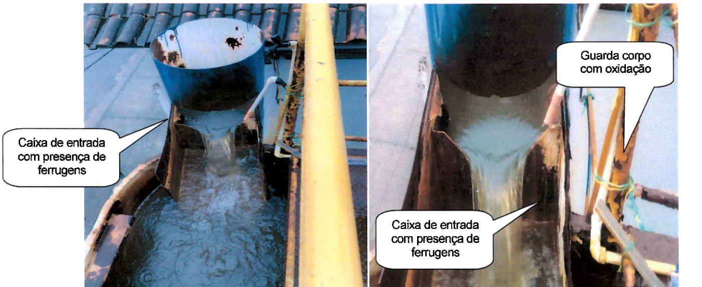
Entrada de água bruta com adição de sulfato de alumínio
