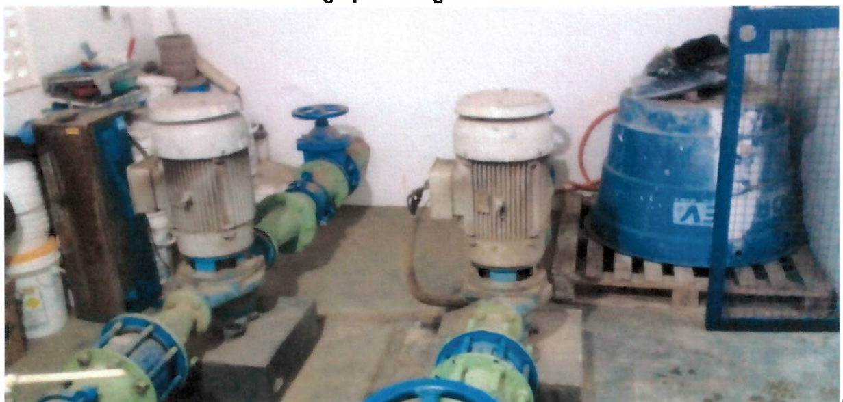
Bombas que recalcam água para o reservatório
