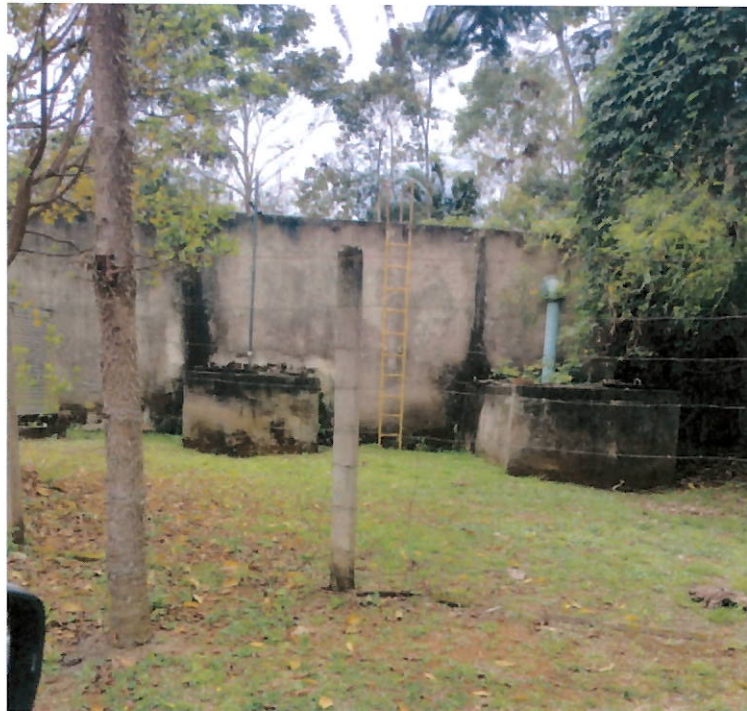
Reservatório para onde a água tratada segue antes da distribuição
