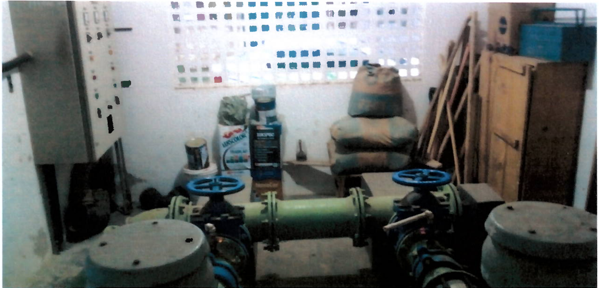
Materiais / produtos armazenados próximo as bombas e ao painel elétrico
