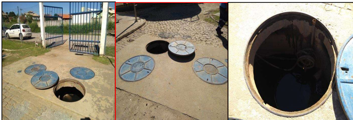
Figura 5 – Elevatória de esgoto bruto: poço das bombas submersíveis com recalque para o tratamento preliminar.
