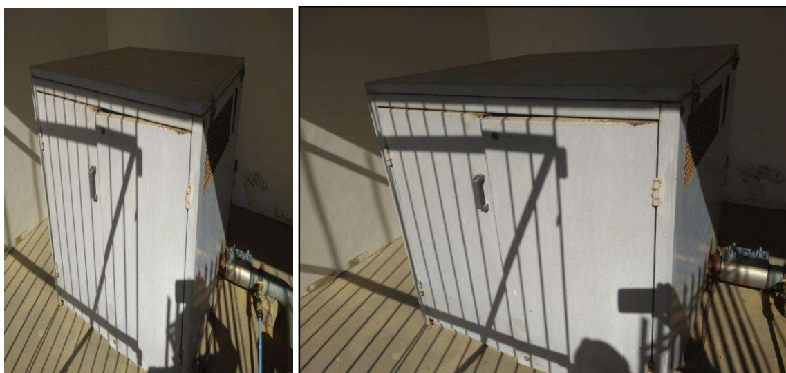
Figura 12 – Soprador enclausurado com abafador de ruído, para aeração do FBAS
