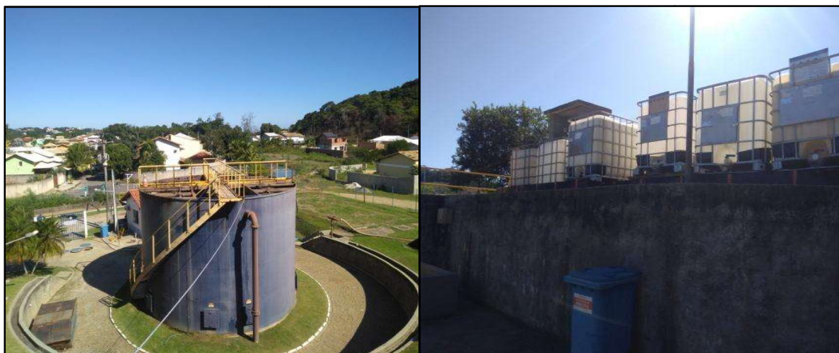
Figura 2 – Vistas gerais do sistema de tratamento dentro da ETE Bacaxá (tratamento preliminar na imagem da direita, o tanque do tratamento primário - secundário - terciário no canto da imagem da esquerda).
