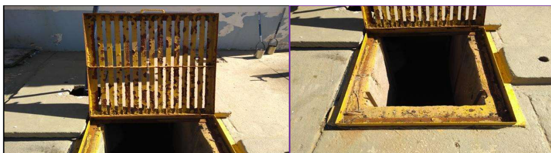
Figura 4 – Caixa de chegada: chegada do recalque e da captação do rio Bacaxá, com grade de malha grossa de limpeza manual. Destaque para corrosão da grade.
