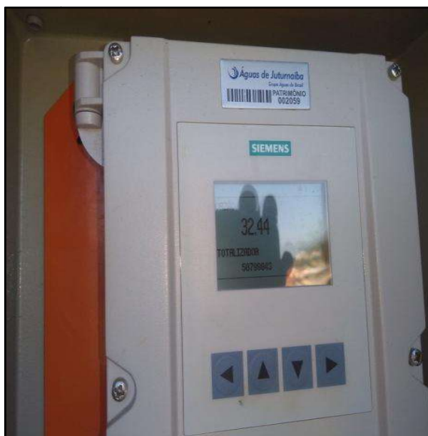
Figura 7 – Medidor de vazão de entrada: calha Parshall com sensor ultrassônico (vazão instantânea=32,44 L/s).
