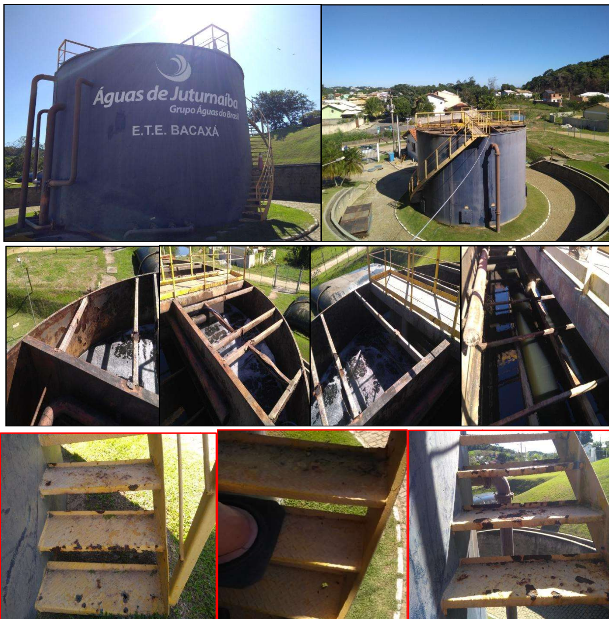
Figura 8 - Tratamento secundário com Filtro Biológico Aerado Submerso – FBAS e decantador terciário: vistas laterais, vistas superiores e destaques para a escada de acesso e para as estruturas internas aparentes muito enferrujadas (corrosão = risco operacional).
