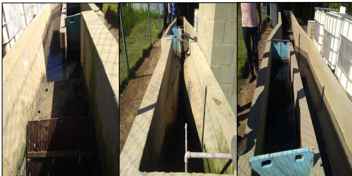
Figura 6 – Tratamento preliminar: entrada do recalque (afogada), grade a 80° com abertura de malha média e limpeza manual e desarenadores de limpeza manual.
