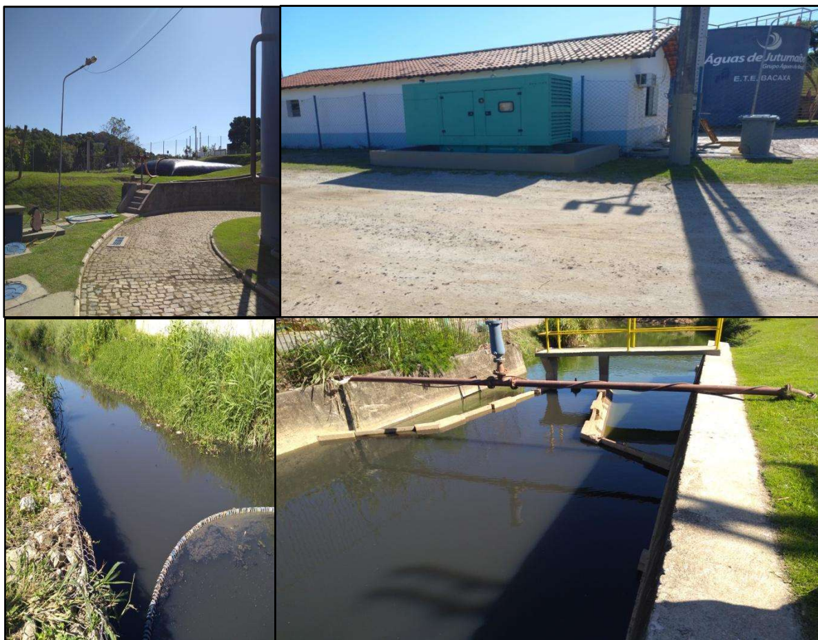
Figura 1 – Vistas do perímetro da ETE Bacaxá: acessos principal (acesso ao “bags”) (estão faltando os guarda-corpos da escada e a tubulação precisa de pintura para conservação) e captação do Rio Bacaxá.
