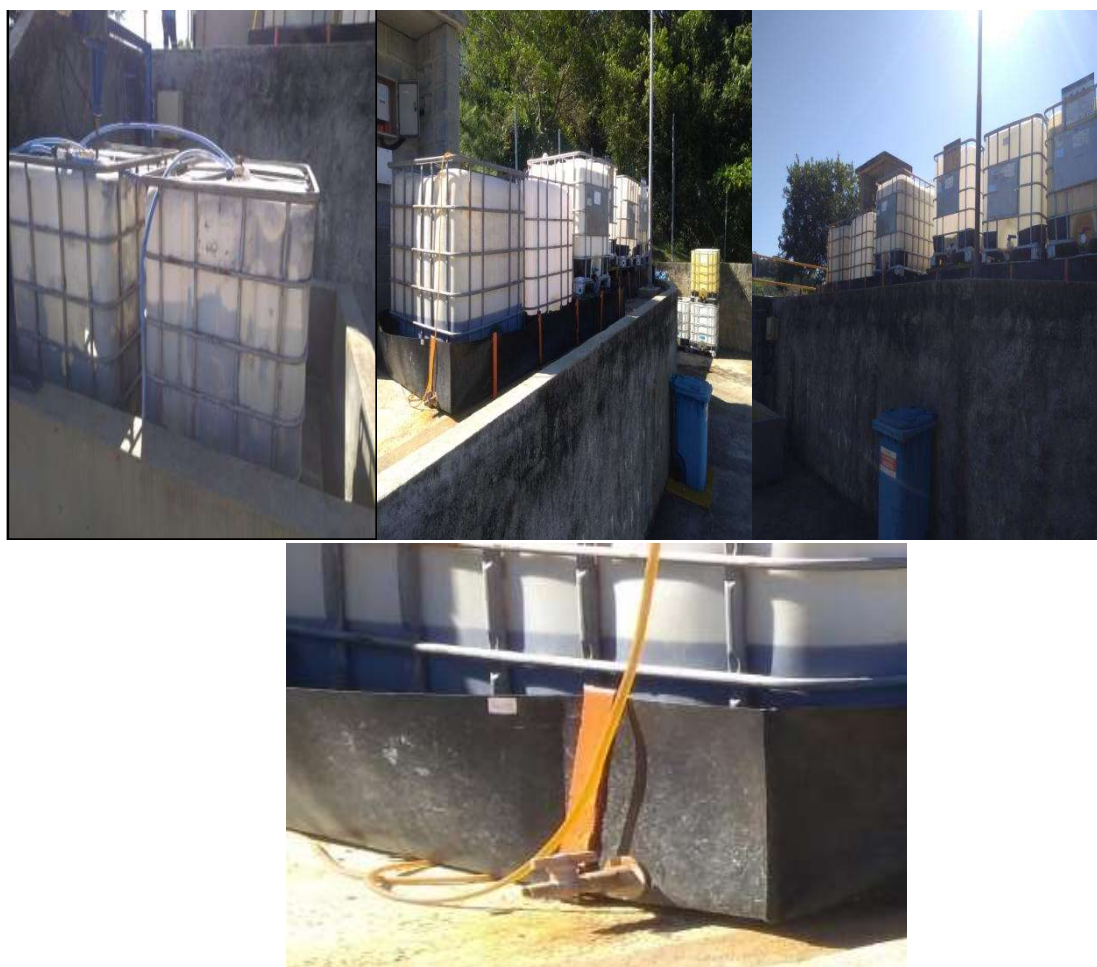
Figura 10 – Dosagem de produtos químicos: tanques de mistura e dosagem de antiespumante bisteramida (estrutura de suporte e carcaça do motor enferrujadas ); tanques de Cloreto de Polialumínio (PAC) para remoção de fósforo, dentro de baias de contenção em material plástico, mas com saída aberta para extravazar na caixa de ralo de drenagem ao lado. Destaque para os tanques estocados de PAC e bisteramida apoiados em paletes de madeira sobre estrutura metálica enferrujada , dentro das baias plásticas.
