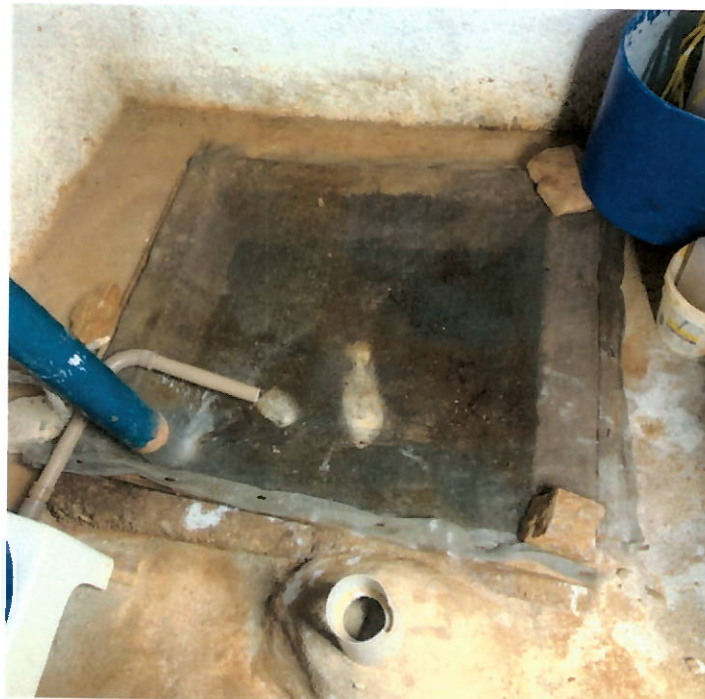
"Filtro" na entrada do reservatório
