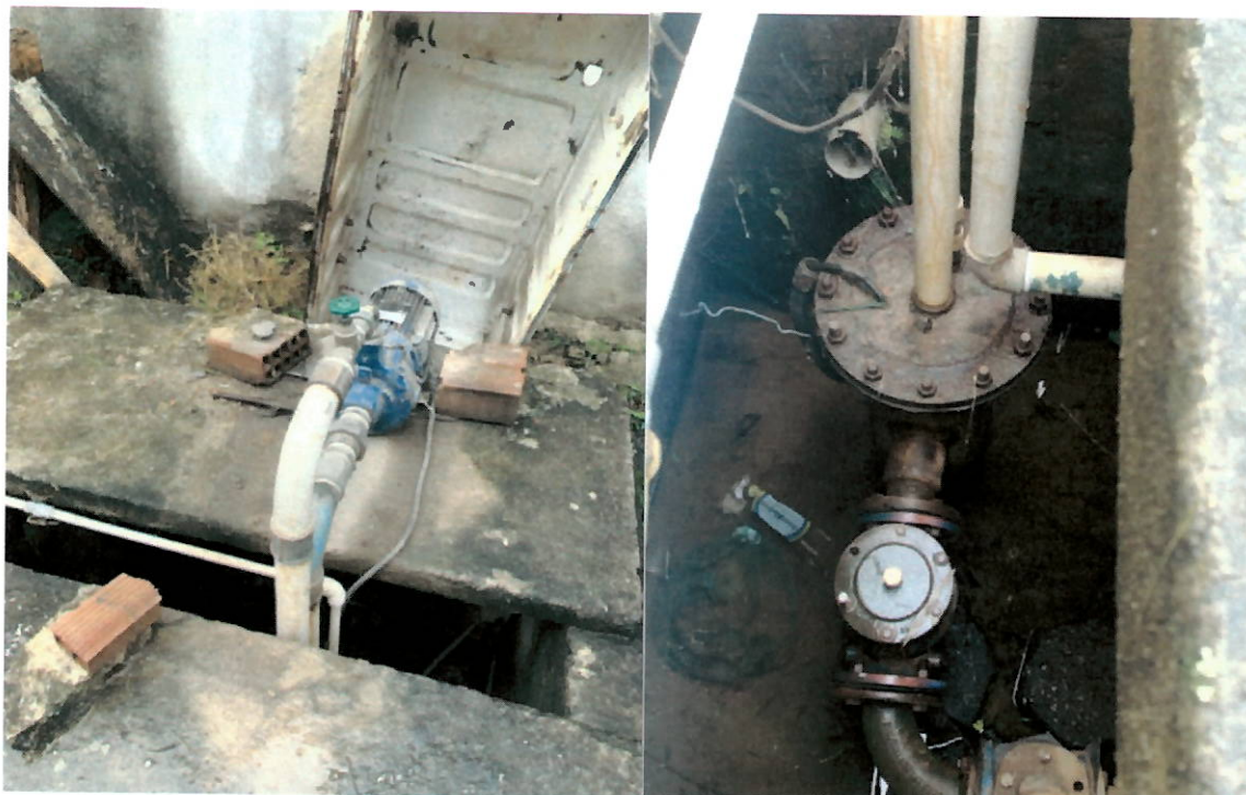
Bomba utilizada para recalcar água bruta até a UT
