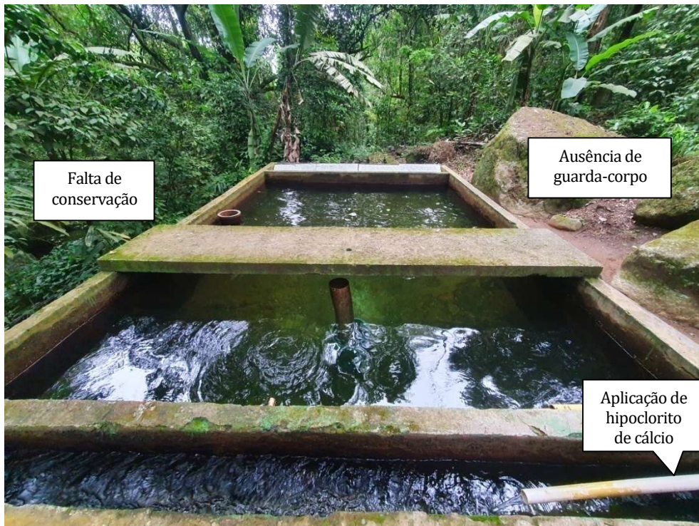
Foto 04 – Câmara de sedimentação
