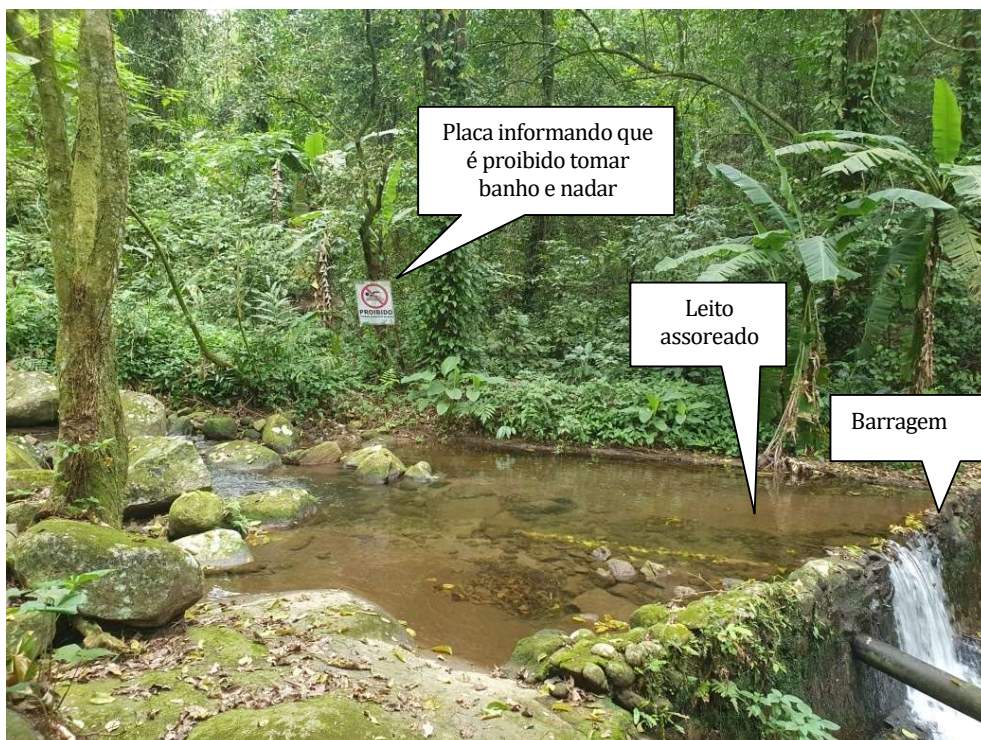
Foto 02 – Captação do Rio Sacarrão
