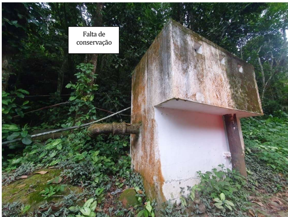
Foto 12 – Caixa de passagem
