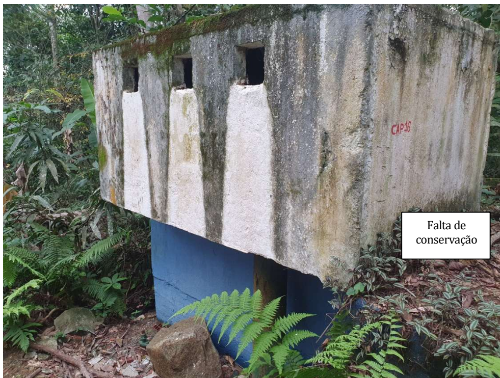
Foto 11 – Caixa de passagem
