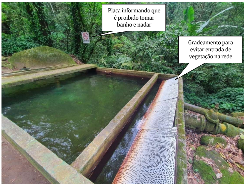
Foto 05 – Câmara de sedimentação
