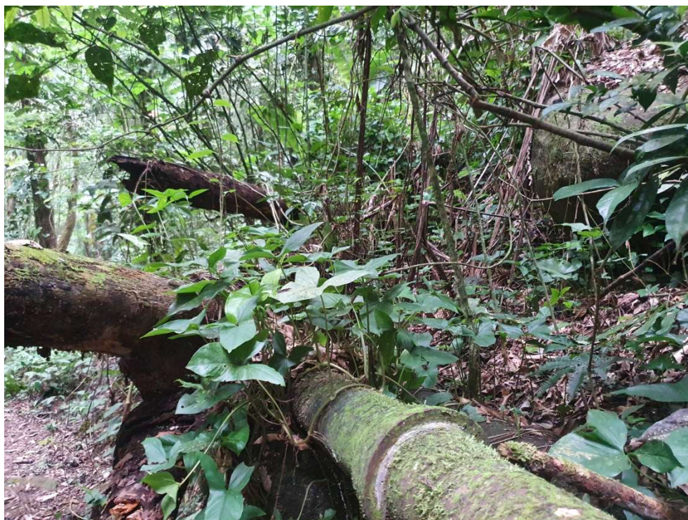
Foto 09 – Árvore caída sobre a tubulação
