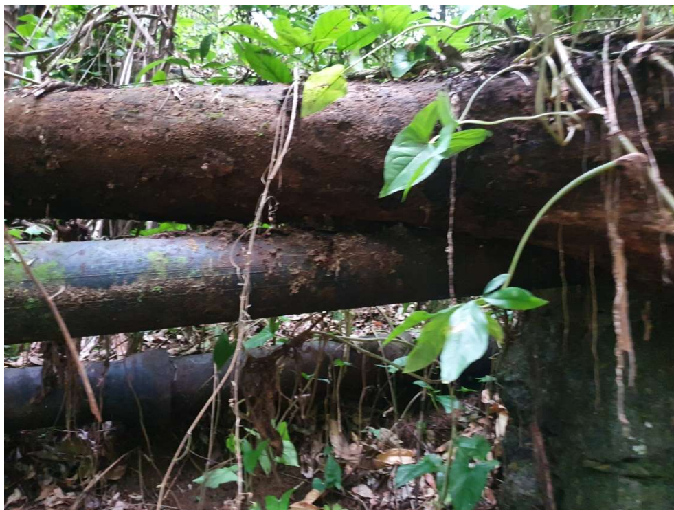
Foto 10 – Árvore caída sobre a tubulação
