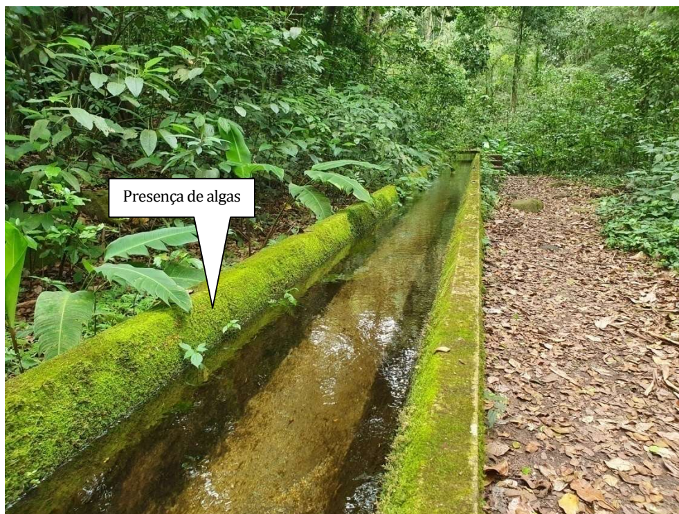
Foto 04 – Calha de adução de água bruta
