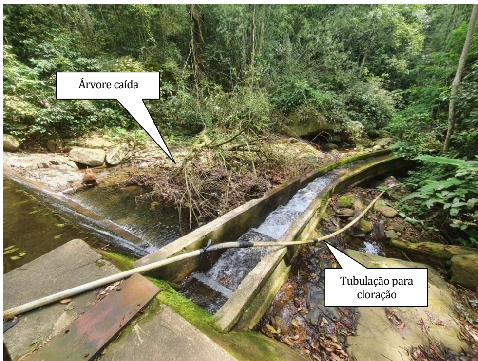
Foto 03 – Calha de adução de água bruta
