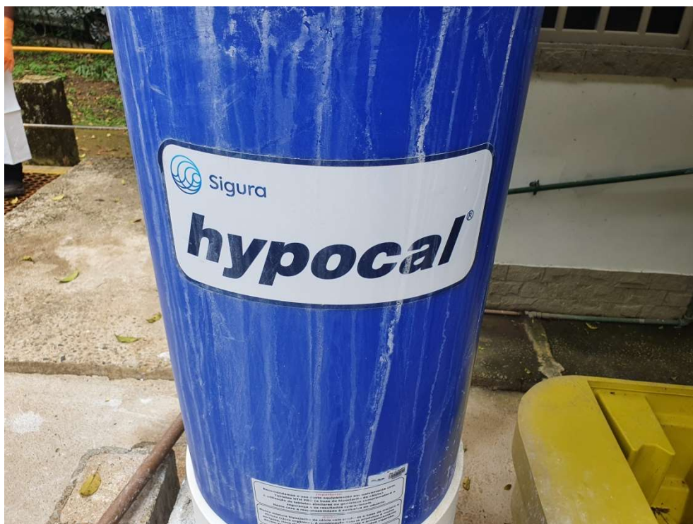
Foto 09 – Tanque de tabletes de hipoclorito de cálcio
