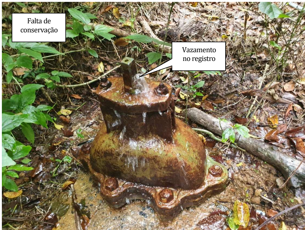
Foto 11 – Registro de saída da água tratada
