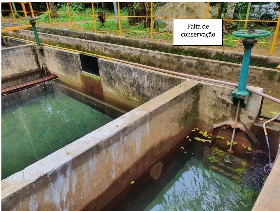
Foto 07 – Canal de coleta de água tratada
