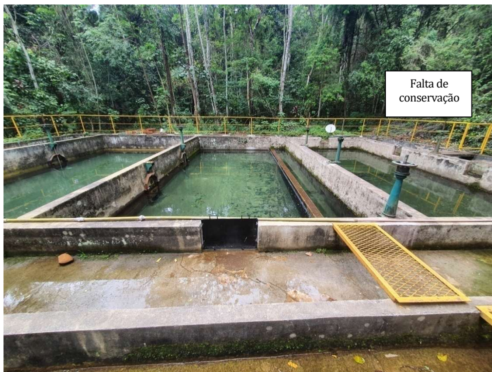
Foto 06 – Câmaras de sedimentação
