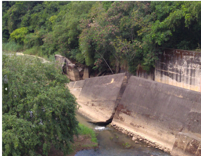
Foto 9 – Canal de Restituição Margem Direita, Colapsada
