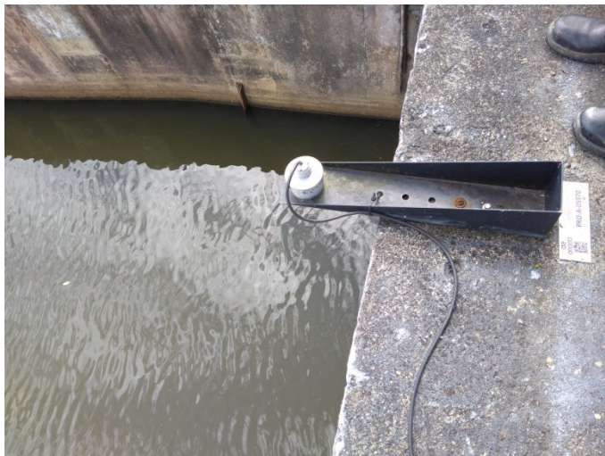
Foto 16 – Medidor de Vazão
