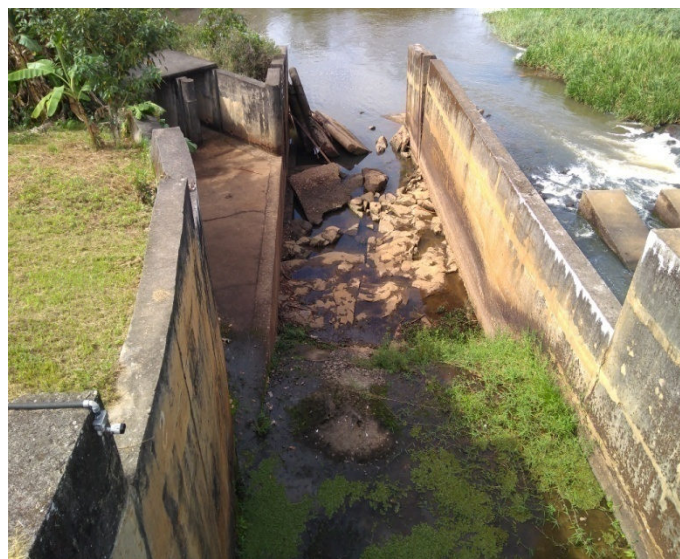
Foto 8 – Canal de Restituição Margem Esquerda, Colapsada
