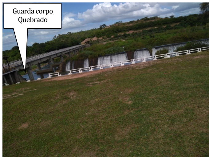
Foto 10 – Lateral Direita dos Vertedouros (Guarda Corpo Quebrado)
