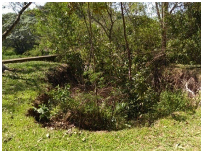
Foto 14 – Terreno Assoreado na Lateral do Canal de Restituição Margem Direita
