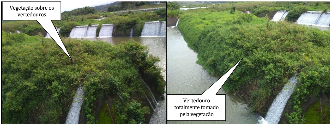
Foto 03 – Vertedouros da Barragem com muita Vegetação
