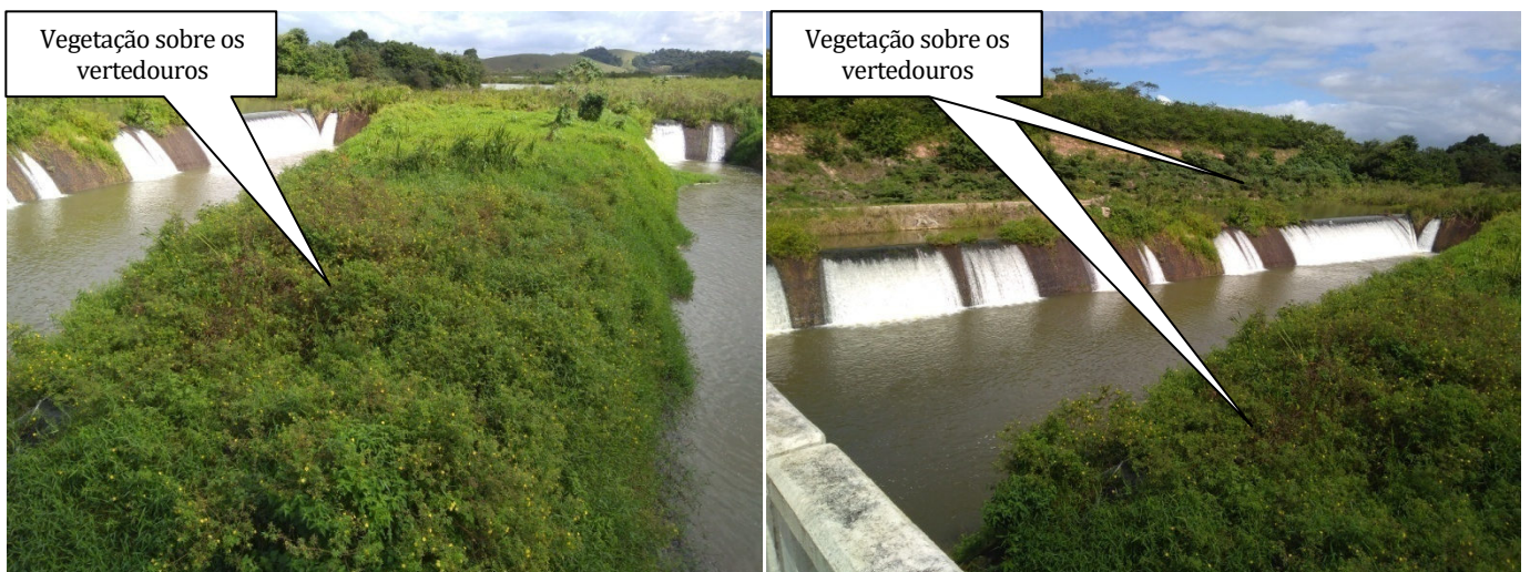
Foto 5 – Vertedouros da Barragem com Vegetação
