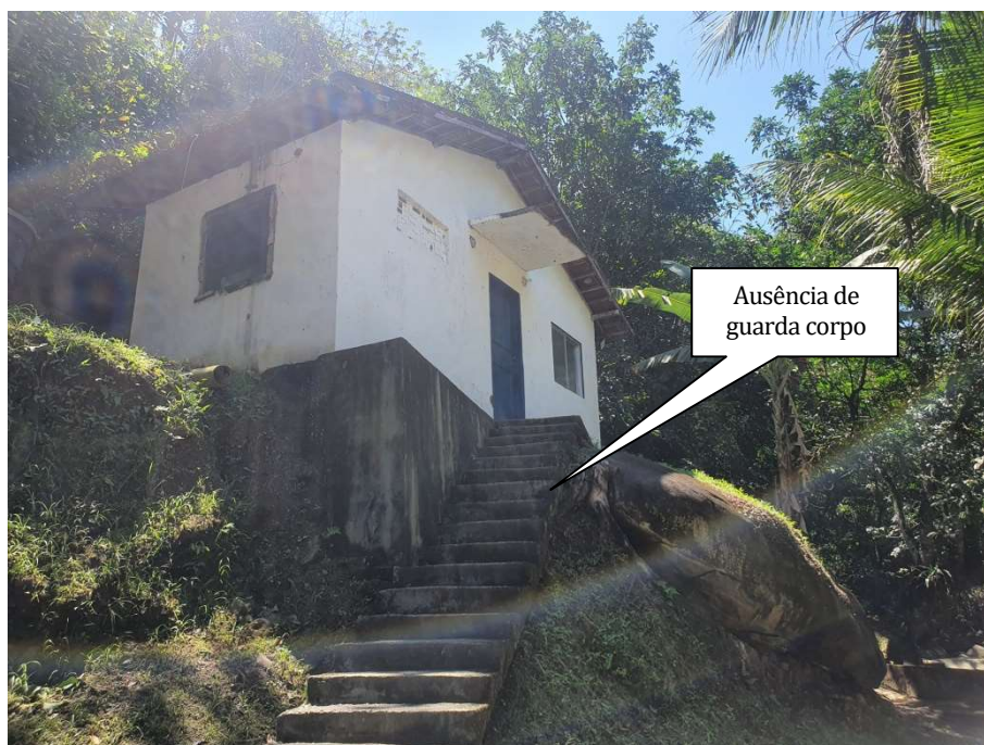
Foto 23 – Sala do operador
