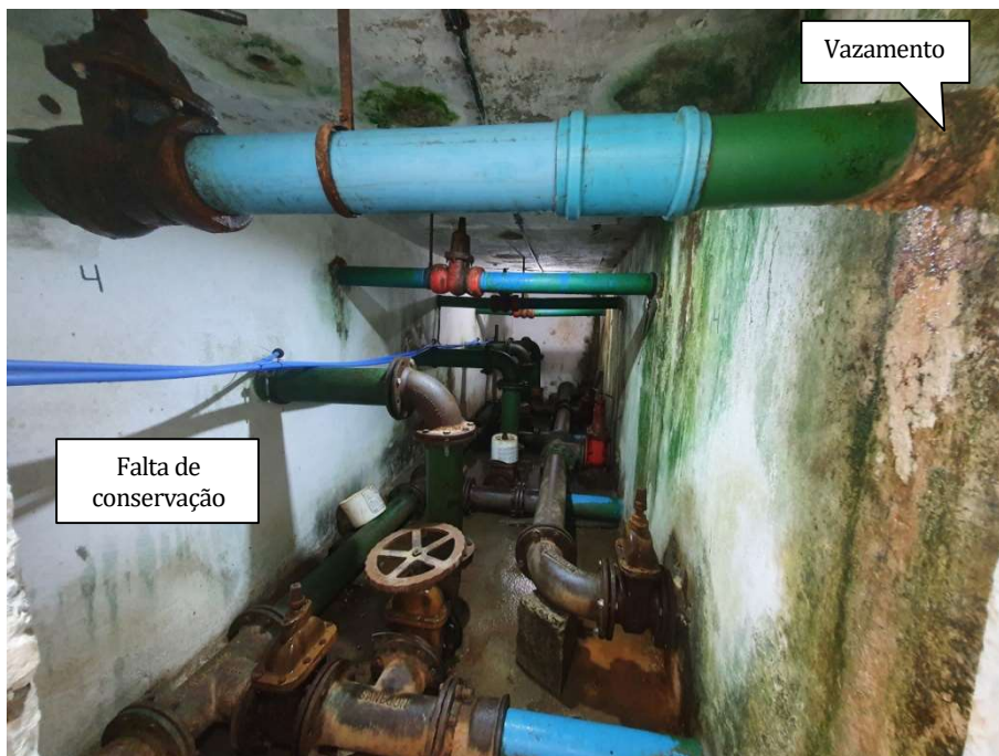
Foto 13 – Casa dos registros de lavagem dos filtros
