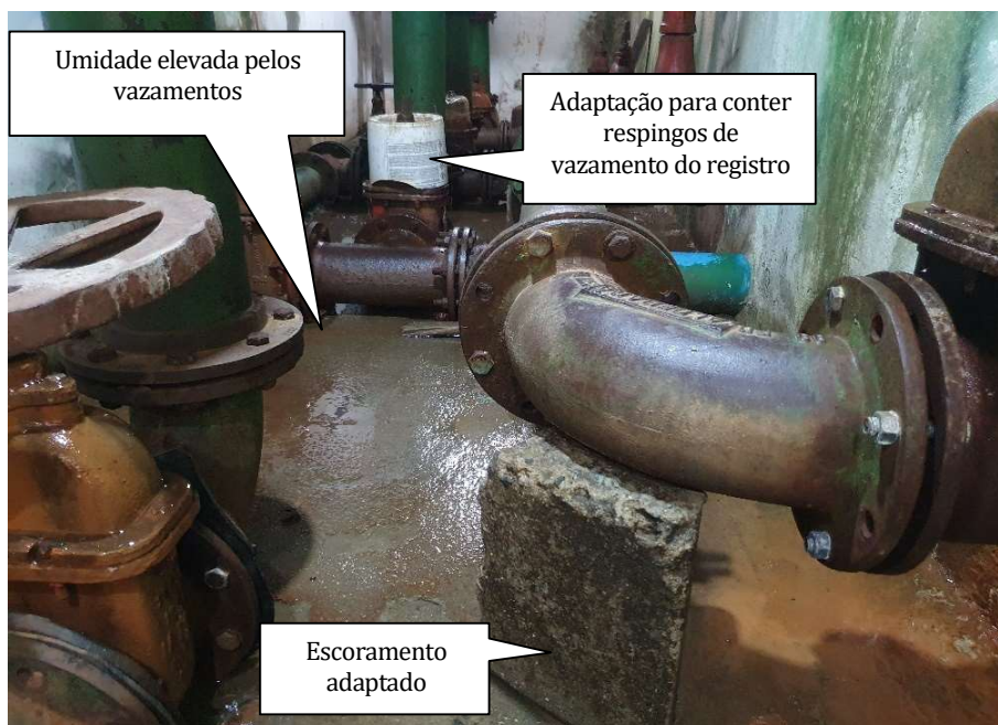
Foto 15 - Casa dos registros de lavagem dos filtros
