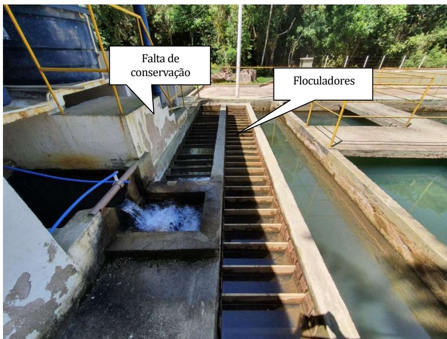
Foto 07 – Tanque de floculação
