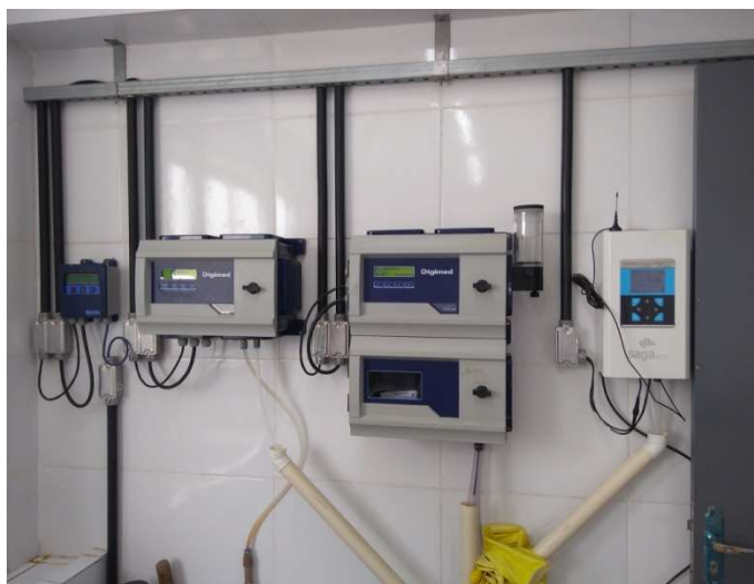
Foto 28 – Equipamentos de Controle da Água Automatizado (Não Instalado)
