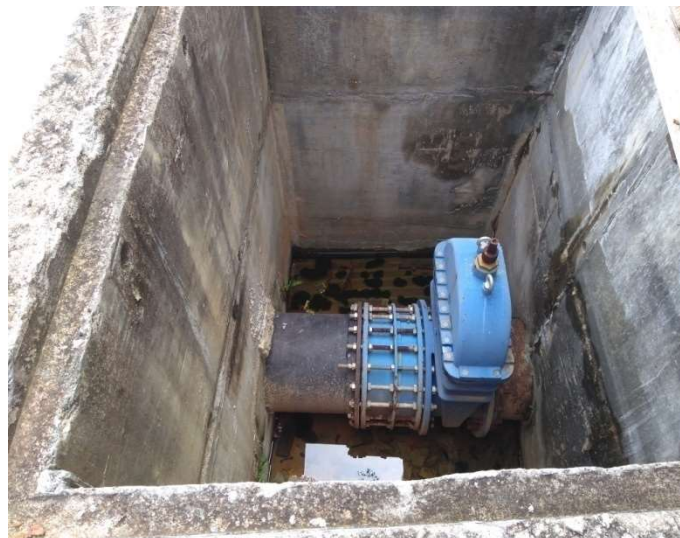
Foto 33 – Adutora de Distribuição da Água
