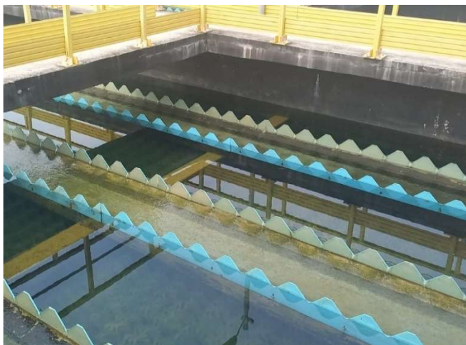
Foto 12 – 3 (três) Tanques de Decantação da ETA
