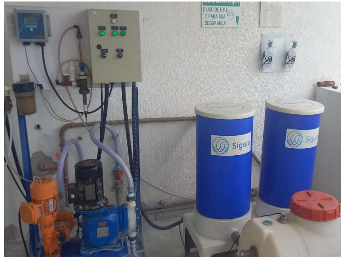
Foto 31 – Bomba Dosadora de Hipoclorito de Cálcio
