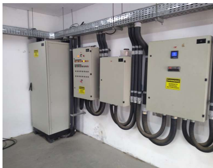
Foto 18 – Painéis de Comando de Válvulas
