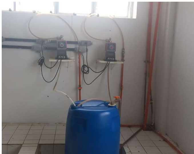
Foto 08 – Reservatório de Sulfato de Alumínio com as Bombas dosadoras
