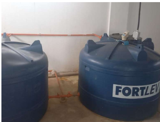
Foto 09 – Reservatório de Sulfato de Alumínio
