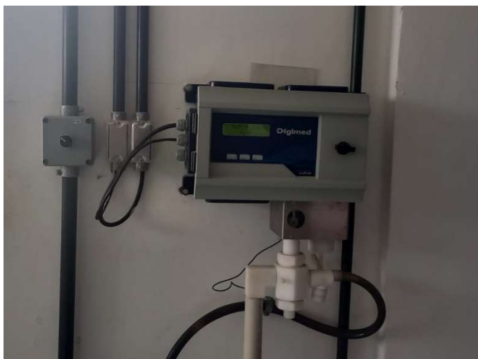
Foto 06 – Medidor de Vazão Ultrassônico
