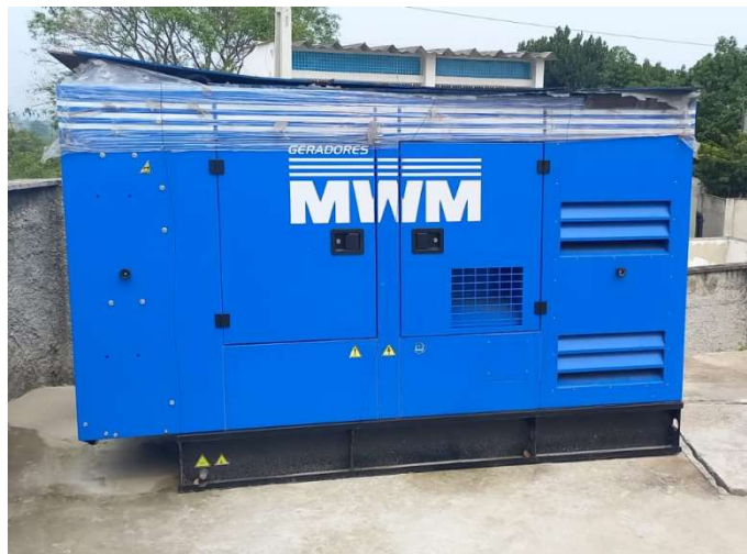
Foto 32 – Geradores da ETA (Não Instalado)
