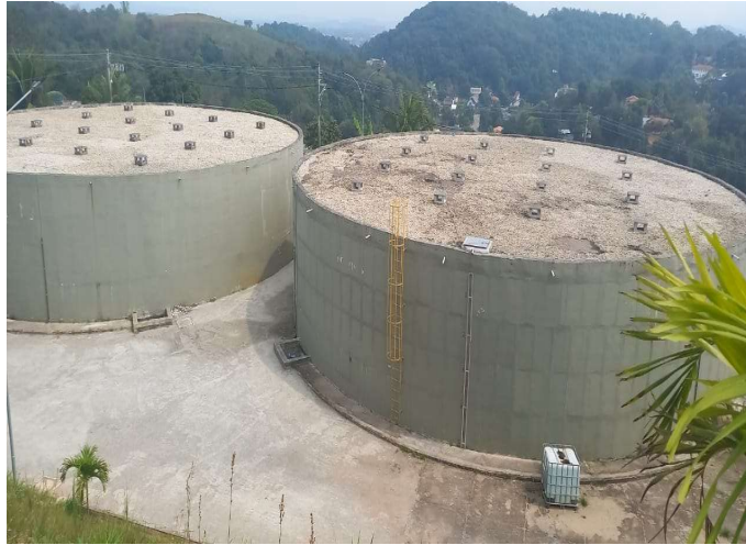
Foto 19 – Reservatórios de Água Tratada 5 Milhões de Litros D'Água
