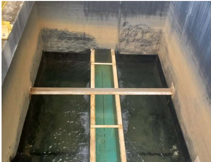
Foto 14 – 6 (seis) Tanques de filtros
