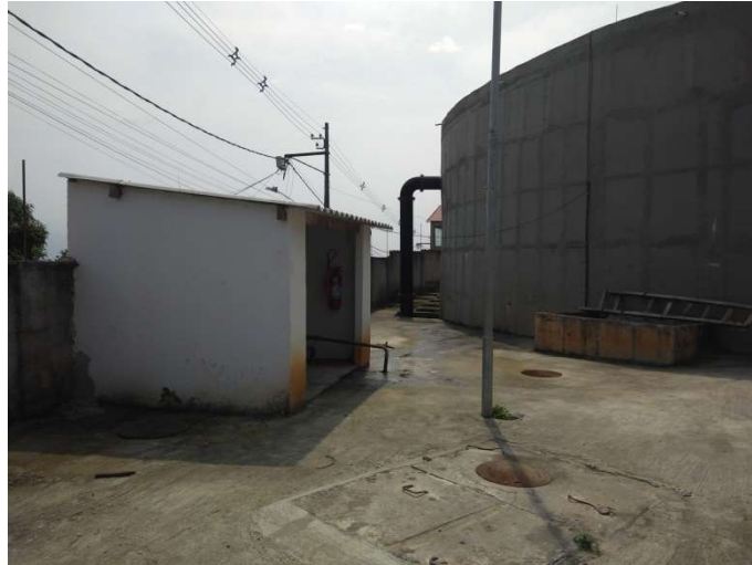
Foto 34 – Elevatória que Atende a Circunvizinhança
