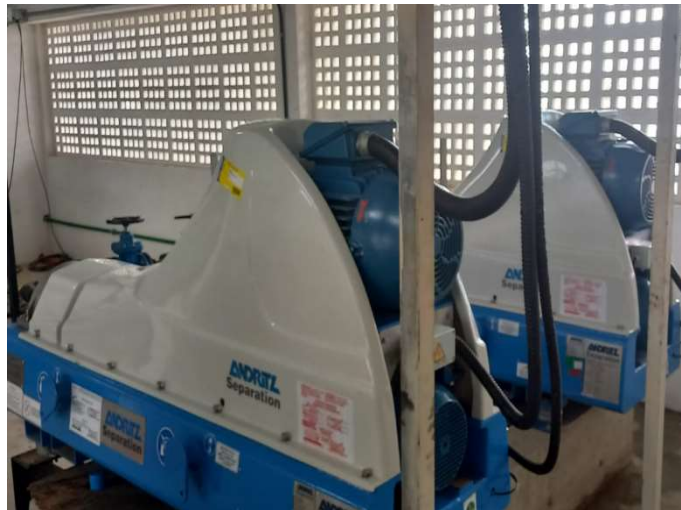
Foto 23 – Centrífugas para Desidratação do Lodo
