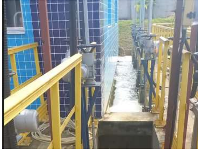
Foto 10 – Canal de Água Floculada
