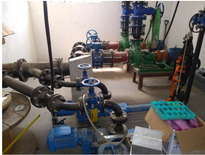
Foto 22 – 2 Bombas de Lodo Alimenta as Centrífugas e 2 Bombas de Recirculação da Água
