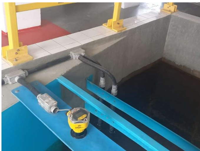
Foto 05 – Medidor de Vazão Ultrassônico (Calha Parshall)
