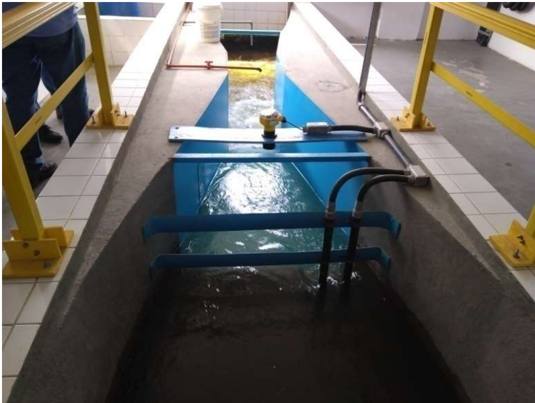
Entrada da Água Bruta na ETA (Calha Parshall)
