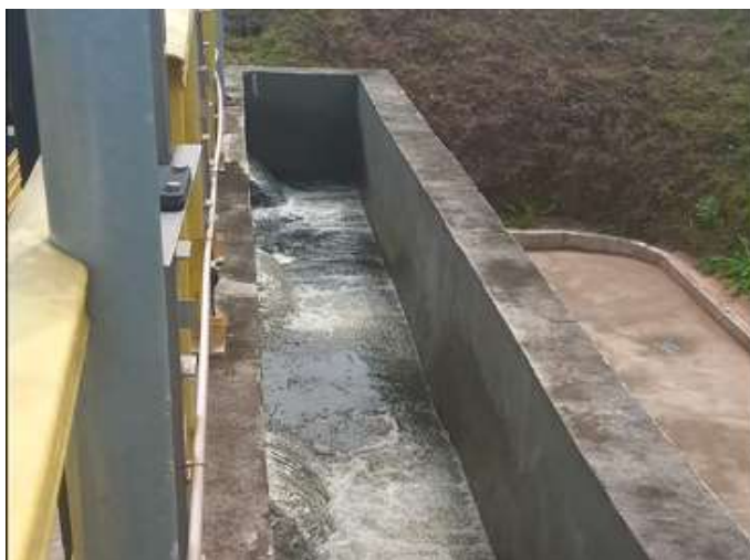
Foto 15 – Canal de Água Tratada (Saída dos Filtros)
