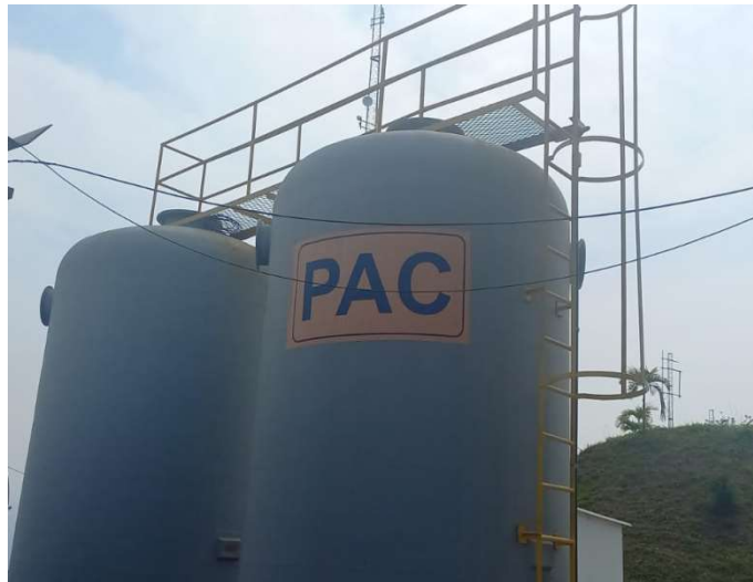
Foto 20 – Reservatórios de Sulfato de Alumínio 20 m 3 Cada
