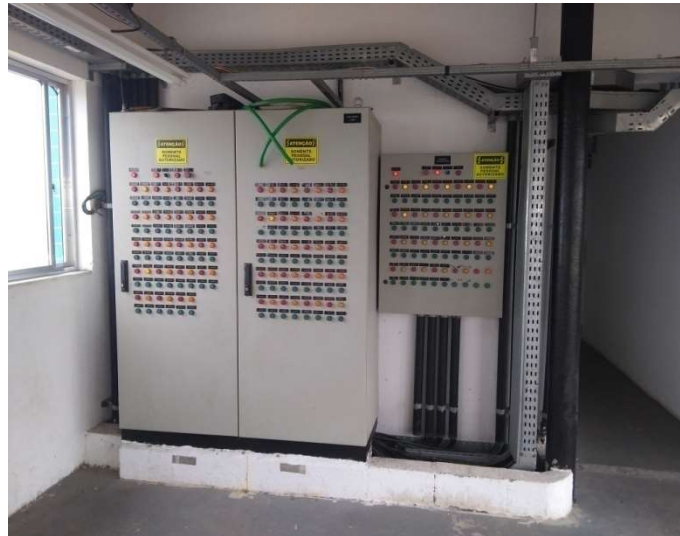
Foto 16 – Painéis de Comando das Comportas Decantadores e Filtros
