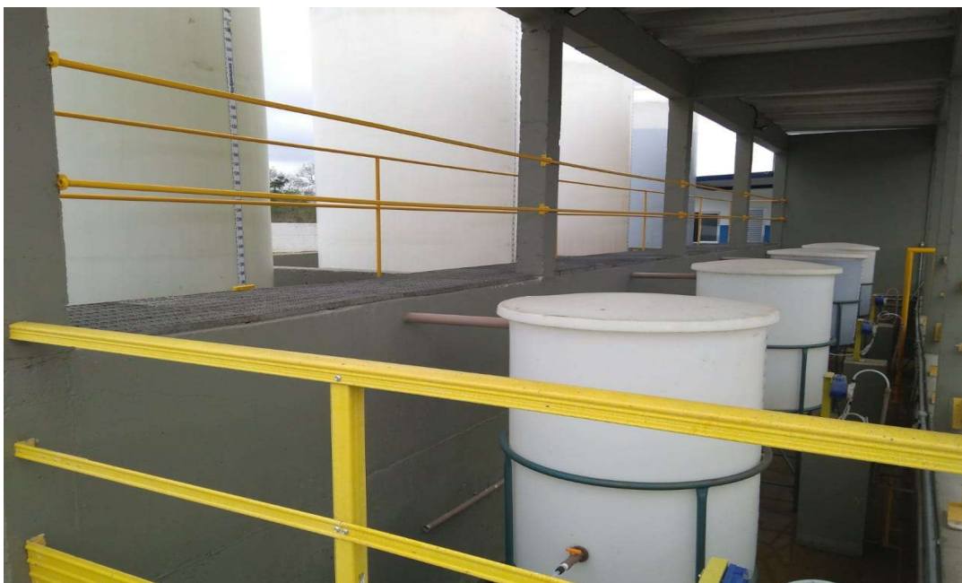
Fotografia 18 – Tanques de Reserva e Dosagem de Sulfato de Alumínio
