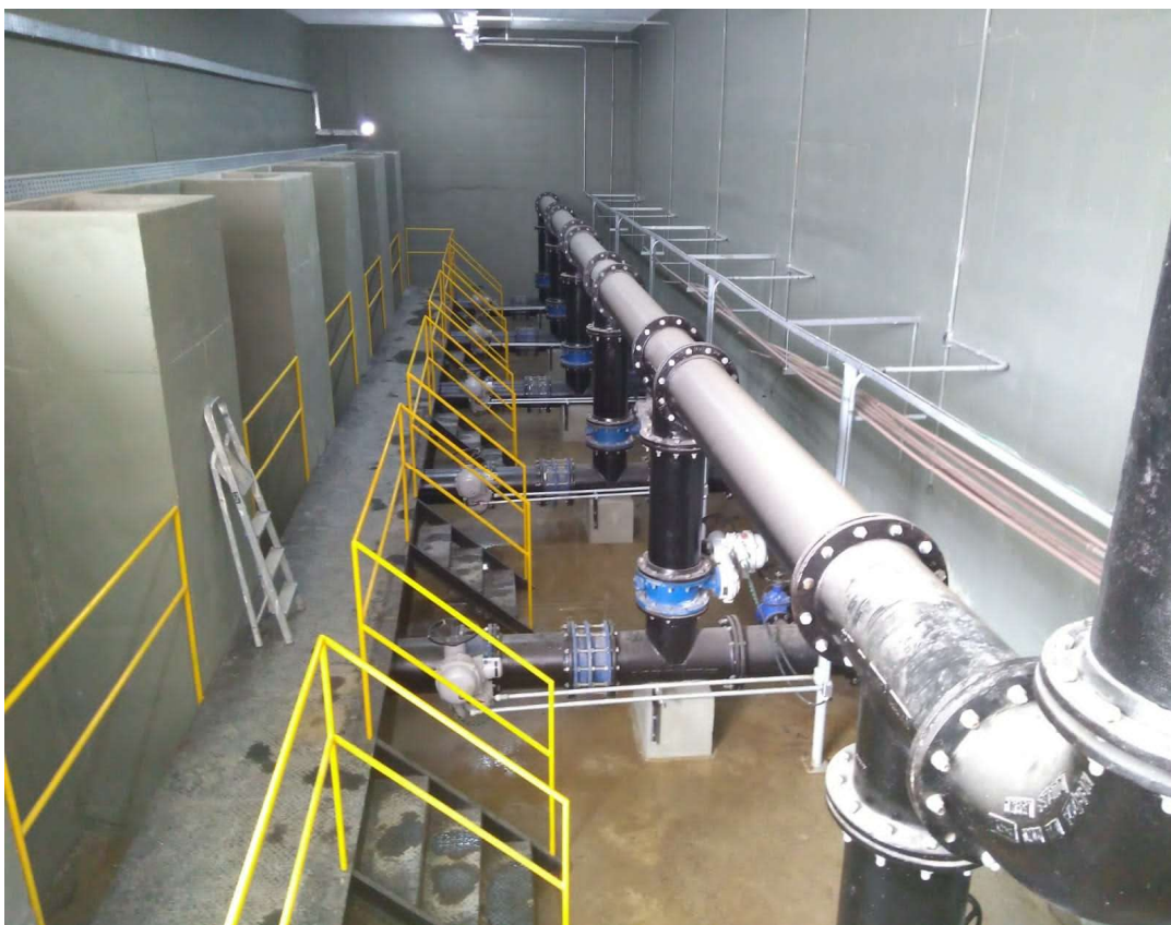
Fotografia 12 – Descargas dos filtros
