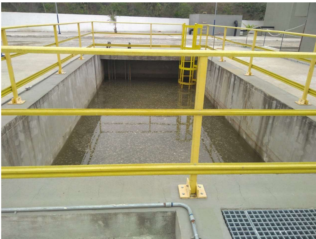
Fotografia 15 – Tanque de chegada da água residual de tratamento
