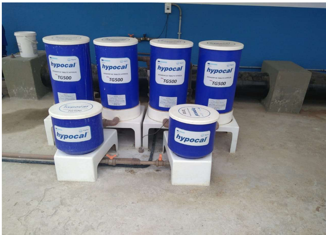
Fotografia 20 – Sistema de dosagem de cl
