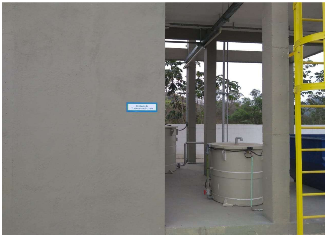
Fotografia 13 – Descargas dos filtros
