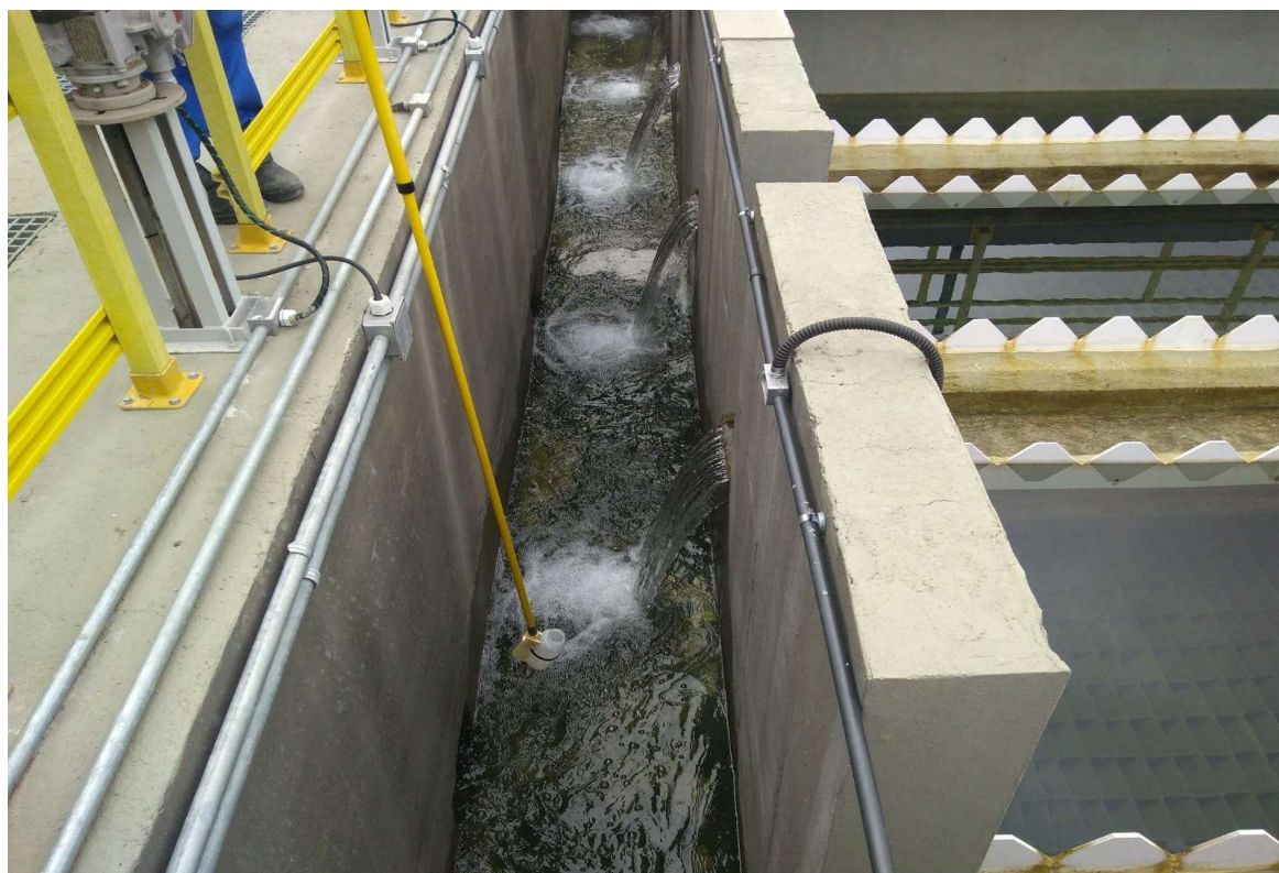
Fotografia 8 – Calha de água decantada
