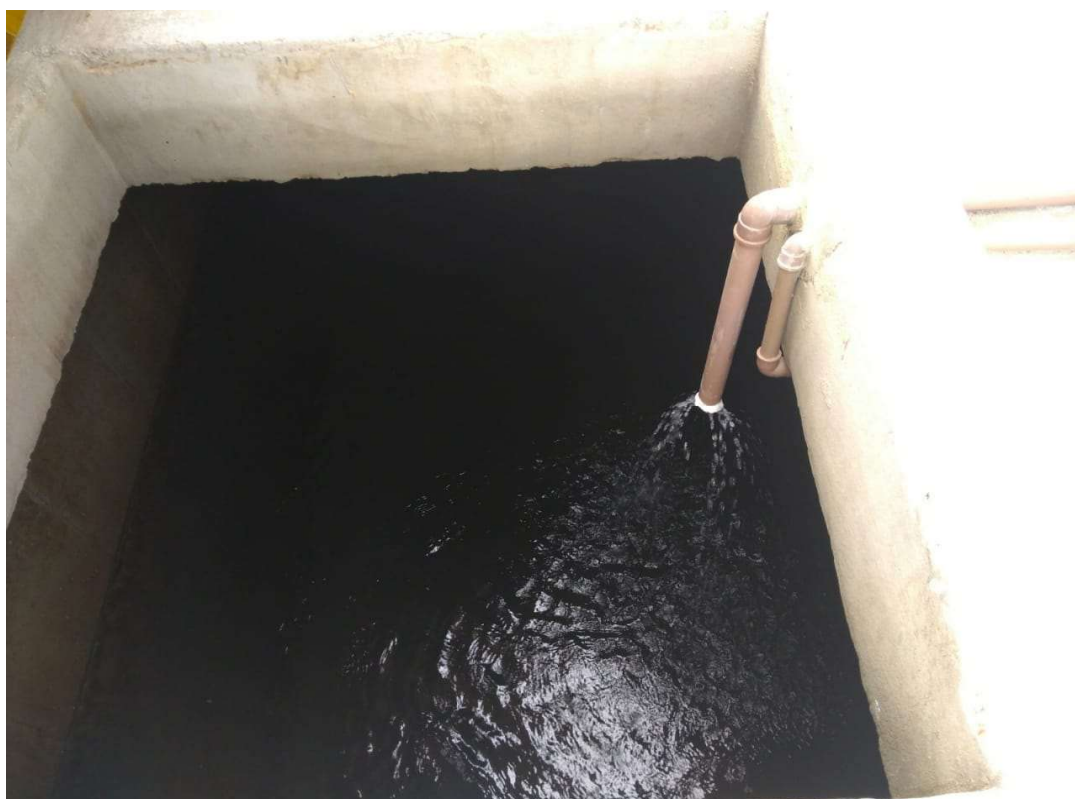
Fotografia 21 – Reservatório de contato – 200 m 3
