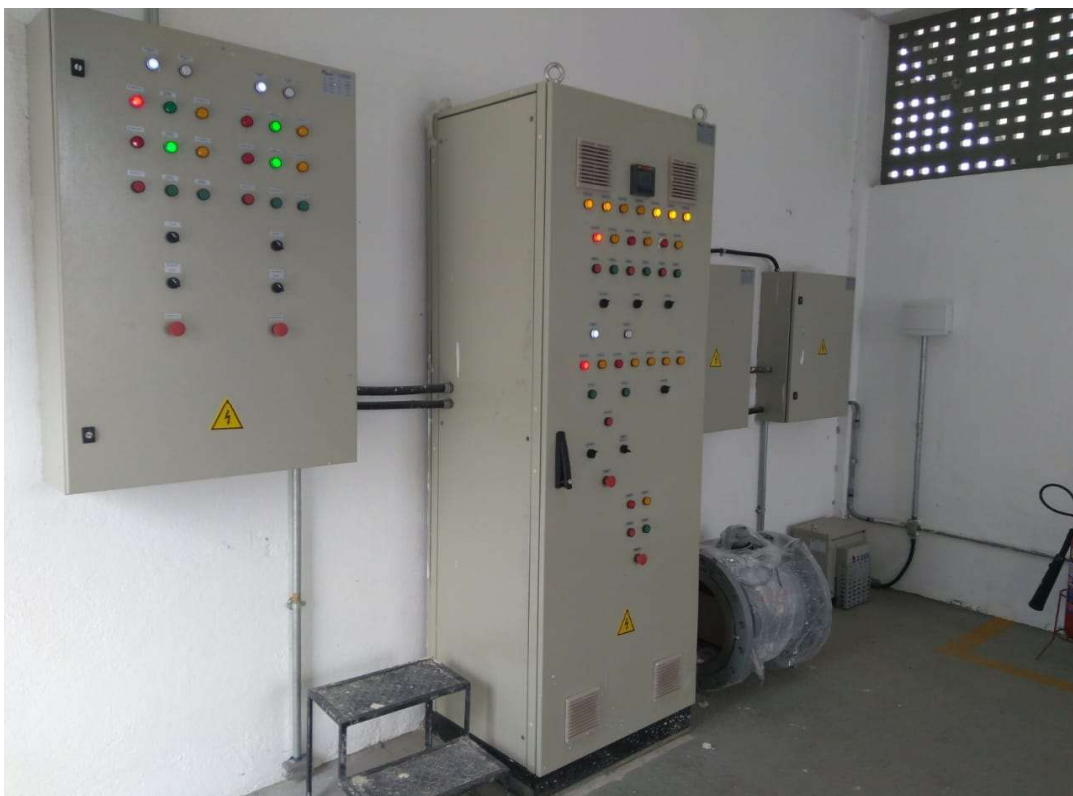
Fotografia 22 – Painel Elétrico de Comando das Bombas
