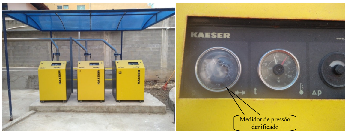
Foto 11 – Sopradores de ar para o Tanque RANOX da ETE, abrigados sobre base em concreto e enclausurados com abafadores de ruído; Medidor de pressão danificado (foto direita)
