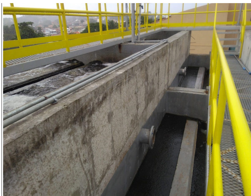
Foto 9 – Decantador secundário-terciário tipo lamelar (parte central no tanque RANOX): entrada ascendente do efluente do Tanque de Aeração no fundo já com o PAC
