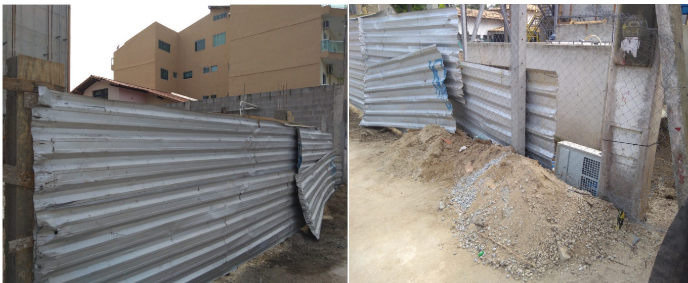
Foto 1 – ETE Itaúna, construção da entrada em andamento (tapumes e resíduos da obra)
