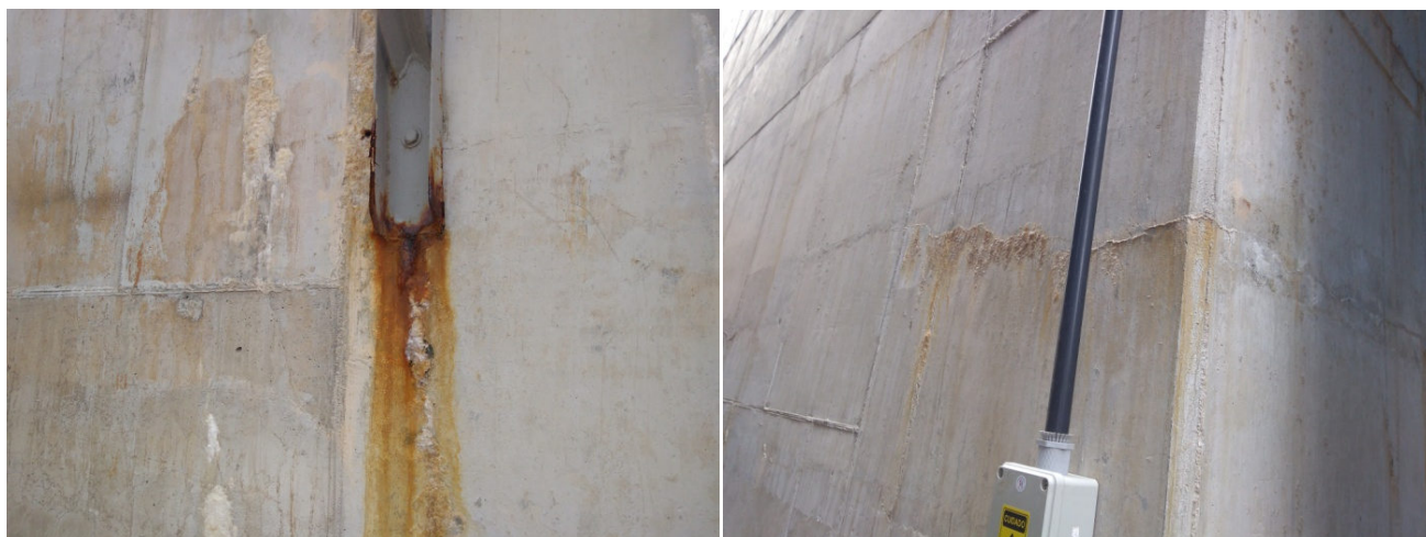
Foto 10 – Ferrugem na base da cantoneira em frente ao reator (esquerda), infiltração na parede do fundo do reator (direita)
