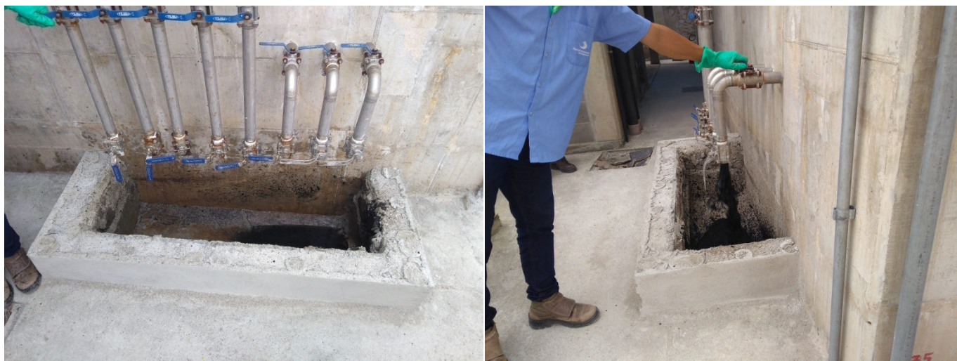
Foto 12 – Registros de manobra de saída do lodo do reator
