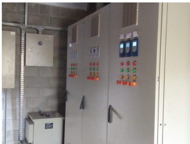
Foto 13 – Sala dos painéis de comando elétrico dos motores da ETE Itaúna
