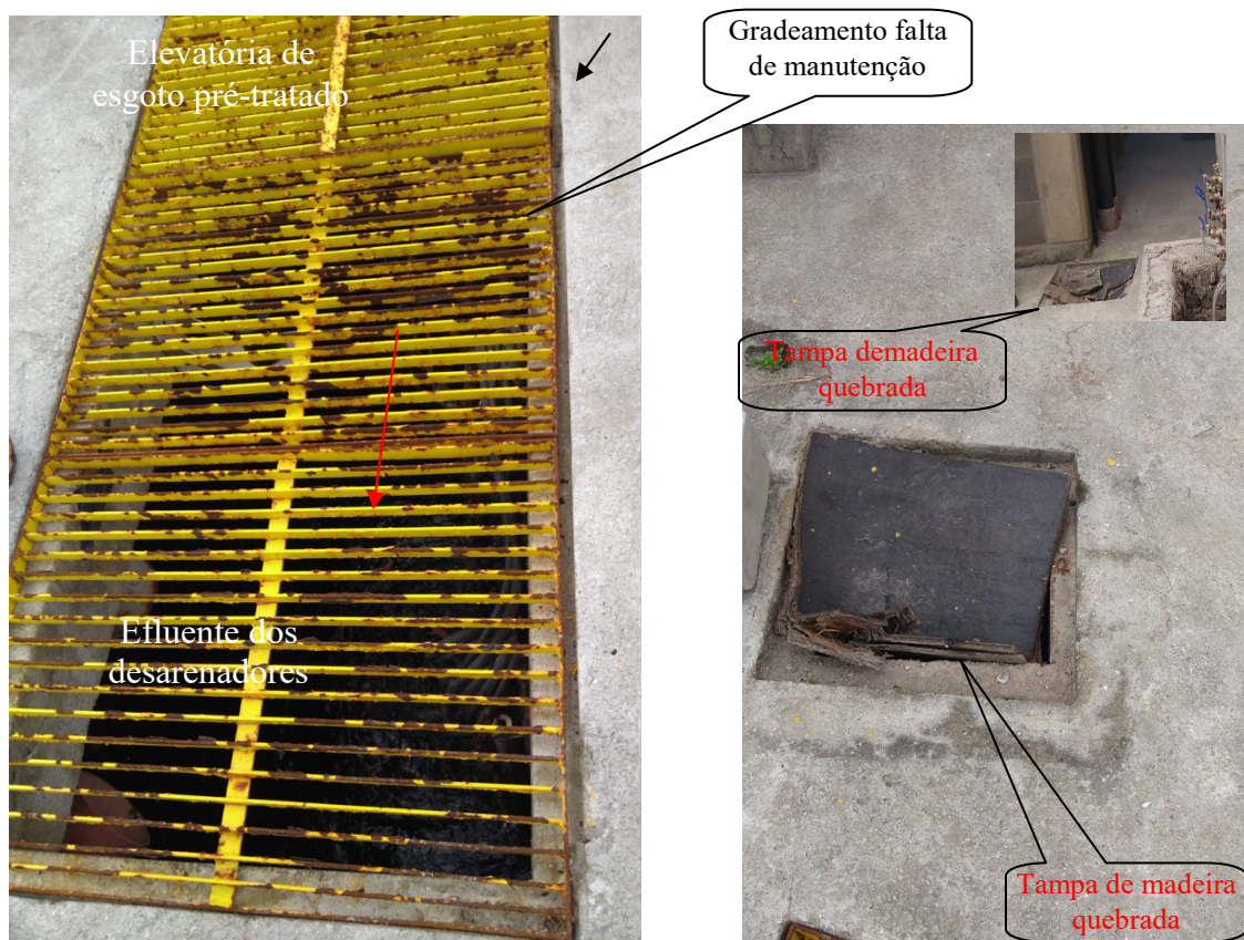
Foto 6 – Esquerda: Grade do tanque do efluente dos desarenadores ( enferrujada ). Direita: tampas de madeira quebradas
