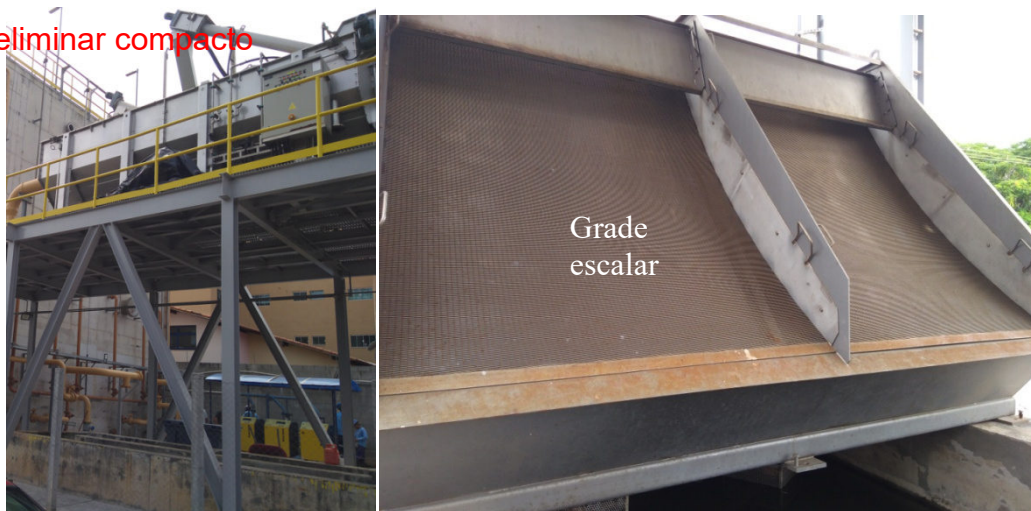
Foto 3 – Entrada dos recalques de esgoto bruto no tratamento preliminar da ETE: equipamento (fora de carga) de entrada no sistema de tratamento preliminar compacto (gradeamento, caixa de areia e remoção de óleo e graxas) e no gradeamento tipo peneira estática escalar com abertura em malha fina;
