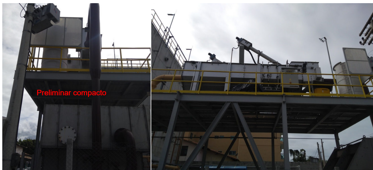
Foto 5 – Equipamento de tratamento preliminar integrado e compacto ( fora de carga )
