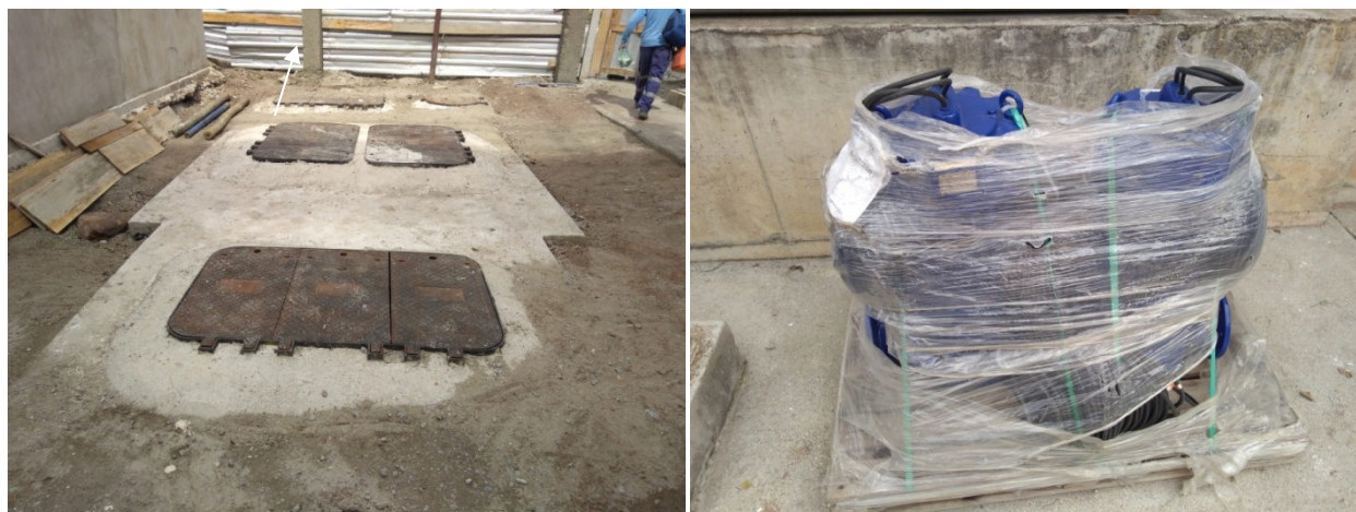
Foto 15 – Caixa receptora de esgoto bruto que chega na estação Itaúna (foto esquerda), bombas submersíveis aguardando para ser instaladas na caixa receptora de esgoto bruto (foto direita).
