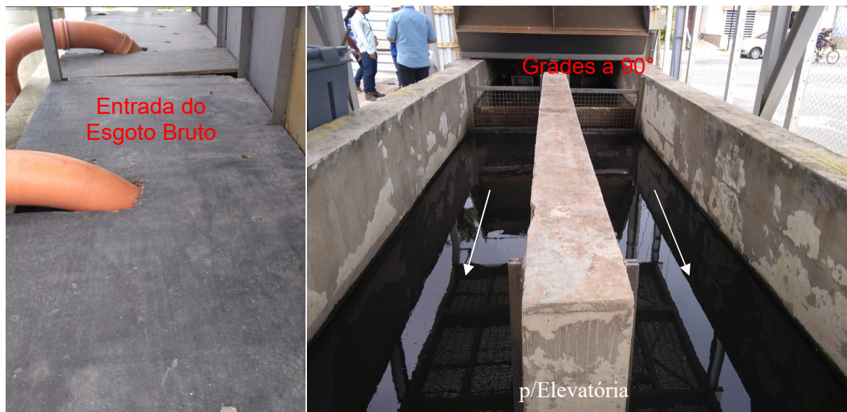
Foto 4 – Esquerda: entrada do esgoto bruto. Direita: tratamento preliminar, desarenadores de limpeza manual (semanalmente). Dois canais em carga sem medidor de vazão de entrada
