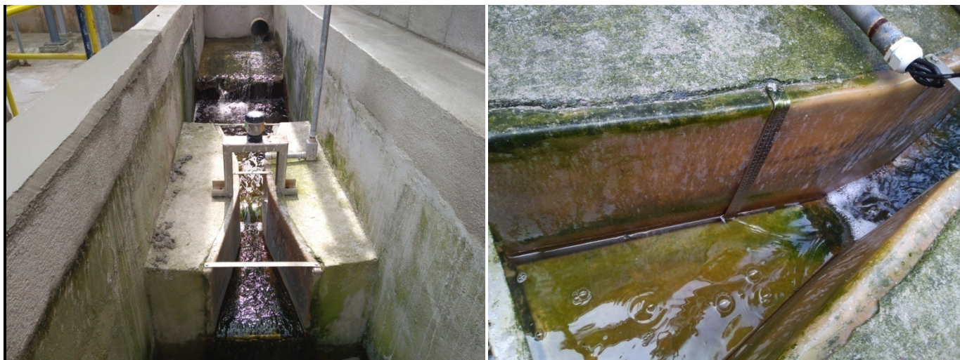
Foto 14 – Caixa de saída do efluente tratado (alongado para inibição de turbulência e geração de espumas); foi instalado o medidor de vazão ultrassônico na Calha Parshall e régua com escala de vazão visível.
