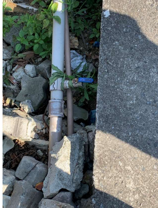
Registro aberto sem a presença de água
