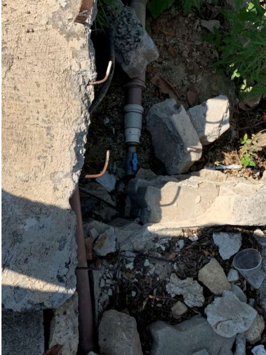
Registro aberto sem a presença de água
