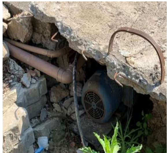
Bomba instalada pelos moradores
