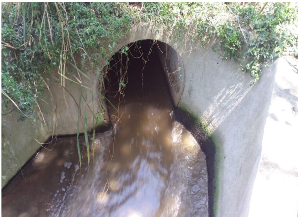
Foto 24 – Saída do esgoto tratado
