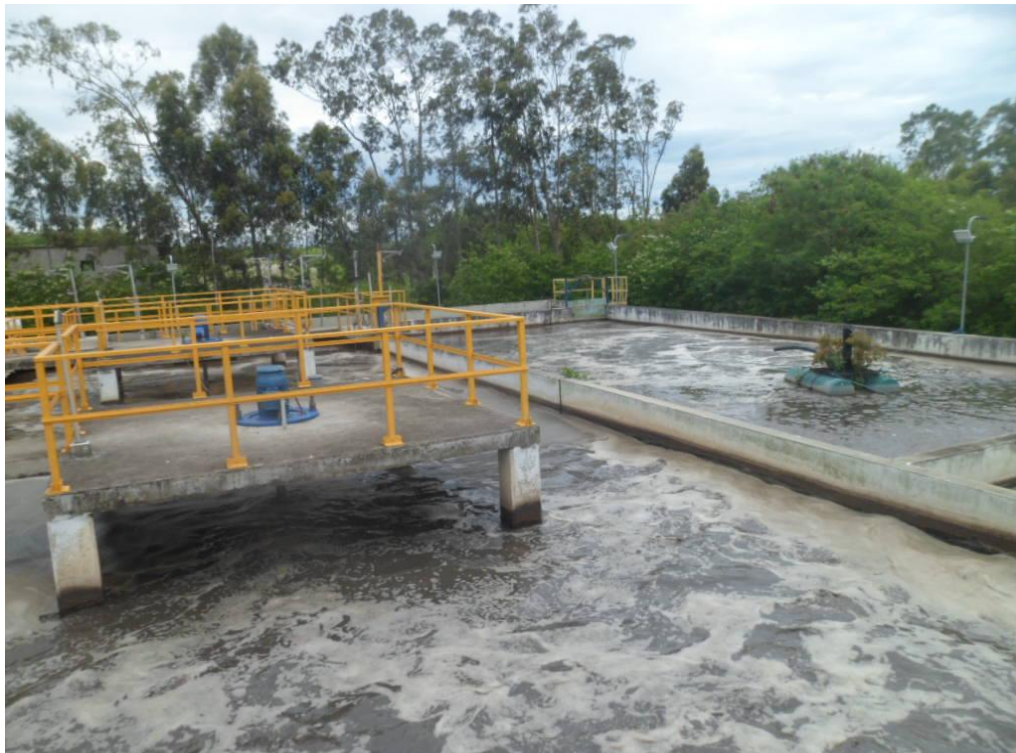
Foto 13 –Tanque de Aeração com 04 Motores
