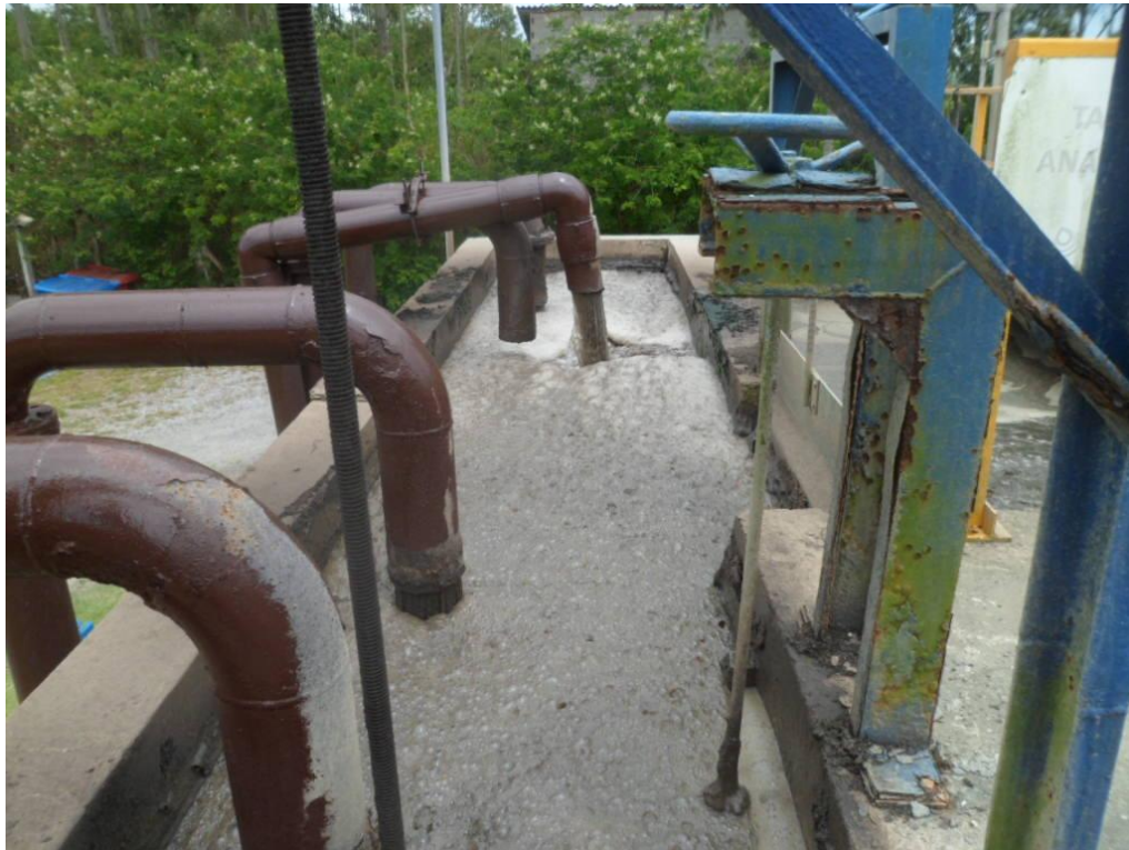
Foto 12 – Entrada do Esgoto Bruto e Recirculado
