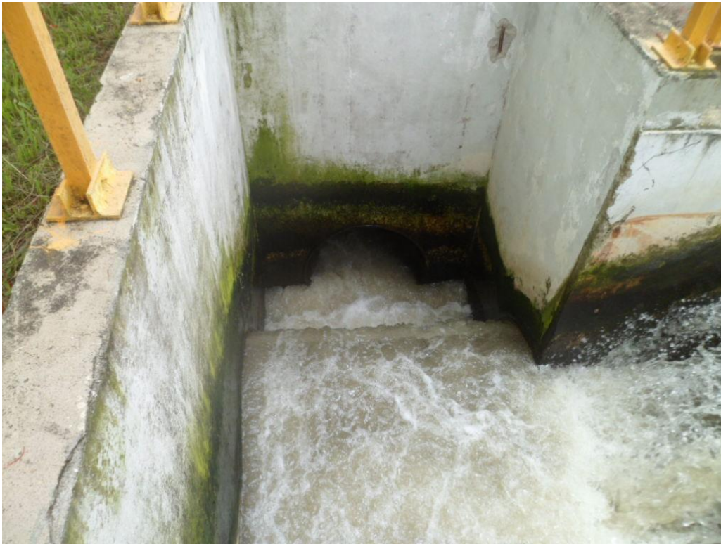
Foto 22 – Saída do esgoto tratado
