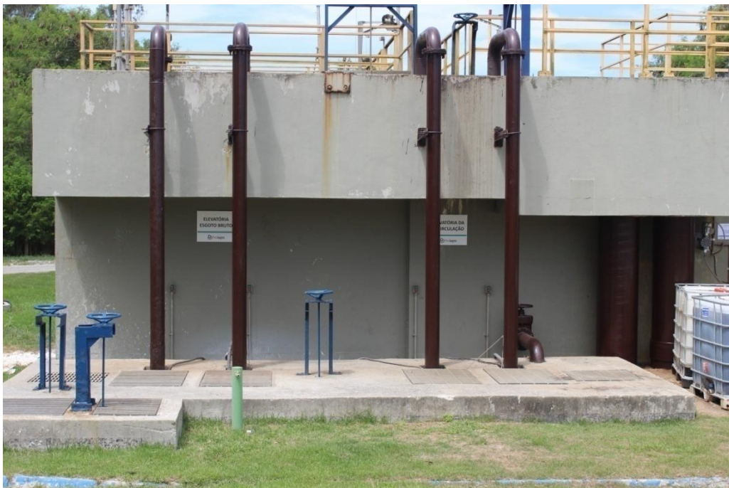
Foto 11 – Elevatória de Esgoto Bruto e Recirculado
