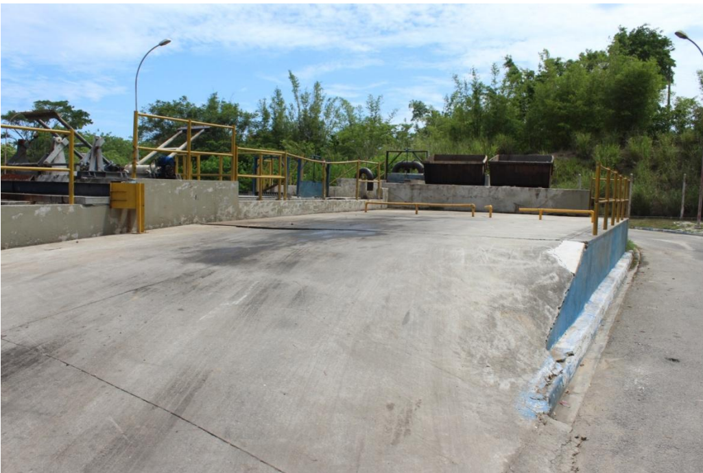
Foto 07 – Rampa de Subida de Caminhão Limpa Fossa nas Caçambas
