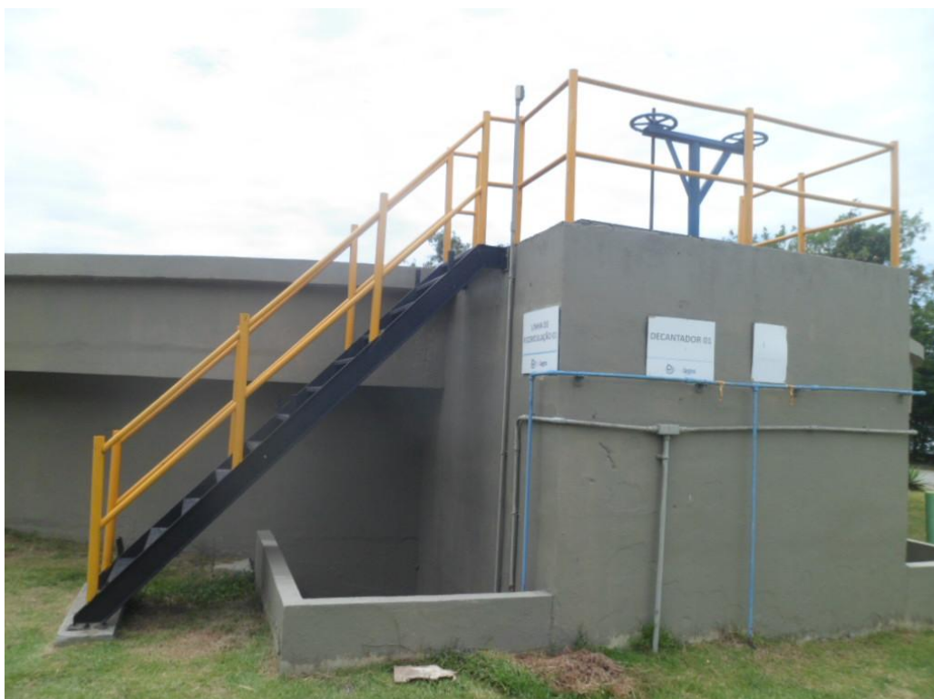
Foto 14 – Decantador (vista lateral)
