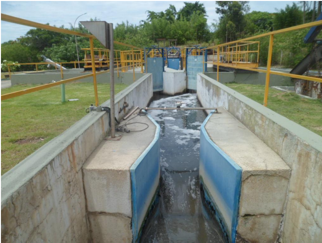
Foto 10 – Calha Parshall com Medidor de Vazão Ultrassônico
