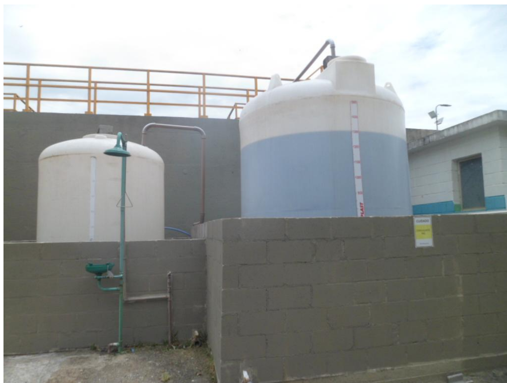
Foto 19 – Reservatórios de PAC Policloreto de Alumínio 6.000 e 18.000 Litros
