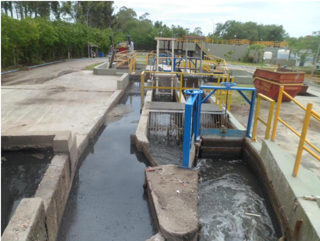
Foto 04 – Passagem do Esgoto Bruto no Gradeamento
