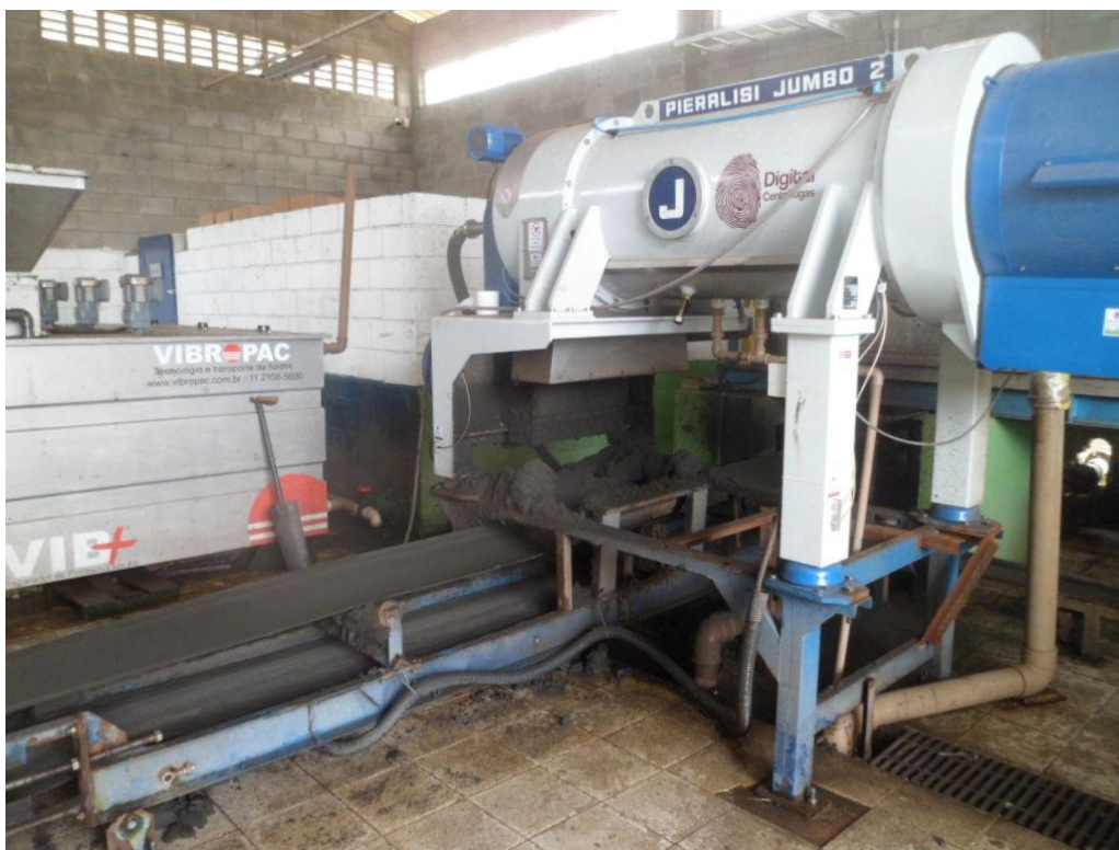
Foto 16 – Centrífuga para Desidratação do Lodo
