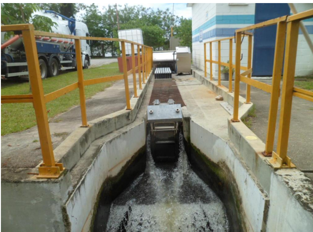
Foto 21 – Desinfecção com Ultravioleta
