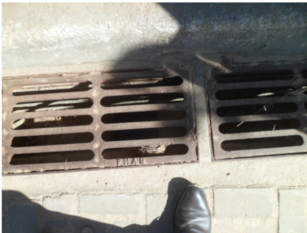
Foto 05 – Ralos de águas pluviais
