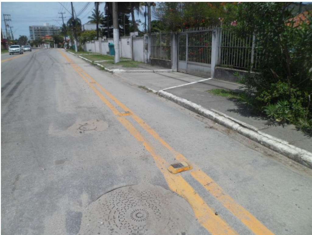
Foto 15 – Elevatória Avenida Saquarema
