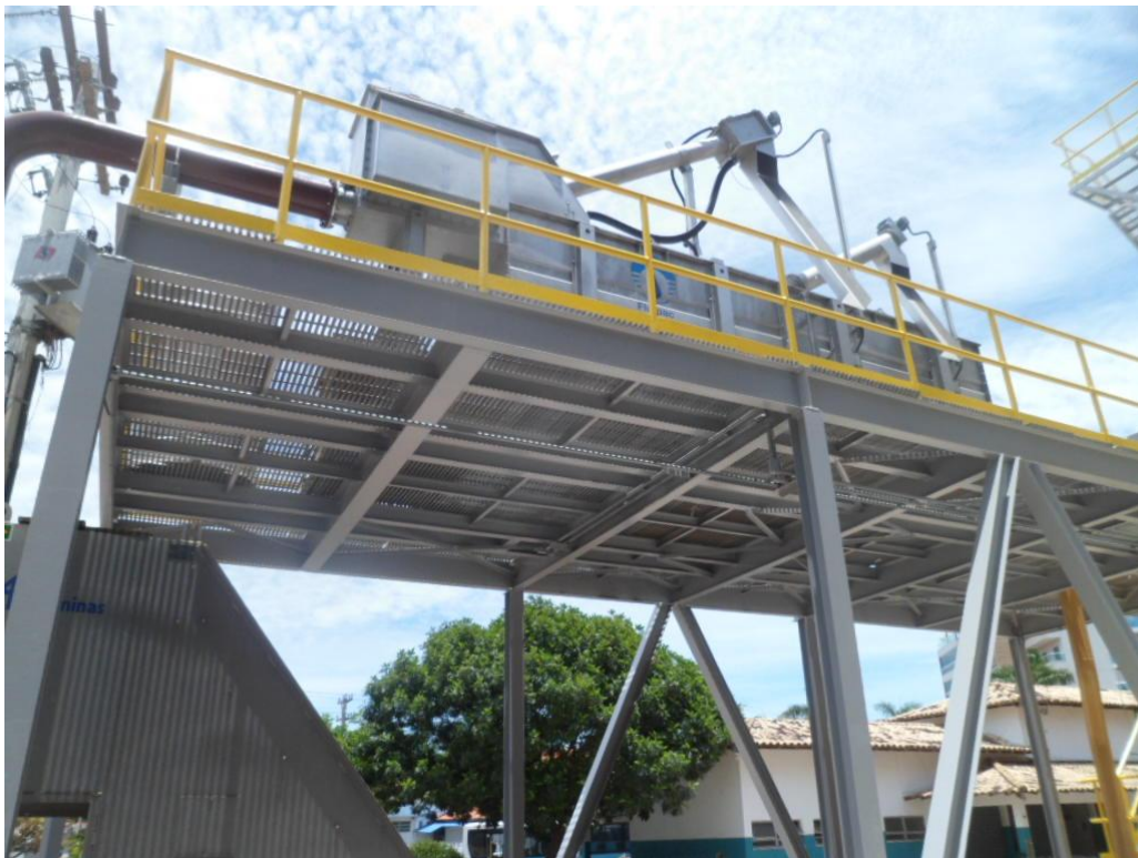
Foto 13 – Sistema de Tratamento Preliminar Compacto Portátil
