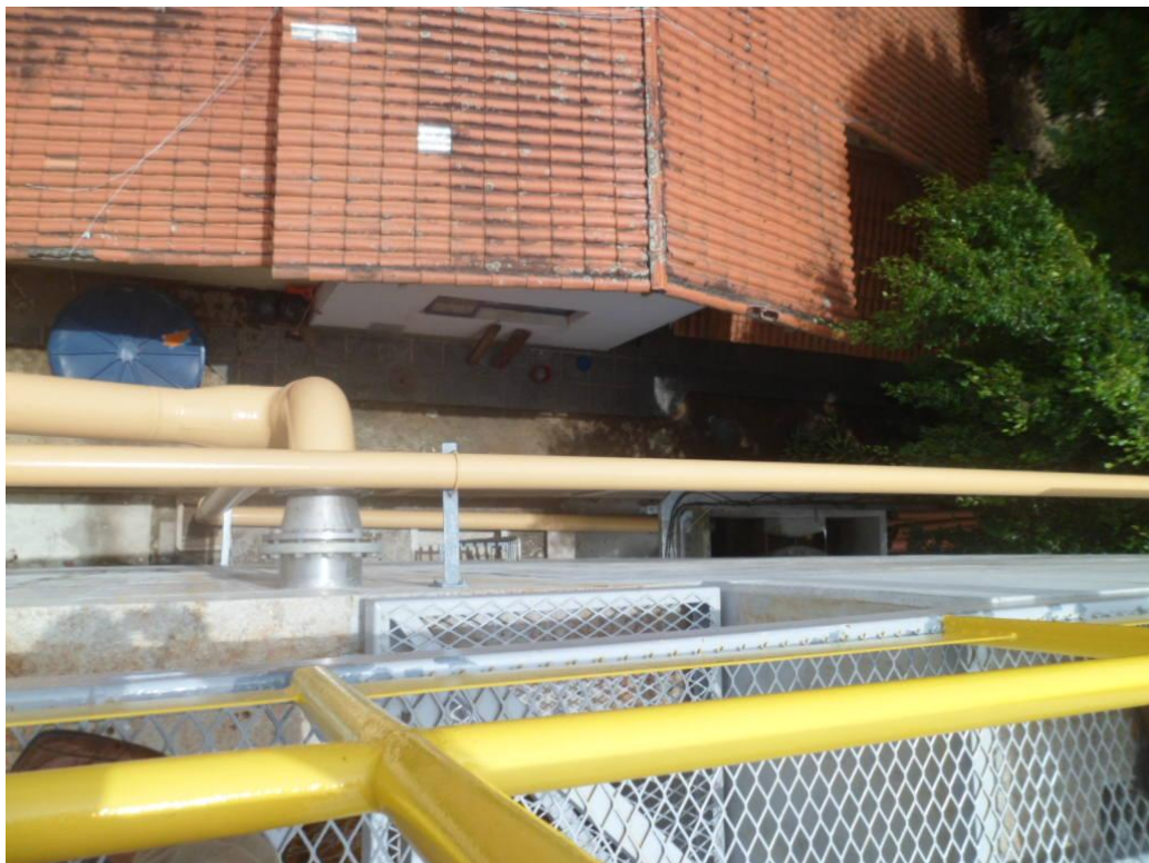
Foto 11 – Tubulações de Descida do Esgoto Tratado
