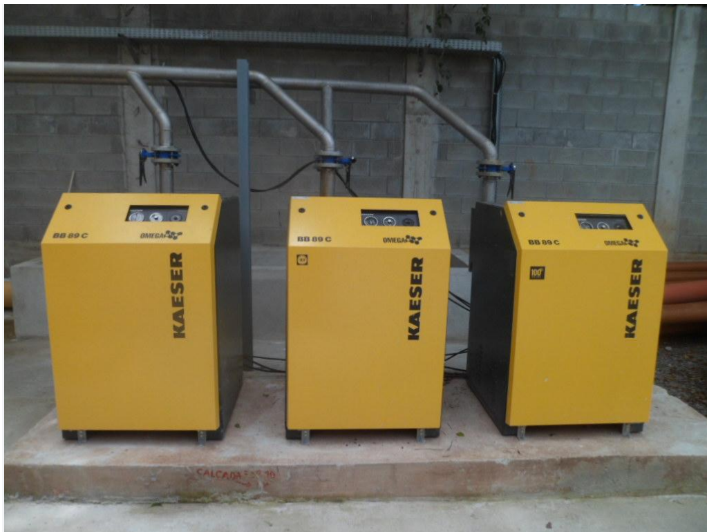
Foto 07 – Sopradores que Lançam Carga de Ar para os Aeradores
