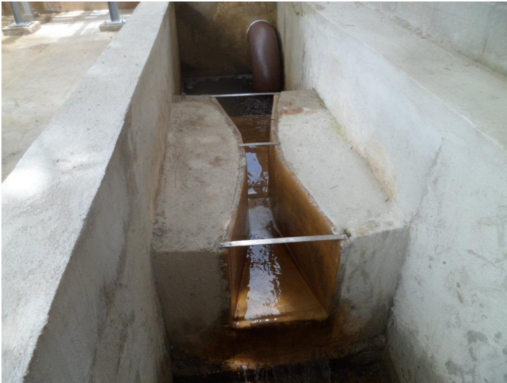
Foto 12 – Calha Parshall – Saída do Esgoto Tratado
