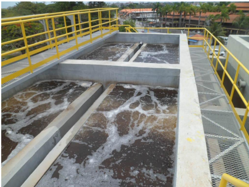
Foto 09 – Tanque de Aeração 2
