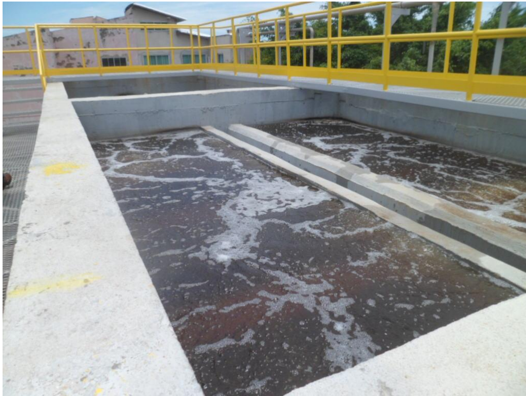
Foto 08 – Tanque de Aeração 1
