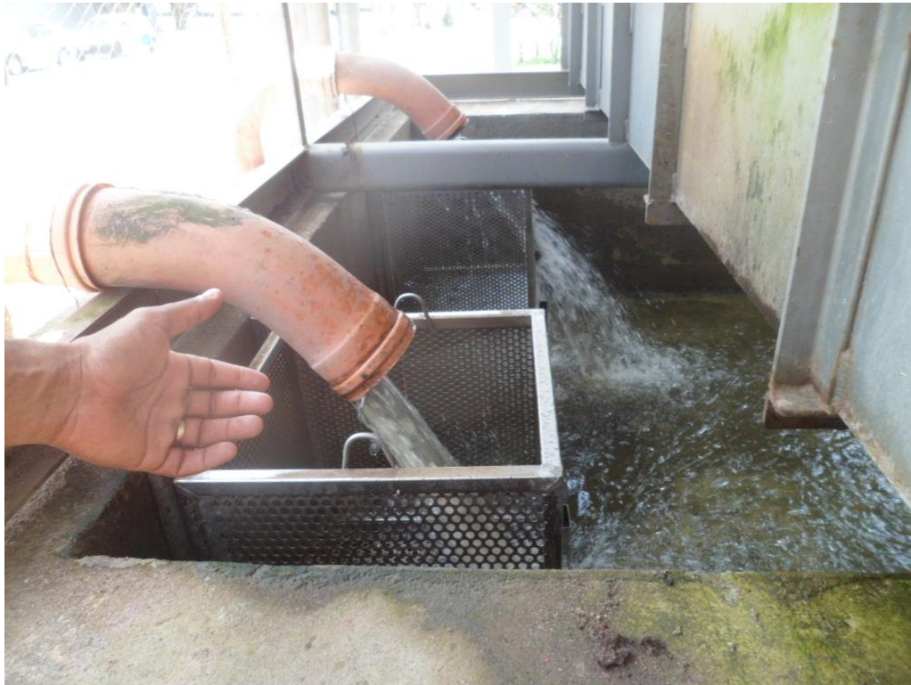
Foto 03 – Entrada do Esgoto In Natura nas Caixas Gradeadas
