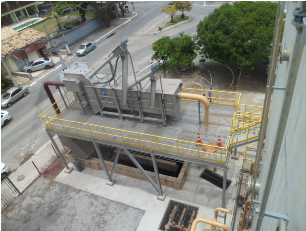
Foto 14 – Sistema de Tratamento Preliminar Compacto Portátil
