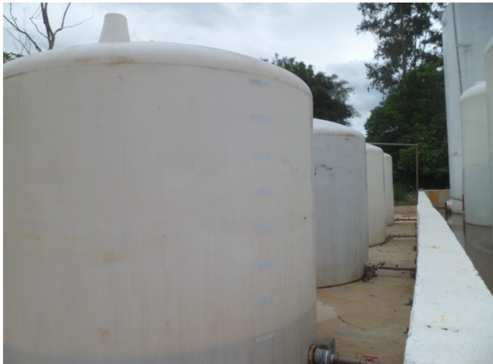
Foto 19 – 04 (quatro) Tanques de Armazenamento e Reaproveitamento de Água da Chuva
