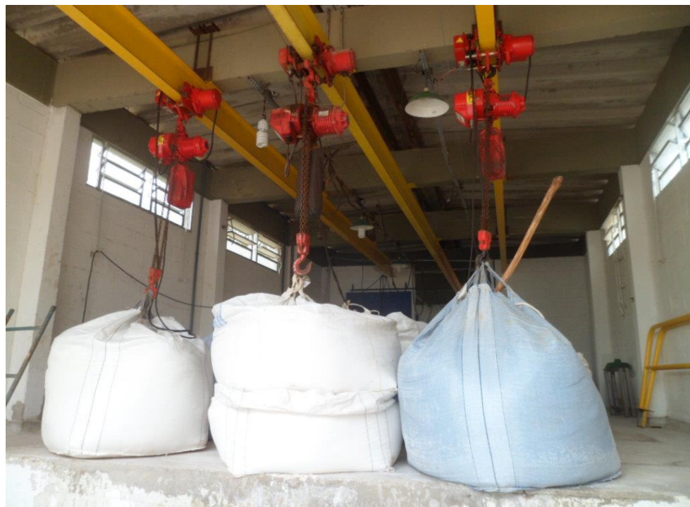
Foto 25 – Trilhos, Monovias e Talhas Elétricas
