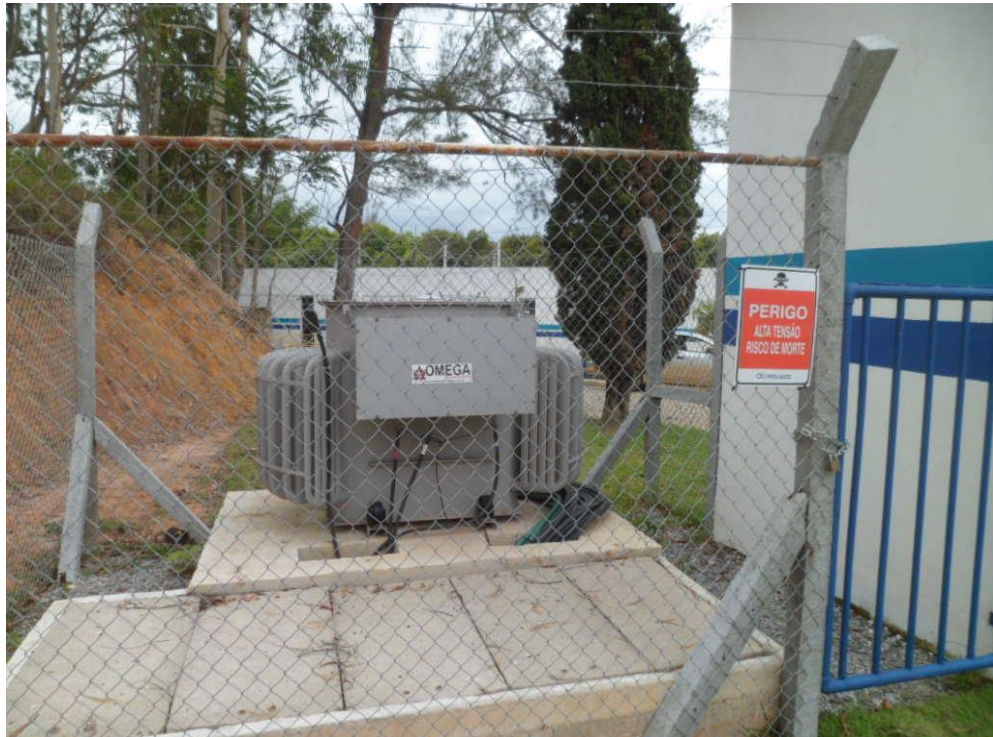
Foto 16 – Transformador da Casa de Química
