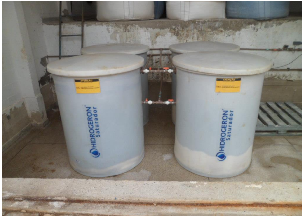
Foto 20 – 04 (quatro) Tanques Saturadores
