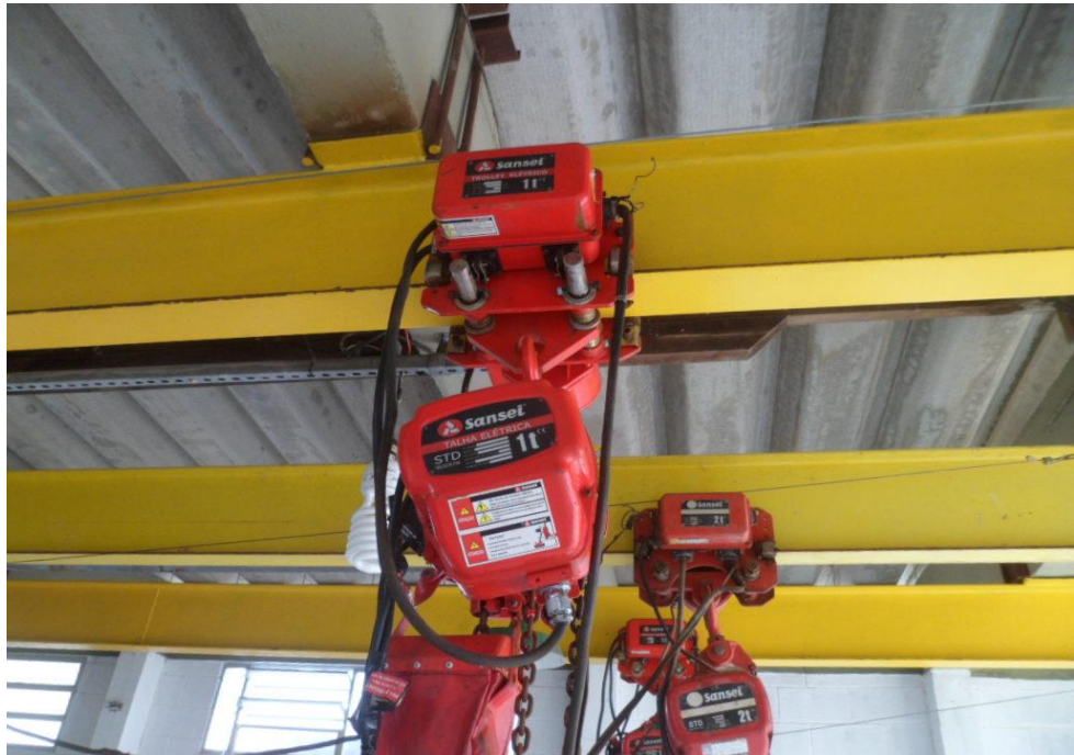
Foto 24 – 02 Monovias Equipadas com Talhas e Trolleys de Acionamento Elétrico
