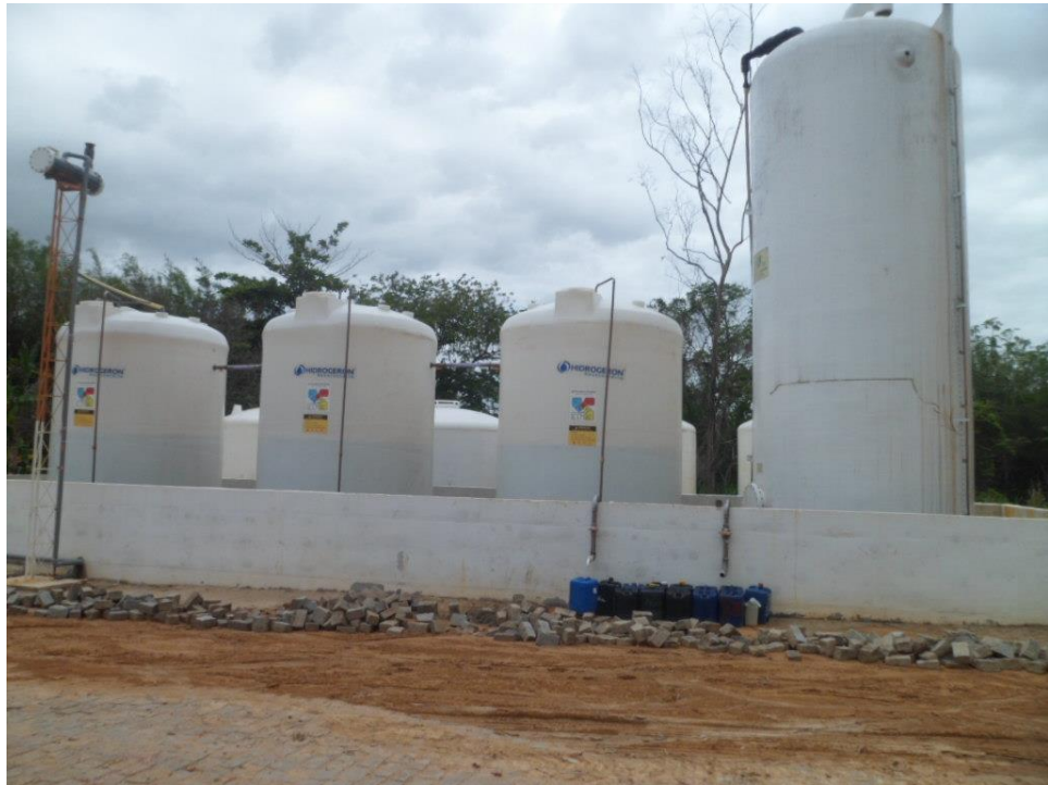
Foto 18 – 03 (três) reservatórios PE 23.000 L – Capacidade para 2.800 l/h
