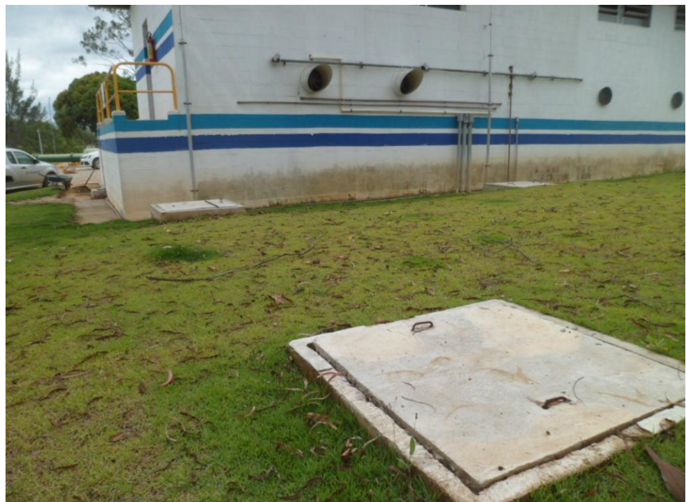
Foto 17 – Caixas de Passagens de Energia
