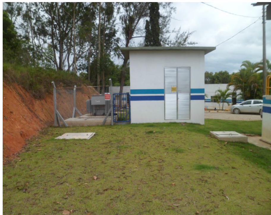
Foto 15– Casa de Energia
