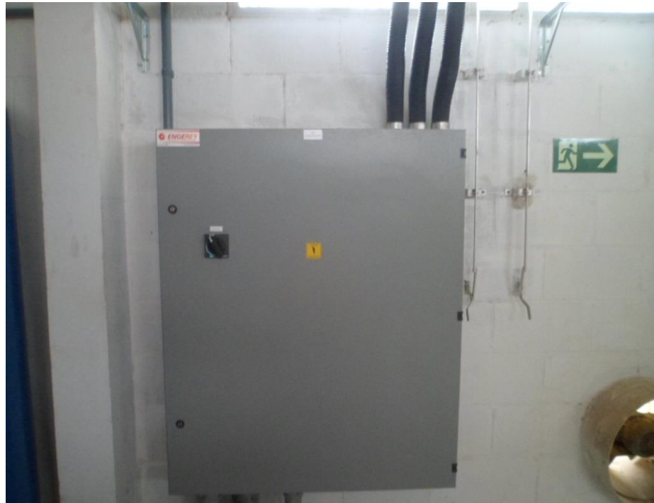
Foto 14 – Quadro de Energia
