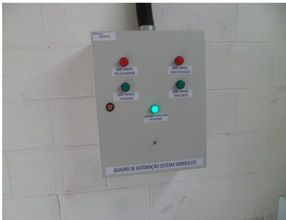
Foto 13 – Quadro de Automação Sistema Hidráulico
