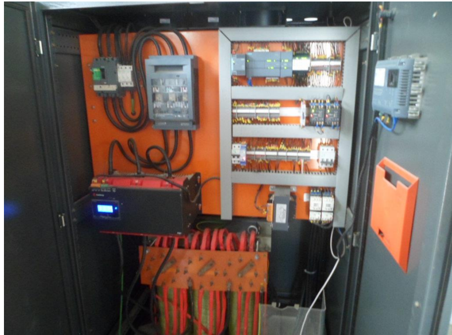
Foto 12 – Painel Interno do Gerador
