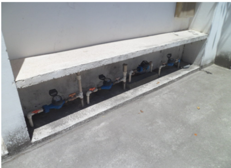
Foto 03 – Hidrômetros das casas 01, 02 e 03
