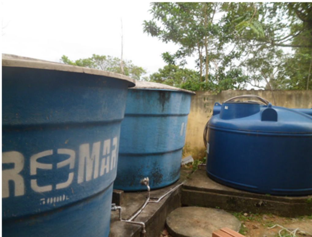
Foto 06– Reservatórios Inferiores da Residência do Reclamante 18.000 lts
