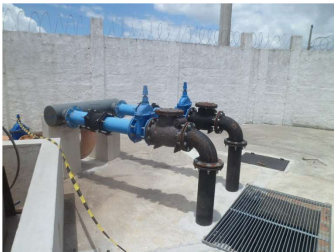
Foto 21 – Elevatória do Tanque de Efluente Despejado por Caminhão Vacoll
