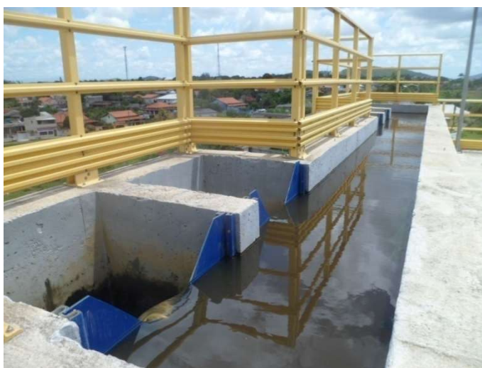
Foto 11 – Entrada do Esgoto Pré-tratado Para os Tanques de Aeração
