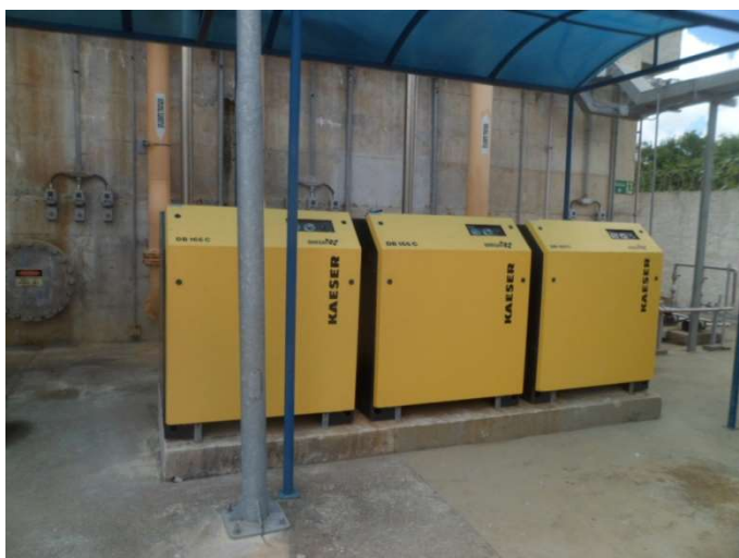
Foto 13 – Sopradores que Lançam Carga de Ar nos Aeradores
