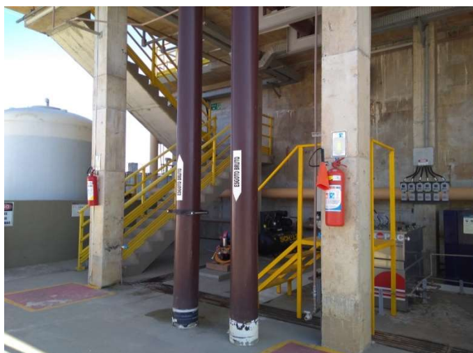
Foto 02 – Entrada do Esgoto Bruto In Natura das 03 (três) Elevatórias 108 l/s
