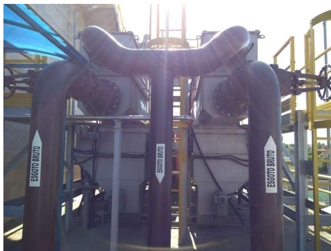
Foto 03 – Entrada do Esgoto Bruto nos PTRAT
