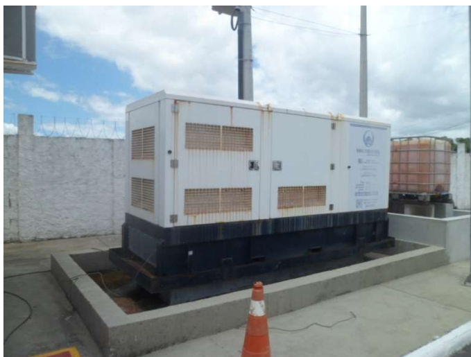
Foto 20 – Gerador e Reservatório de Diesel
