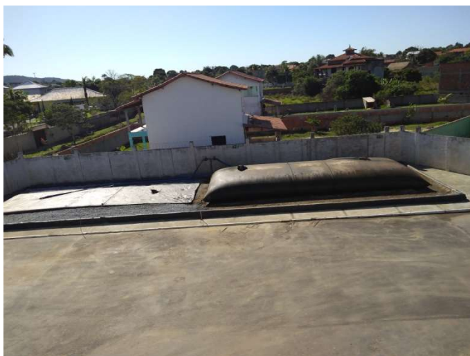
Foto 19 – Bags Armazenamento de Lodo
