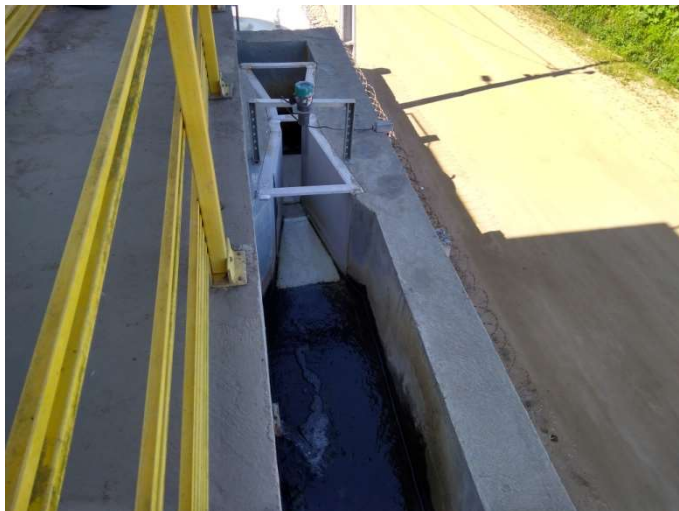
Foto 24 – Calha Parshall com Medidor de Vazão Ultrassônico, Saída do Decantador Secundário
