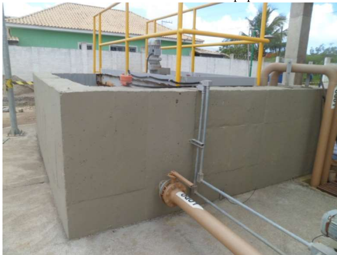
Foto 18 – Tanque de Lodo
