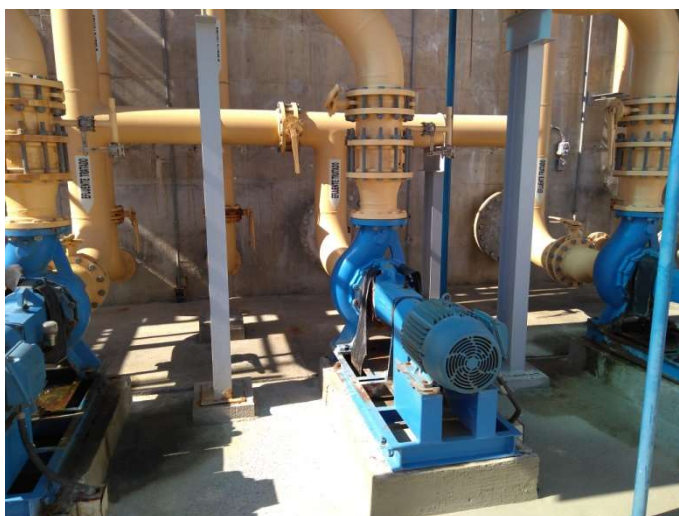
Foto 14 – Conjunto de Motobombas de Recirculação
