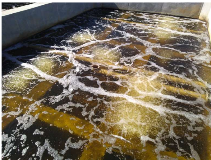
Foto 12 – Tanque de Aeração
