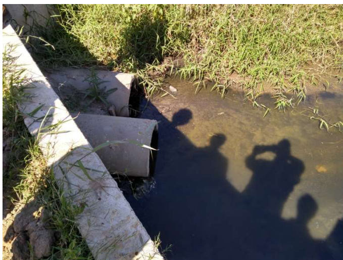
Foto 26 – Saída do Esgoto Tratado no Rio Salgado
