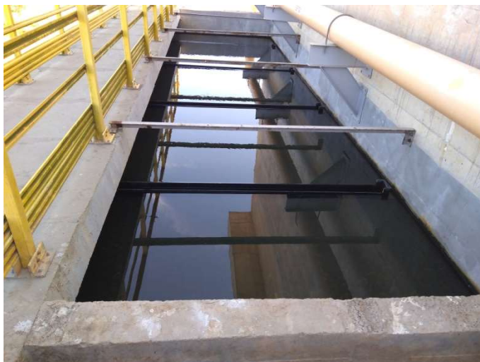
Foto 23 – Tanque de Decantação Secundário
