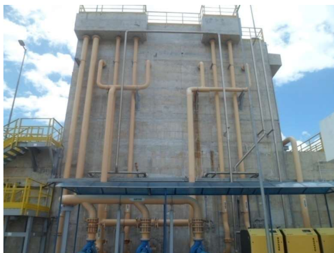
Foto 15 – Centrifuga de Desidratação do Lodo
