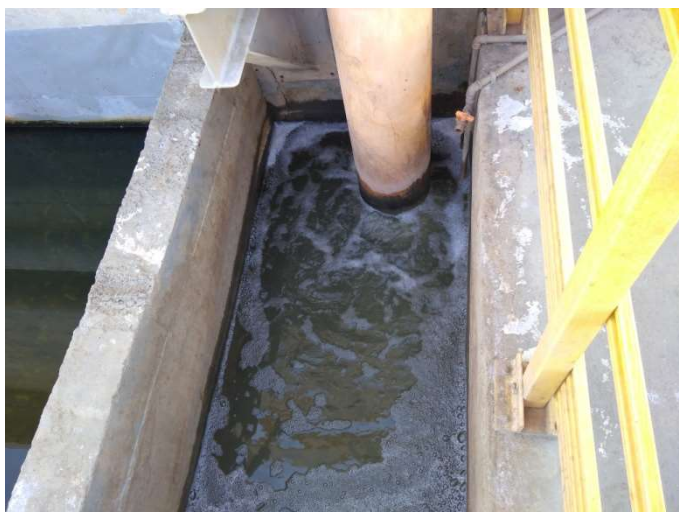
Foto 22 – Chegada do Esgoto Tratado no Decantador Secundário
