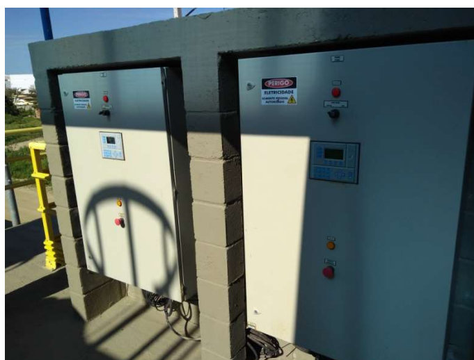
Foto 05 – Quadro de Comando dos PTRAT
